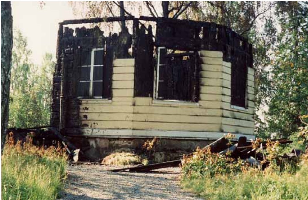
KUVA 88. Vuoden 1988 juhannuksena toinen puiston vanhimmista paviljongeista, umpiseinäinen, valeikkunallinen ns. Kuvernöörin paviljonki paloi ja se jouduttiin purkamaan. (Kuva: TTA).
