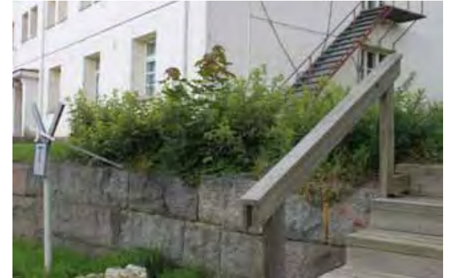
Vankilan asuinrakennuksen pihan graniittinen tukimuuri tulee pitää kunnossa ja puhtaana puiden vesoista.
