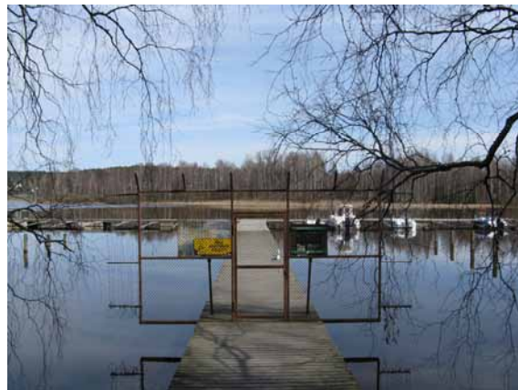
Laituriportti kaipaa uusimista. (Kuva RG)
