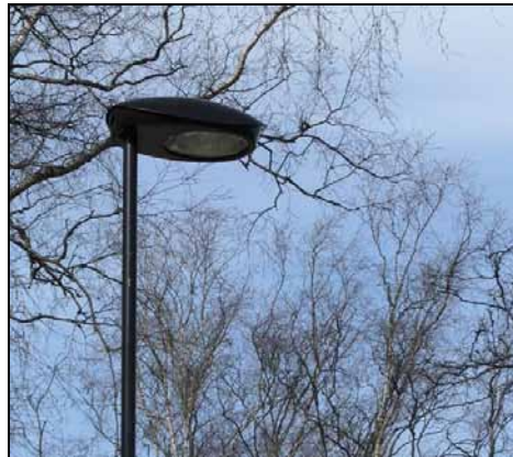
Kuva yllä: Rantareitillä käytössä oleva valaisintyyppi (Siteco).
