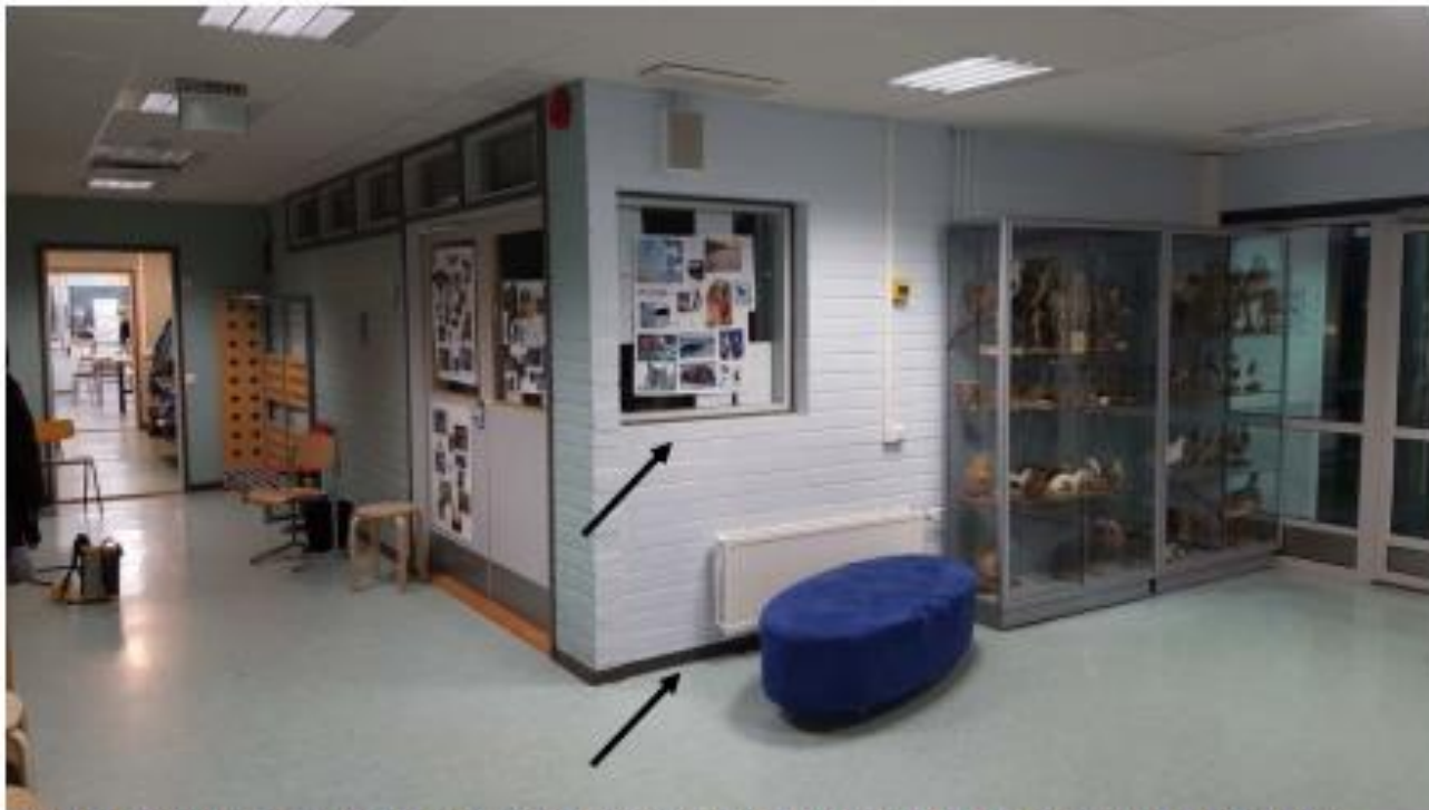
Kuva 2. Eteistilaan 301 rajoittuvien vanhojen ulkoseinien liittymissä mm. lattiaan ja ikkunarakenteisiin havaittiin mikrobiperäistä hajua. Haju oli tunnistettavissa yleisesti eteistilan huoneilmassa.
