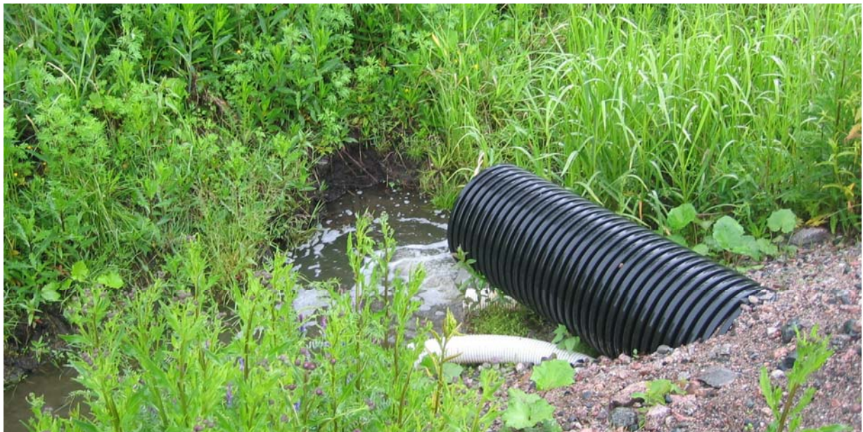
Kuva 2. Hulevesiputken pää Visamäessä.
