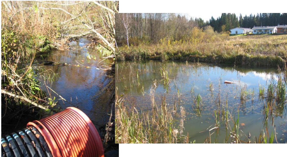
Kuva 15. Hulevesien käsittelyallas Kuralassa ja siitä Myllyjoaan johtava putki. Hulevesienputkien maisemointiin voisi jatkossa kiinnittää huomiota.
