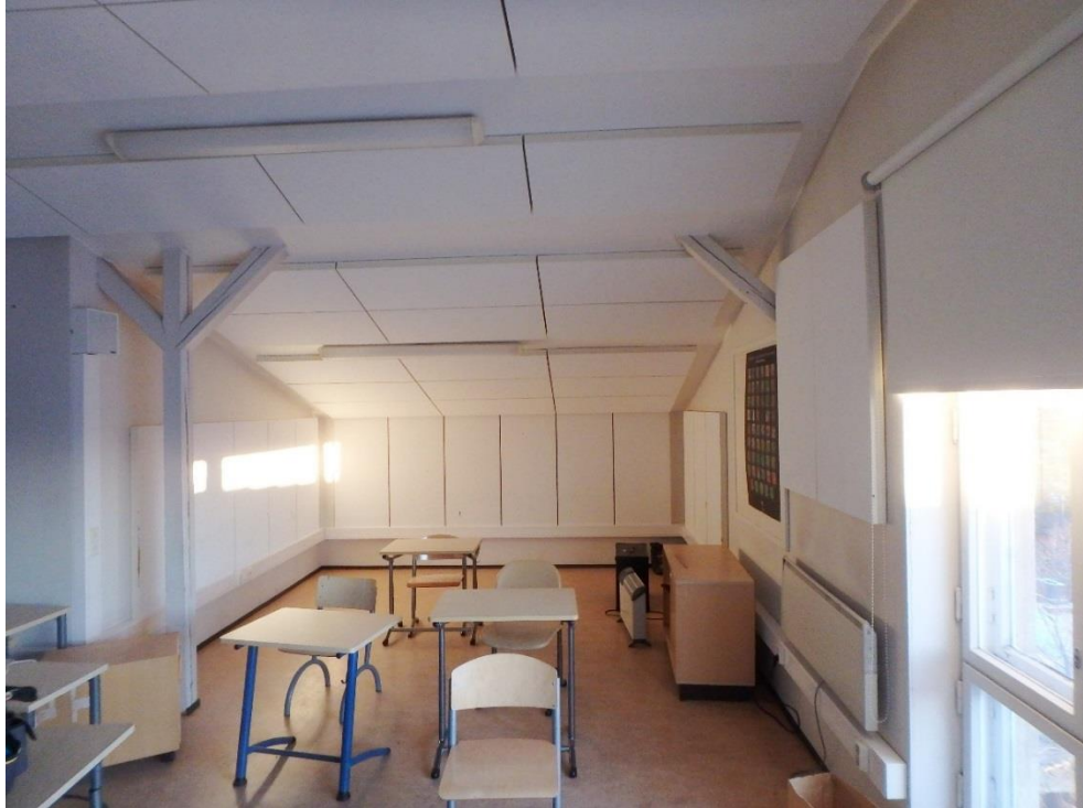
Kuva 26. Ullakkokerrokseen rakennettuun tilaan 409 tehty sisäpuolinen lisälämmöneritys. Ikkunarakenteen kohdalla kipsilevyt on asennettu suoraan tiilimuuraukseen. Lisälämmöneristeiden kohdalta höyrynsulun liittymät yläpohjaan ei ole asennettu ilmatiiviisti.
