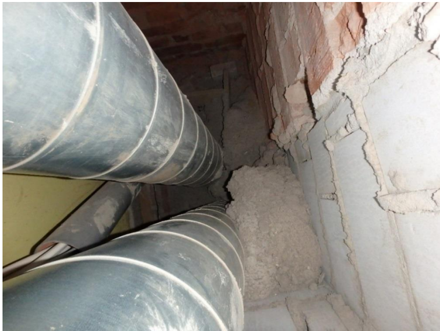
Kuva 32. Peruskorjauksessa tehtyjen hormien pohjalle on jätetty rakentamisen aikaista betoni- ja tiilijätettä. Hormien pohjat olivat pölyisiä.
