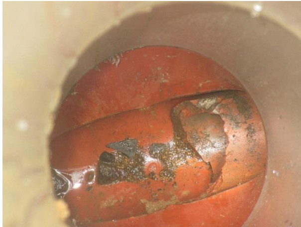
Kuva 39. Rakennuksen ulkopuolelta avattiin tilan 015 kohdalta yksittäinen salaojan tarkastuskaivo. Salaojat vaikuttavat tiilisalaojaputkilta. Salaojaputken alapinnan tasolla oli vähäisesti vettä ja lietettä.
