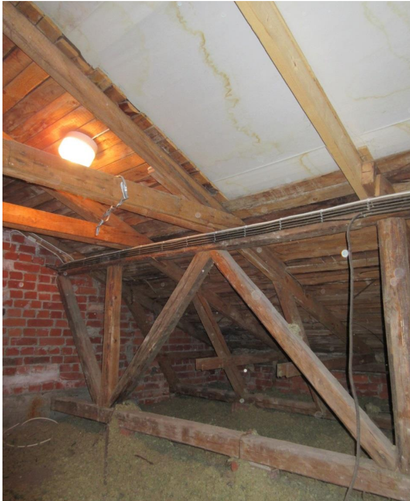
Kuva 36. Aluskatemuovin pinnassa oli havaittavissa laajasti vanhoja vesivuotojälkiä. Yläpohjaa on lisälämmöneristetty ohuesti edellisessä peruskorjauksessa.
