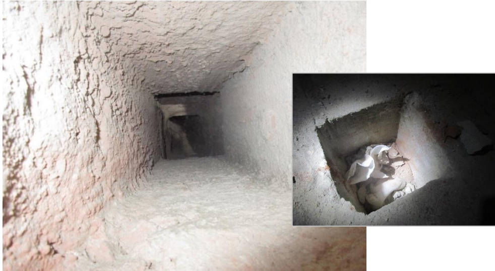
Kuva 31. Väliseinien hormit on poistettu käytöstä edellisessä peruskorjauksessa mm. koneellisen ilmanvaihdon lisäyksen takia. Kaikkia hormoneja ei ole suljettu ilmatiiviisti ullakolta.
