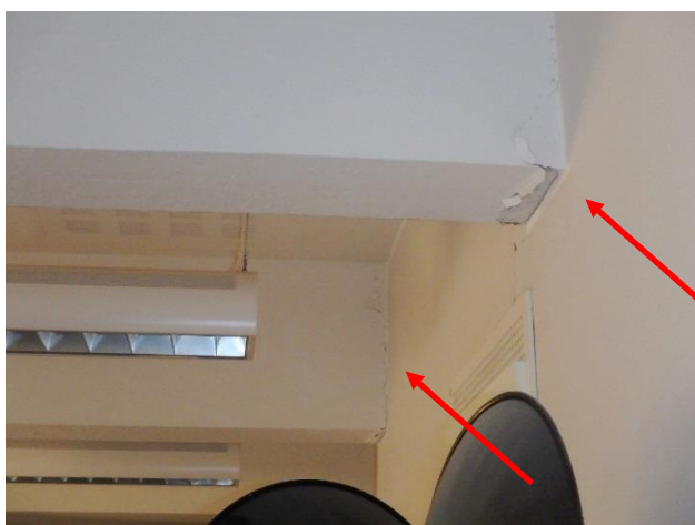
Kuva 30. Palkkien pinnoitteet irtoilevat, koska palkeilla ei ole liikevaraa suhteessa väliseinään
