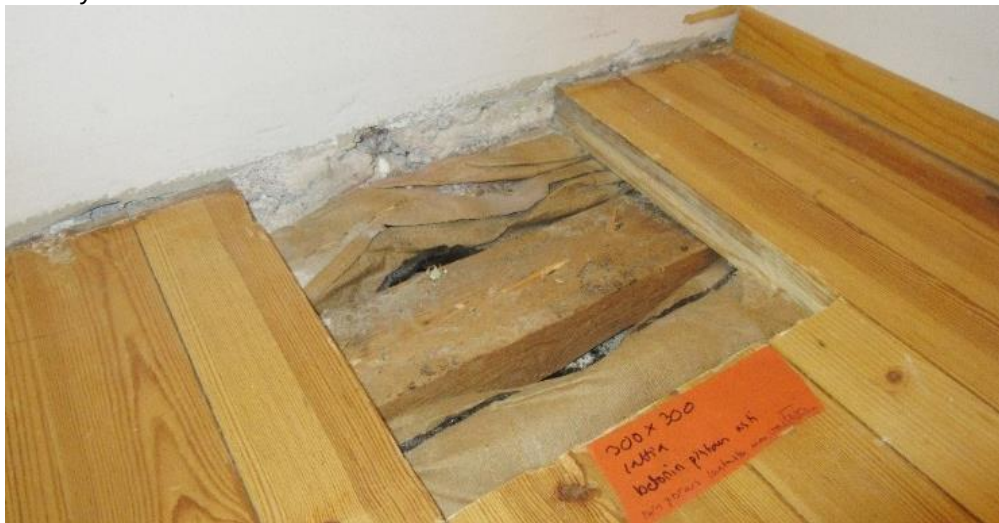
Kuva 7. Rakennesuunnitelmista poiketen liikuntasalin 063 lattiassa on tervapaperiin kääritty lasivillaeriste. Rakenne oli kuiva. Lasikuituvillasta irtoaa helposti villapölyä.
