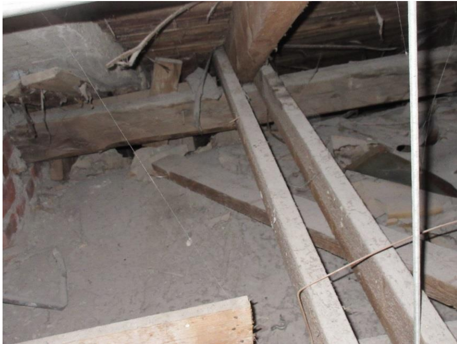
Kuva 37. Puurakenteisissa vesikattorakenteissa oli kosteusvalumajälkiä. Yläpohjatilassa oli rakentamisen aikaista puu-, tiili- ja betonijätettä.
