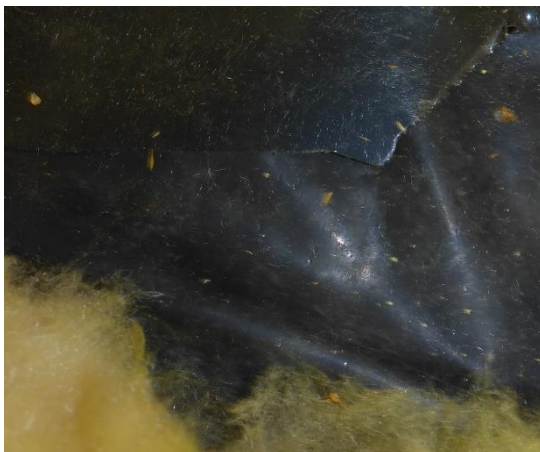
Kuva 11. Höyrynsulkumuovi eristeiden alla on osin tiivistämättä. Avoimia saumoja on erityisesti räystääslinjalla
