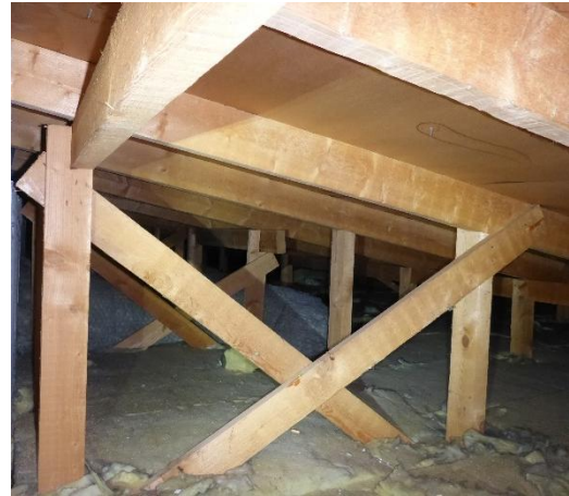
Kuva 10. Tuuletustilan mataluuden vuoksi alipainetuulettimet olisivat hyvä lisä tehostamaan tuulettumista
