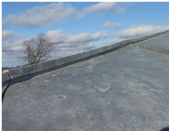
Kuva 12. Vesikatteen käyttöikä määrittää ulkojiirien kunto. Ne ovat lievästi nousseet ylöspäin, mutta vuotoja ei vielä havaittu
