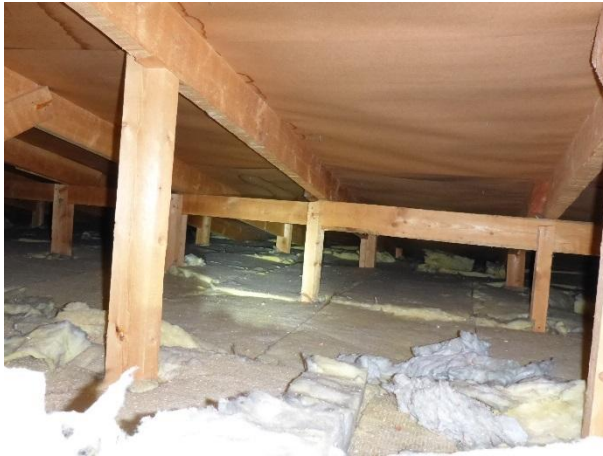
Kuva 9. Yläpohjan eristeet on asennettu vaihtelevasti
