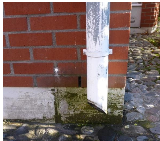
Kuva 8. Liiallinen seinärakenteen kosteus-kuormitus näkyy kohteella aistinvaraisesti
