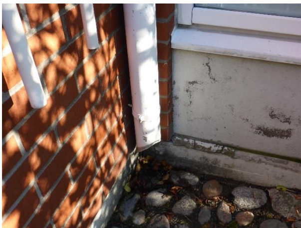
Kuva 7. Sokkelirakennetta ja ulkoseinän alaosa kuormittaa tarpeettomasti kattovesien ohjauspuutteen
