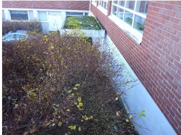
Kuva 6. PM-1 rakenne on haastavissa kosteusolosuhteissa. Maaperä on tiivistä, kosteaa ja ulkopuolinen vedeneriste puuttuu
