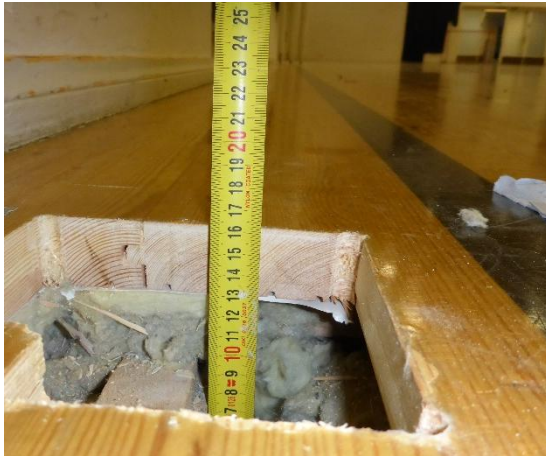
Kuva 1. Rakenteen kokonaispaksuus vastaa tarkasti suunnitelma-asiakirjoja
