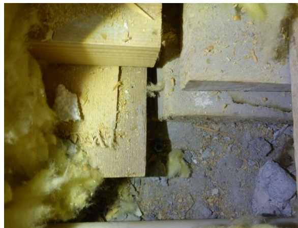
Kuva 4. Kantavan holvin päälle on jätetty rakennusvaiheessa muuraus- ja rakennusjätteet
