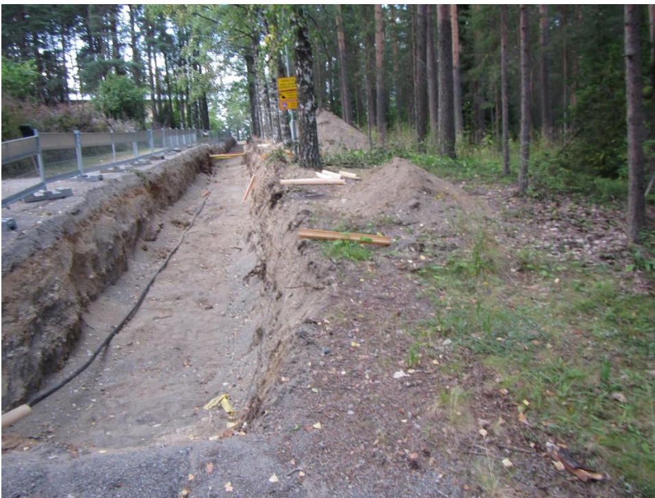
Kuva 4.4. Perhosselvityksen kohteen 3 pohjoispuolen tienvarteen ilmestyi kesällä 2019 kaivanto, ja yksi alueen suurimmista silmälläpidettävän kissankäpälän kasvustoista tuhoutui jäätyään kaivannon alle. (2.8.2019)
