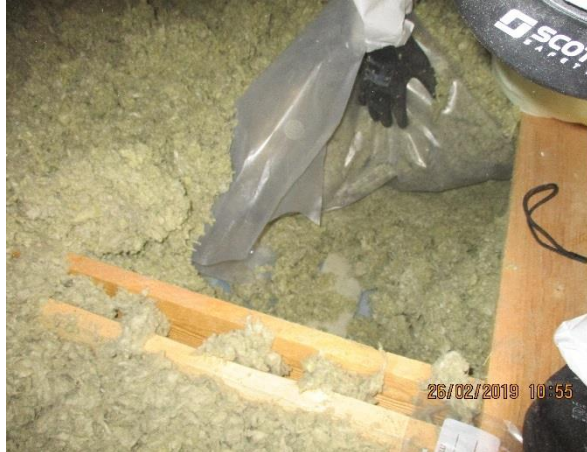
Kuva 33. Mineraalivillaa höyrynsulun väärällä puolella
