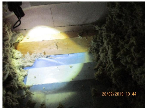
Kuva 21. huoneiston välisen seinän liittymät ovat tiivistämättä, vaikka kannatinpuu on suoraan liittymän kohdalla.
