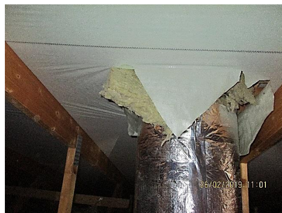
Kuva 30. Epätiivis IV-läpivienti aluskatteen läpi
