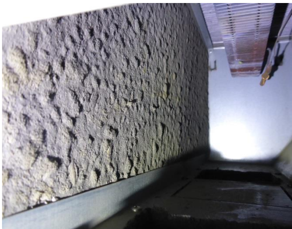
Kuva 38. Likainen äänenvaimennuspinta IV-koneen sisällä
