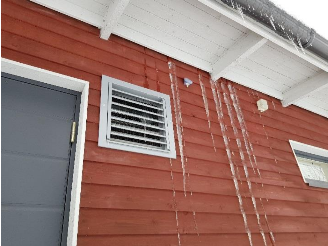
Kuva 7. Jääpuikkoja muodostuu räystäslinjalle poistoilmakanavasta tulevan hukkalämmön vuoksi
