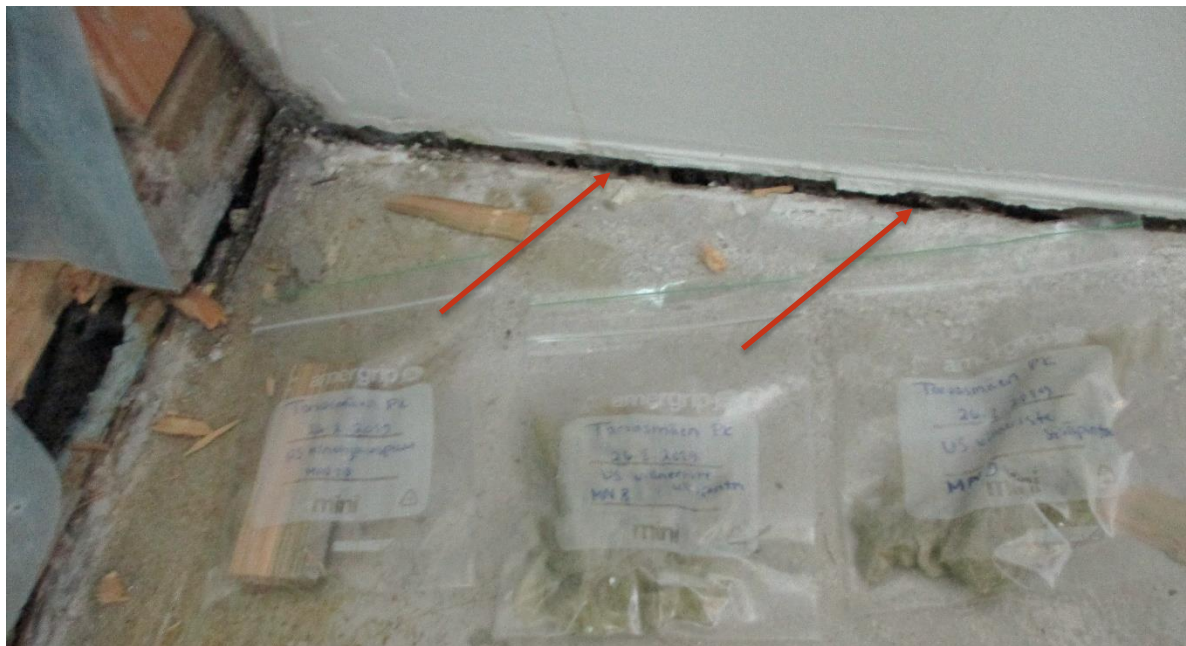
Kuva 2. Alapohjarakenteen ja osastoivan väliseinärakenteen liitoskohdassa epätiivis sauma
