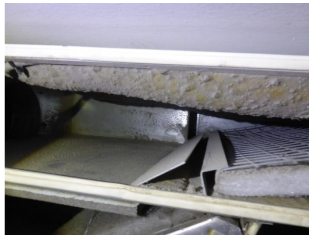
Kuva 39. Suodattimen ohivirtausta tapahtuu epätiivien kiinnitinkiskojen kautta
