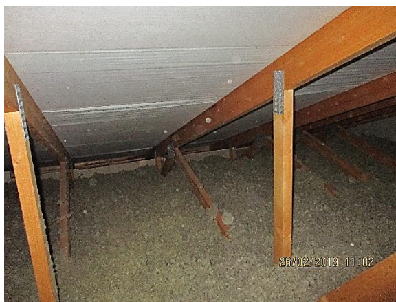
Kuva 29. Vesikaton aluskate on asennettu liian tiukalle ja tuulenohjaimia puuttuu
