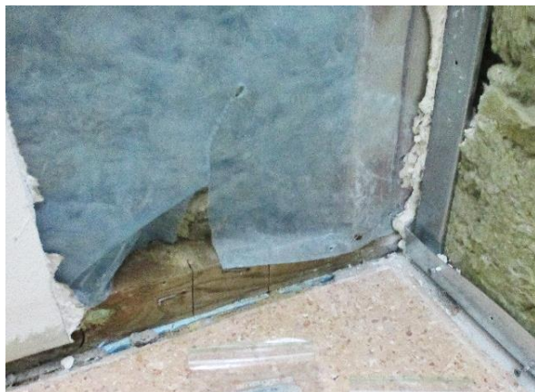
Kuva 8. Höyrynsulkumuovin alapää on tiivistämättä ja kiinnittämättä alapohjarakenteeseen
