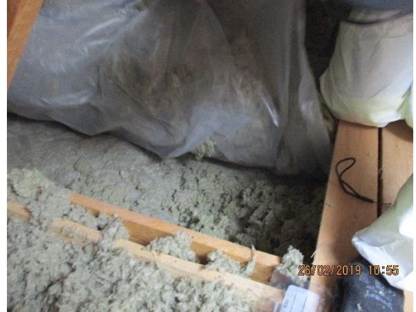
Kuva 34. Höyrynsulku on asennettu yläpohjaan epätiivisti, ja sen saa poistettua vain nostamalla. Näin ei kuuluisi olla.
