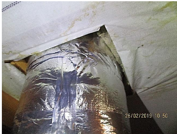
Kuva 31. IV-läpivienti epätiivis ja aluskatteessa vuotojälkiä
