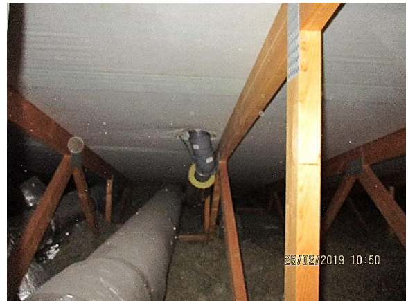
Kuva 32. Aluskatteen IV-läpivienti epätiivis ja putken eristettä puuttuu
