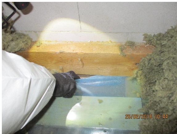
Kuva 20. Höyrinsulkumuovi on kiinnittämättä yläpohjan kannattajiin. Vuotolinja on suuri
