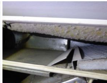
Kuva 39. Suodattimen ohivirtausta tapahtuu epätiivien kiinnitinkiskojen kautta
