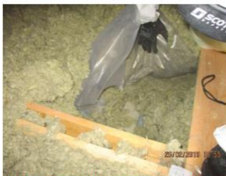
Kuva 33. Mineraalivillaa höyrnsulun väärällä puolella
