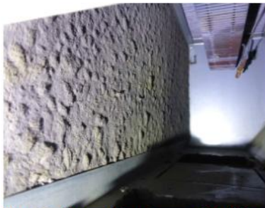
Kuva 38. Likainen äänenvaimennuspinta IV-koneen sisällä
