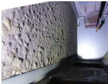
Kuva 38. Likainen äänenvaimennuspinta IV-koneen sisällä
