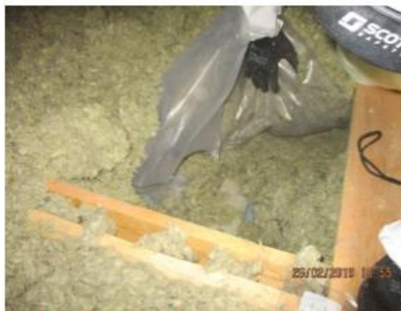
Kuva 33. Mineraalivillaa höyrnsulun väärällä puolella
