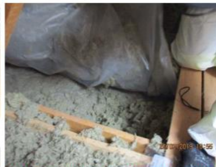
Kuva 34. Höyrnsulku on asennettu yläpohjaan epätiivisti, ja sen saa poistettua vain nostamalla. Näin ei kuuluisi olla.
