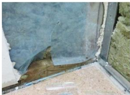
Kuva 8. Höyrinsulkumuovin alapää on tiivistämättä ja kiinnittämättä alapohjarakenteeseen
