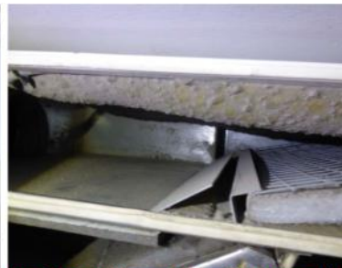
Kuva 39. Suodattimen ohivirtausta tapahtuu epätiivien kiinnitinkiskojen kautta
