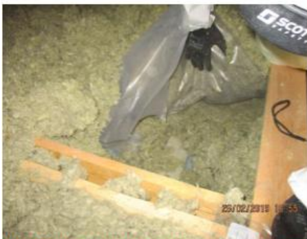
Kuva 33. Mineraalivillaa höyrnsulun väärällä puolella
