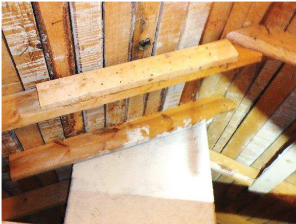
Kuva 173. Kosteusjälkiä vesikaton puurakenteissa hormin lähistöllä.
