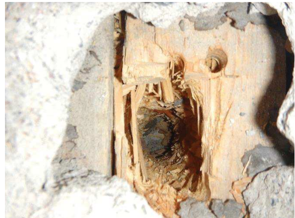
Kuva 147. Tervapaperista ja purueristeestä otetuissa näytteissä havaittiin mikrobialalyseissä viitteitä mikrobivaurioista ja muottilaudoituksesta otetussa näytteessä havaittiin mikrobialalyysissä heikkoja viitteitä mikrobivaurioista.
