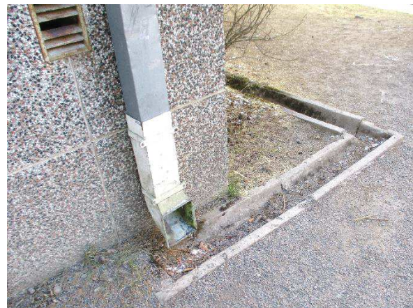
Kuva 47. Syöksytorvien alapuolisissa loiskekupeissa ja vesikouruissa on likakertymää ja kourujen kallistukset ovat vähäisiä.
