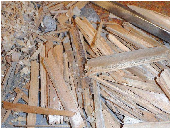
Kuva 143. Lahovaurioitunutta välipohjan muottilaudoi-tusta.
