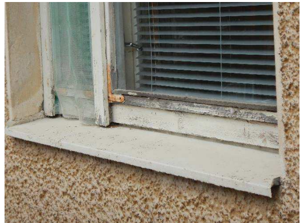
Kuva 80. Ikkunoiden puuosissa on runsaasti maalipinnoite- ja lahovaurioita.
