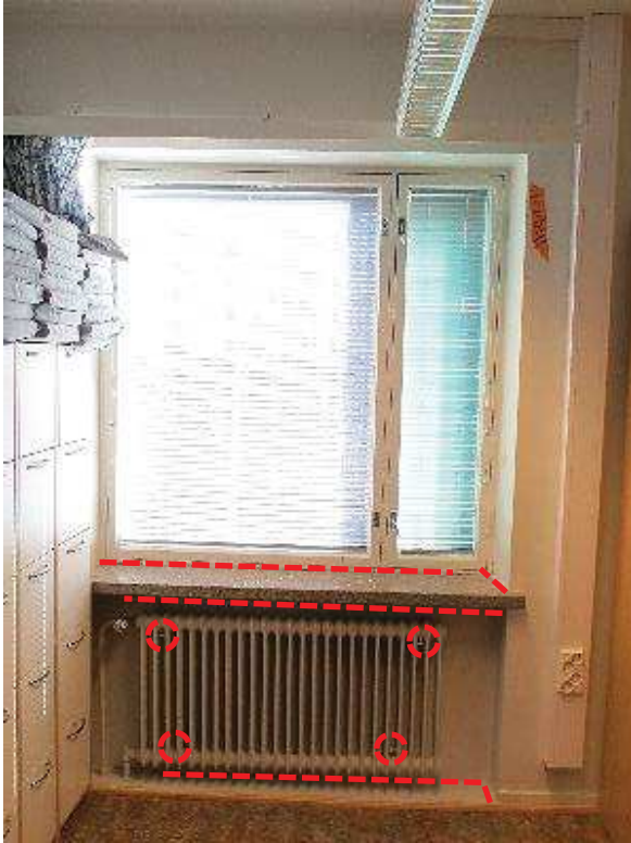
Kuva 115. Merkkiainekoe MAK6, ulkoseinä, ryhmätyöhuone A108. Patterisyyvennyksen eristehalkaisusta havaittiin merkittävää ilmavuotoa välipohja- ja ikkunaliittymistä, ikkunapenkin liittymistä sekä halkeamakohtista. Pistemäisiä ilmavuotoja havaittiin lämmityspatterin kiinnikekohdissa.
