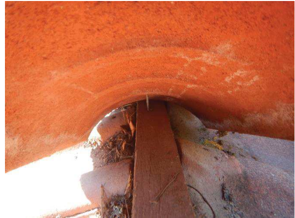
Kuva 183. Harjalla sijaitsevat tuuletusraot ovat kapeita ja ne ovat tukkeutuneet likakertymästä.
