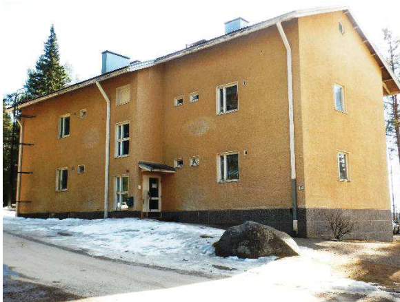
Kuva 69. Yleiskuva julkisivusta. Julkisivurappauksessa on maalipinnoitevaurioita ja kosteusrasitukseen viittaavia kalkkihärmejä. Vaurio- ja kosteusjäljet erottuvat muusta julkisivusta selvästi ja ne sijoittuvat etenkin ikkunoiden ja räystäiden alapuolelle sekä märkätilojen kohdille.
