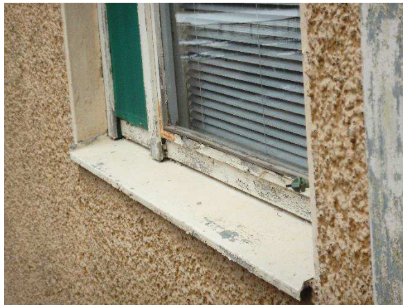
Kuva 79. Ikkunat ovat alkuperäisiä puuikkunoita, joiden yleiskunto on heikko.
