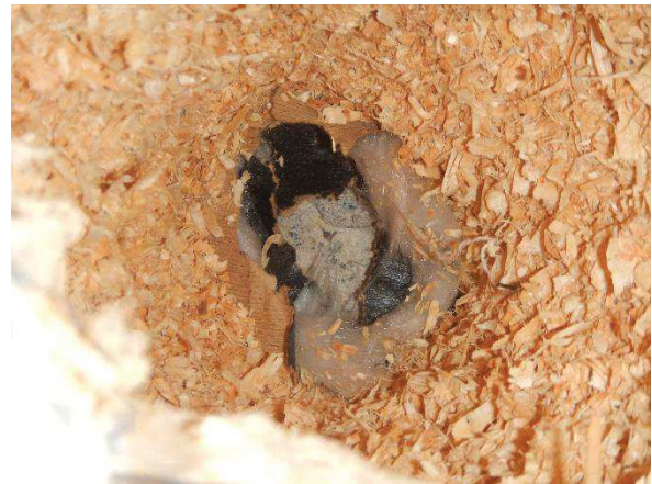
Kuva 136. Purueristeestä otetussa näytteessä havaittiin mikrobianalyysissä heikkoja viitteitä mikrobivauriosta.
