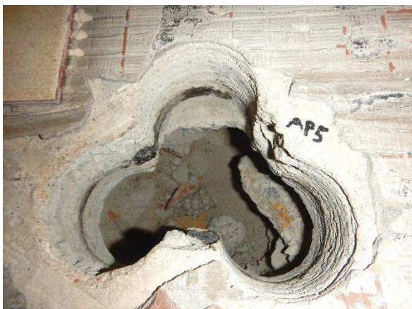
Kuva 31. Alapohja on kotelolaattarakenteinen ja ryömintätalallinen. Kotelolaatan yläpinnassa on vedeneristetty pintabetonilaatta. Eristettyinä on rakennusjätettä, mm. betonin, muurauslaastin palasia ja puunkappaleita.
