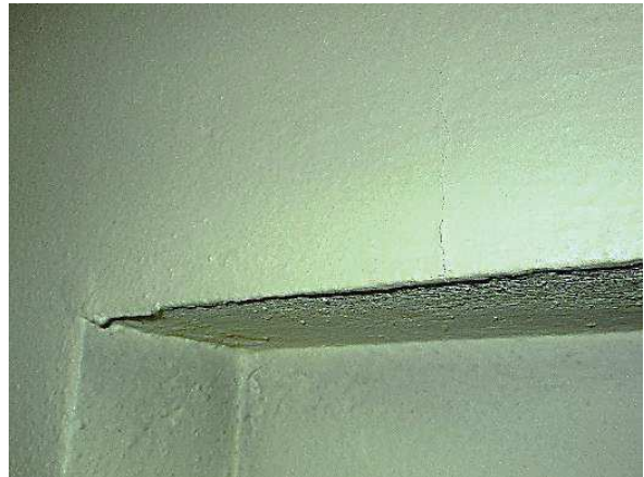
Kuva 51. Pinnoiltaan tasoitetuissa ja maalatuissa kuorimuurauksissa on yksittäisiä halkeamia.
