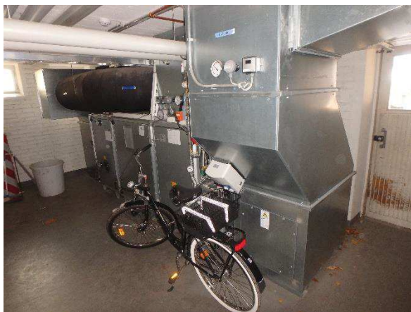
Kuva 199. Yleiskuva ilmanvaihtokoneesta TK01.
