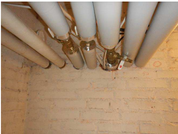
Kuva 158. Ryömintätilan vastaisen seinän sisäkuori on puhtaaksimuurattu ja maalattu. Seinässä on epätiivitä putkiläpivientejä. Vanhimpien putkien putkieristeen ovat asbestipitoisia. Kuva varastotilasta A015.
