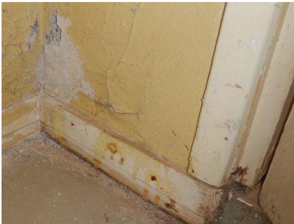
Kuva 156. Kellarin pukuhuoneen A004 väliseinän alaosassa on kosteusrasituksesta aiheutuneita maalipinnoite- ja tasoitevaurioita.
