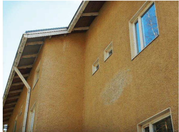
Kuva 70. Julkisivurappauksen vaurio- ja kosteusjälkiä räystään alapuolella ja märkätilan kohdalla.
