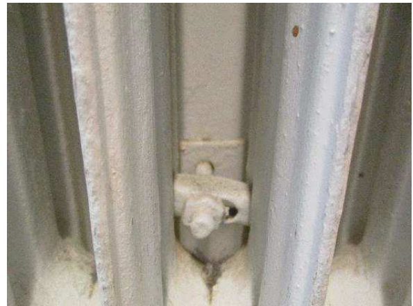
Kuva 118. Merkkiainekoe MAK6, ulkoseinä, ryhmätyöhuone A108. Lämmityspatterin kiinnikkeiden kohdilla havaittiin pistemäisiä ilmavuotoja.
