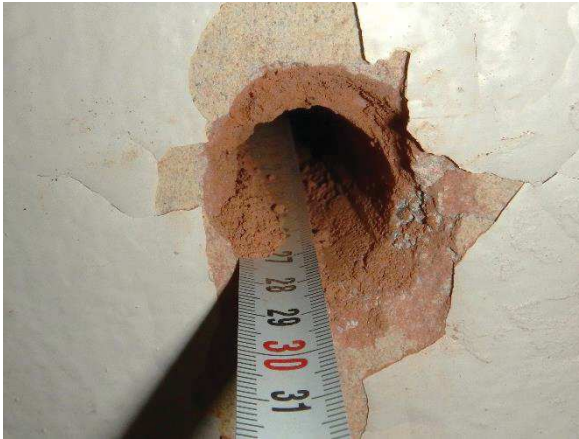
Kuva 166. Väliseinä on tiilirakenteinen. Väliseinä- kenteessä ei havaittu rakenneavauskohdalla eriste- halkaisua.
