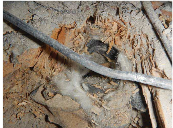
Kuva 192. Muottilaudoituksessa havaittiin pitkälle edenneitä lahovaurioita.
