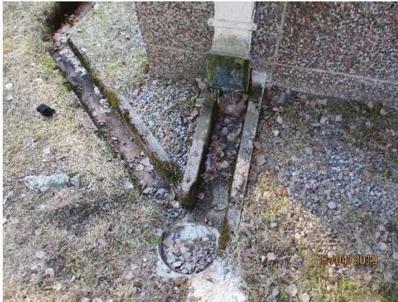
Kuva 197. Syöksytorvien alapuolilla on loiskekupit ja -kourut. Perusmuurien ulkopinnoilla ei ole vedeneristystä.
