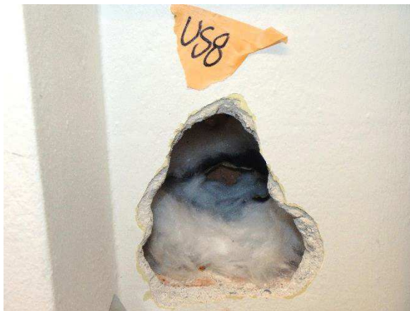
Kuva 100. Ulkoseinä on patterisyyvennyksen kohdalla sisä- ja ulkokuoriltaan tiilirakenteinen ja lasivillaeristeinen. Paperipäälysteisestä lasivillasta otetussa näytteessä havaittiin mikrobianalyysissä heikkoja viitteitä mikrobivauriosta.
