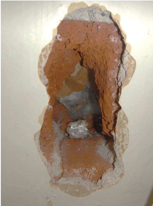
Kuva 110. Ulkoseinä on patterisvennyksen kohdalla sisä- ja ulkokuoriltaan tiilirakenteinen ja lasivillaeristeen. Sisäpuolisen tiilimuurauksen ja lämmöneristeen välissä on työteknisistä syistä muodostunut ilmaväli.
