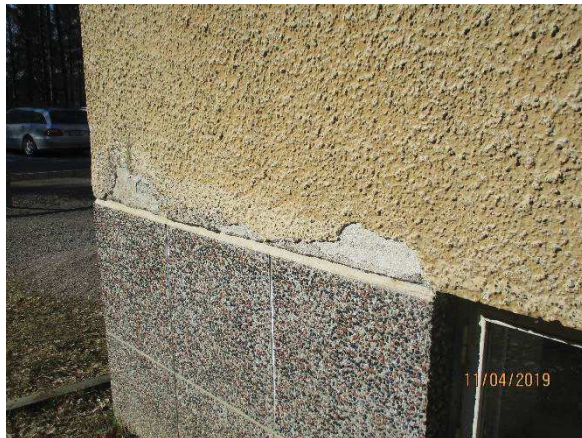
Kuva 73. Julkisivurappauksessa on paikallisia rapautumavaurioita ja halkeamia.
