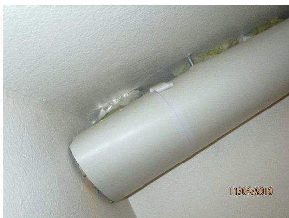
Kuva 219. Suojaamatonta mineraalivillaa putkieristeissä.
