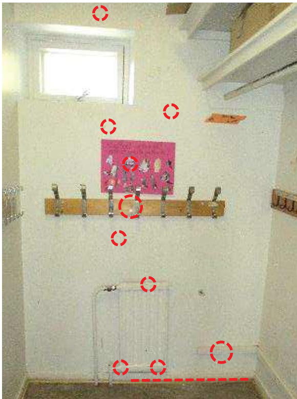
Kuva 119. Merkkiainekoe MAK7, ulkoseinä, vaatehuone A117. Massiivitiilirakenteisesta ulkoseinästä havaittiin merkittävää ilmavuotoa ryömintätillaisen alapohjan liittymässä. Pistemäisiä ilmavuotoja lämmityspatterin kiinnikekohdissa sekä seinän sisäpinnan paikkauskohdissa (vanhoissa läpivienti- ja kiinnikekohdissa tms.)
