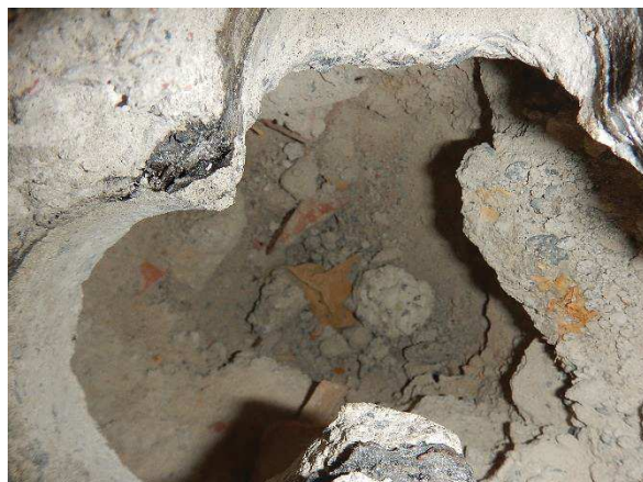
Kuva 32. Bitumikermi ja -sively sisältää asbestia. Eristettyä materiaalia otetussa näytteessä havaittiin mikrobianalyyysissä vahvoja viitteitä mikrobivauriosta.
