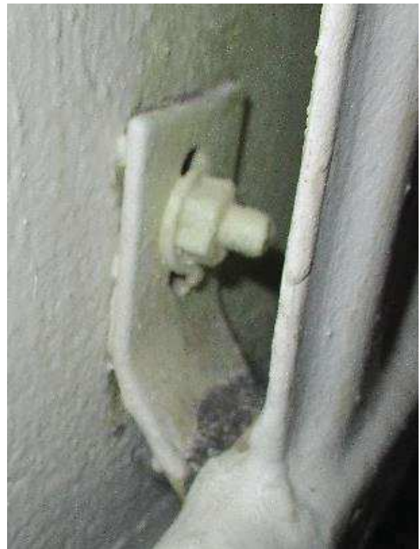
Kuva 120. Merkkiainekoe MAK7, ulkoseinä, vaatehuone A117. Lämmityspatterin kiinnikkeiden kohdilla havaittiin pistemäisiä ilmavuotoja.
