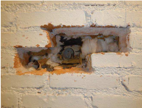
Kuva 62. Maanvastainen seinä on sisäpuolelta kosteus- ja lämmöneristetty betonirakenne. Sisäkuorimuurauksessa on halkeamia ja reikiä.
