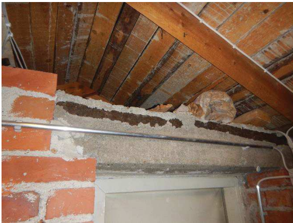
Kuva 177. Porrashuoneen yläpohjan korkkieristeet ovat paikoin näkyvissä.
