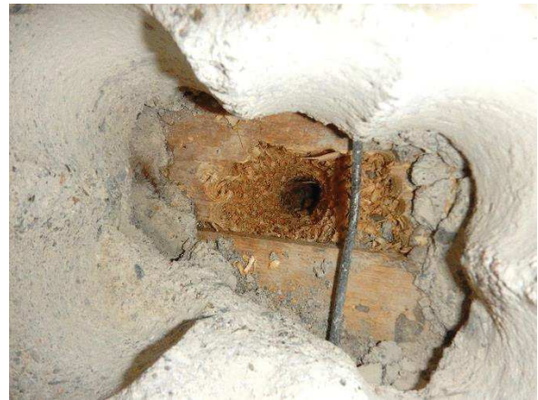
Kuva 29. Tervapaperista ja lasivillamatosta otetuissa näytteissä havaittiin mikrobianalyyseissä heikkoja viitteitä mikrobivaurioista.
