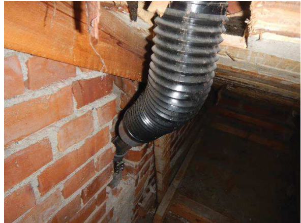
Kuva 176. Lämmöneristämätön tuuletusviemäri yläpohjatilassa.
