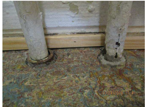
Kuva 44. Merkkiainekoe MAK3. Alapohjan ulkoseinäliittymässä on rako, jonka kautta havaittiin merkittävää ilmavuotoa sisäilmaan. Patteriputkiläpiviennit ovat epätiivitä ja niiden kohdilta havaittiin pistemäistä ilmavuotoa sisäilmaan.
