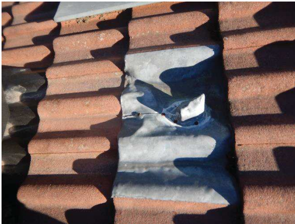
Kuva 182. Epätiivis käytöstä poistetun läpivientipellit, jossa on tiivistysmassapaikkauksia.
