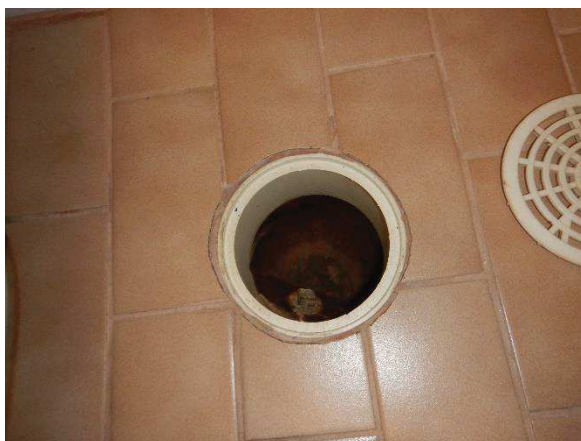
Kuva 127. Välipohjien lattiakaivot ovat alkuperäisiä valurautakaivoja, jotka ovat ylittäneet teknisen käyttöikänsä. Muovisen korokerenkaan liittymä valurautakaivoon ei ole vesitiivis. Kaivo oli tarkastushetkellä kuiva. Kuva kylpyhuoneesta A216.
