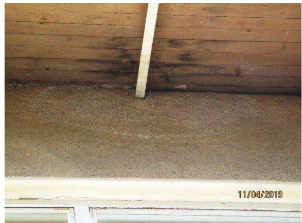
Kuva 72. Julkisivurappauksen kosteusjälkiä räystään alapuolella ja kosteusjälkiä vesikaton puurakenteissa.
