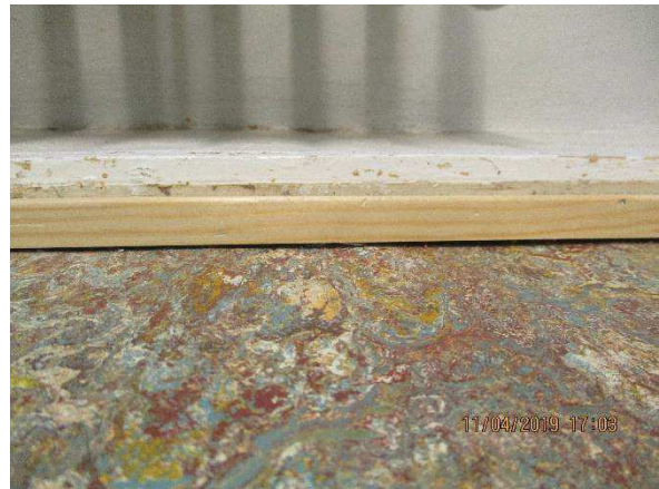
Kuva 152. Merkkiainekoe MAK8, välipohja, ryhmätyöhuone A108. Ulkoseinäliittymässä on rako, josta havaittiin ilmavuotoa välipohjan eristetilasta.
