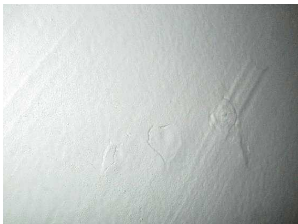
Kuva 122. Merkkiainekoe MAK7, ulkoseinä, vaatehuone A117. Ulkoseinässä havaittiin pistemäisiä ilmapuotokohtia sisäpinnan paikkauskohdissa (vanhoissa läpivienti- ja kiinnikekohdissa tms.).
