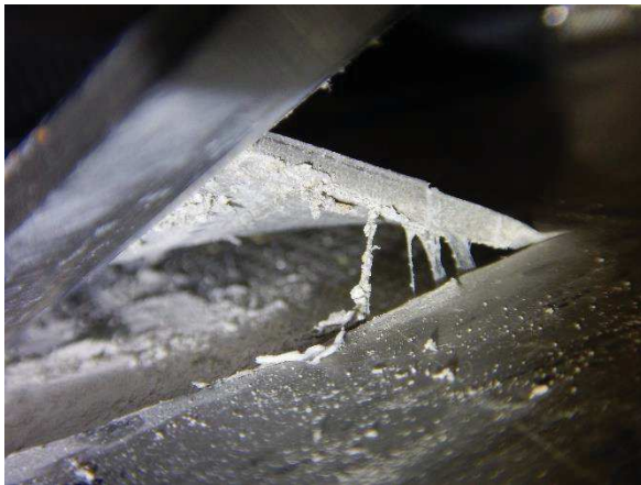
Kuva 33. Viiltomittaus VM1. Muovimaton kiinnitysliimassa ja lattiatasoiteessa on kosteuden aiheuttamaa pehmentymistä.
