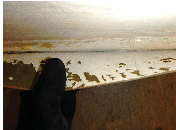
Kuva 157. Kellarin teknisen tilan A008 väliseinän alaosan seinätasoite ja lattiamaton ylösnoston kiinnitysliima on hieman pehmentynyt kosteuden vaikutuksesta.
