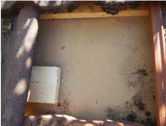
Kuva 181. Vesikatteen alapuolinen tuuletusväli on kapea.
