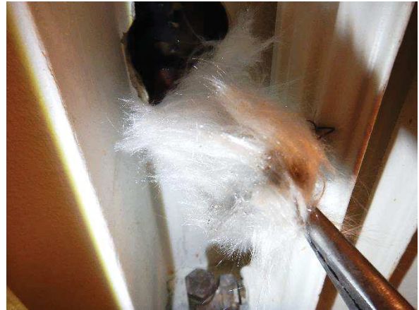
Kuva 106. Lasivillaeristeessä havaittiin värimuutoksia.
