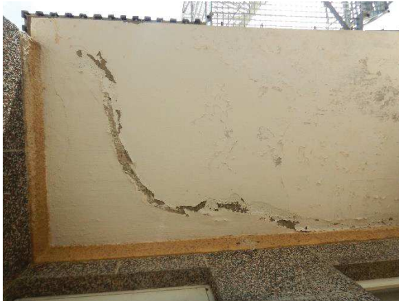
Kuva 87. Betonirakenteisten parvekelaattojen alapinnoissa on laatan läpi päässeeseen kosteuden aiheuttamia maalipinnoitevaurio- ja kalkkihärmejä.
