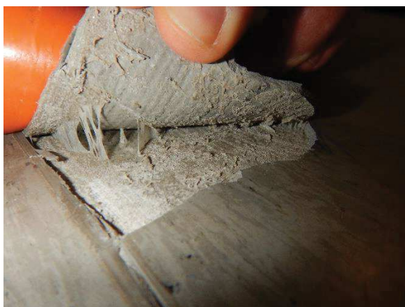
Kuva 37. Viiltomittaus VM5. Muovimaton kiinnitysliimassa ja lattiatasoiteessa on kosteuden aiheuttamaa pehmentymistä.
