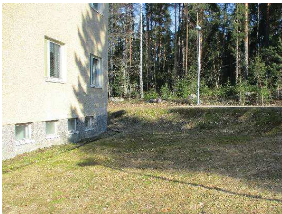
Kuva 46. Maanpinta kallistaa rakennuksen suuntaan etenkin ylärinteen puolella.
