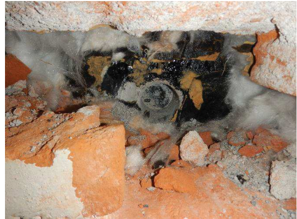
Kuva 57. Bitumisively on PAH-yhdisteiden suhteen vaarallista jätettä. Paperipäällysteisestä lasivillasta otetussa näytteessä havaittiin mikrobianalyysissä heikkoja viitteitä mikrobivauriosta.
