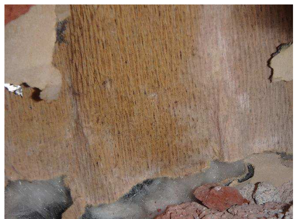
Kuva 98. Alumiinipaperissa ja lasivillaeristeen päällyspaperissa havaittiin kosteuden aiheuttamia värimuutoksia. Alumiinipaperista otetussa näytteessä havaittiin mikrobianalyysissä heikkoja viitteitä mikrobivauriosta.
