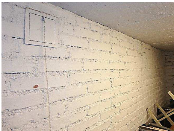
Kuva 52. Puhtaaksimuurattujen sisäkuorten liittymissä ja muuraussaumissa on monin paikoin halkeamia ja reikiä.
