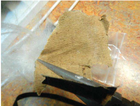
Kuva 105. Paperipäälysteisessä lasivillassa havaittiin kosteuden aiheuttamia värimuutoksia ja eristeestä otetussa näytteessä havaittiin mikrobianalyyssissä heikkoja viitteitä mikrobivauriosta.
