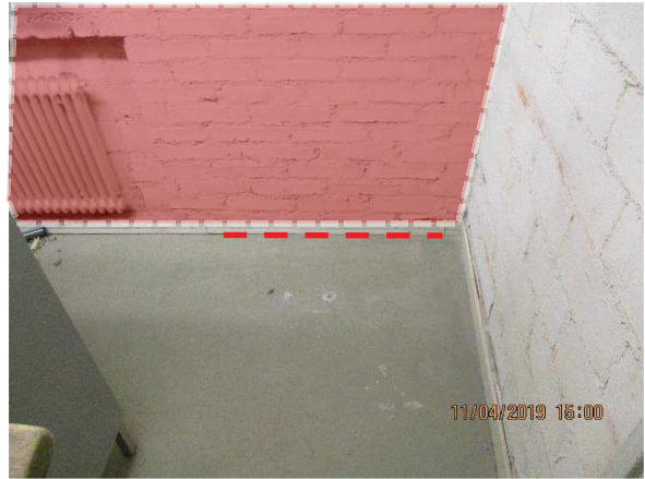
Kuva 65. Merkkiainekoe MAK5, maanvastainen seinä, mankelihuone A007. Seinän sisäkuoren muuraus-saumoista havaittiin merkittäviä ja säännöllisesti toistuvia ilmavuotoreittejä. Myös seinän alapohjaliittymässä havaittiin merkittävää ilmavuotoa liittymässä olevan raon kautta.
