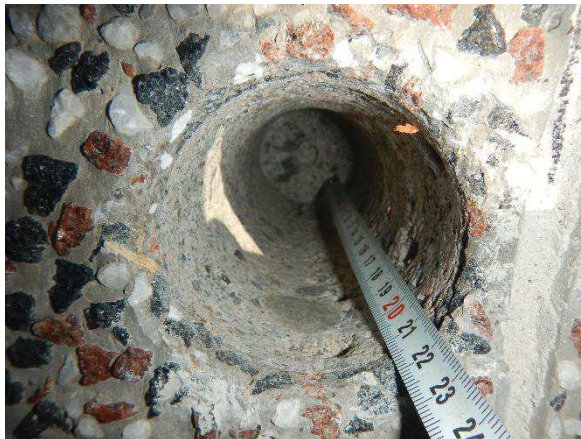
Kuva 90. Sokkeli on betonirakenteinen ja kivirouhepinnoitteinen. Kivirouhepinnoitteen seassa havaittiin yksittäisiä puunkappaleita.
