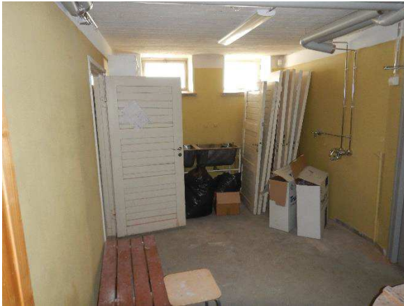
Kuva 167. Yleiskuva kellarin pesutuvan A006 pintamateriaaleista. Pintarakenteet ovat lähes alkuperäiskuntoisia ja niiden yleiskunto on heikko. Pintamateriaaleissa on kosteusvauriojälkiä.
