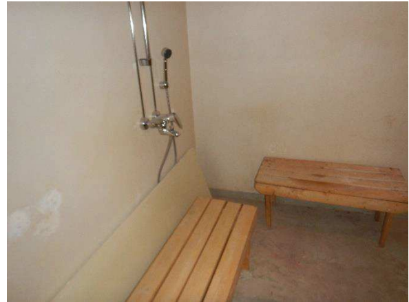
Kuva 168. Yleiskuva kellarin pesuhuoneen A005 pintamateriaaleista. Pintarakenteet ovat lähes alkuperäiskuntoisia ja niiden yleiskunto on heikko. Pintamateriaaleissa on kosteusvauriojälkiä.
