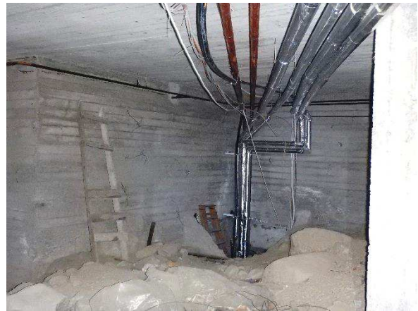
Kuva 15. Osa ryömintätilan kautta johdetuista putkista on lämmöneristämättömiä.
