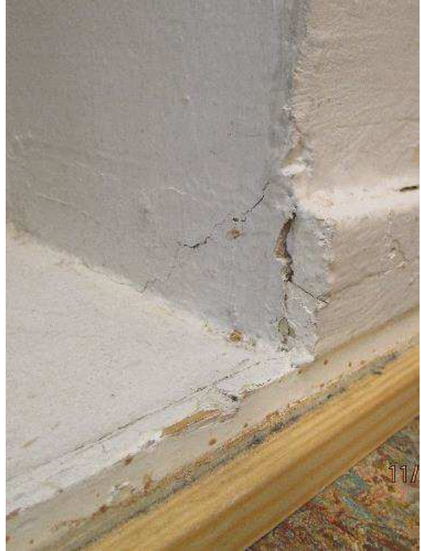
Kuva 116. Merkkiainekoe MAK6, ulkoseinä, ryhmätyöhuone A108. Patterisyyvennyksen sisäkuoressa on halkeamia, joista havaittiin merkittävää ilmavuotoa.
