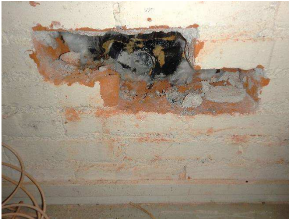
Kuva 56. Maanvastainen seinä on sisäpuolelta kosteus- ja lämmöneristetty betonirakenne. Sisäkuorimuurauksessa on halkeamia ja reikiä. Bitumisively on yhtenäinen ja tiivis.
