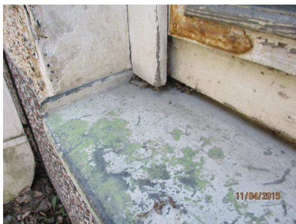
Kuva 83. Ikkunoiden vesipellitysten kallistukset ovat vähäisiä ja vesipellitysten liittymät seiniin ovat epätiivitä. Vesipellitysten kallistukset ja pellitysten kiinnitystapa ovat puutteellisia nykysuosituksiin verraten.
