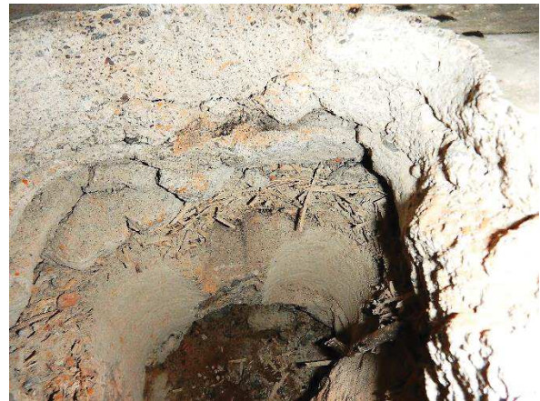
Kuva 23. Lastusementtilevyeristeestä otetussa näytteessä havaittiin mikrobianalyysissä viitteitä mikrobivauriosta.
