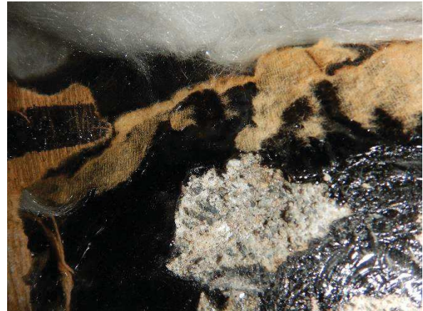
Kuva 60. Bitumisively on irronnut alustastaan. Bitumisivelyn ja perusmuurin välissä on kalkkihärmettä. Paperipäällysteisestä lasivillasta otetussa näytteessä havaittiin mikrobianalysissä heikkoja viitteitä mikrobivauriosta.
