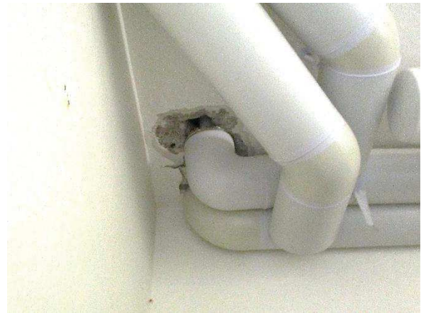
Kuva 130. Välipohjissa on epätiivitä putkiläpivientejä Kuva vaatehuoneesta A117.
