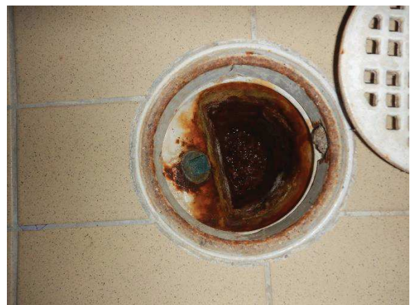
Kuva 128. Korokerenkaan liittymä valurautakaivoon ei ole vesitiivis. Kuva kylpyhuoneesta A203.
