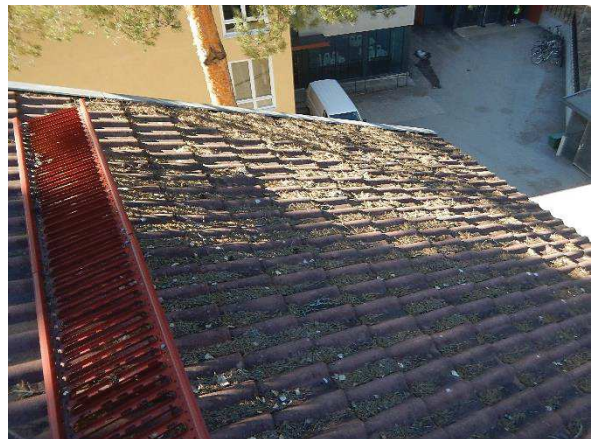
Kuva 180. Tiilikatteiden pinnat ovat paikoin kuluneita. Vesikatteella on likakertymää etenkin rakennuksen vierustalla sijaitsevien puiden lähistöllä.
