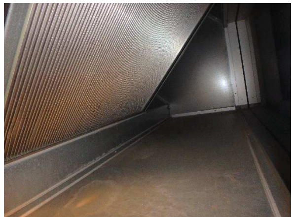
Kuva 207. Lämmön talteenottokenno on puhdas, ja se on varustettu viemäroinnillä.
