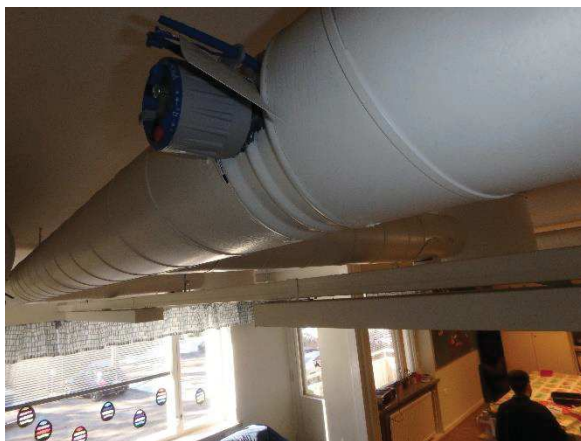
Kuva 212. Ilmavirtojen säädöt on tehty PRA-säätö- ja mittauslaitteilla.
