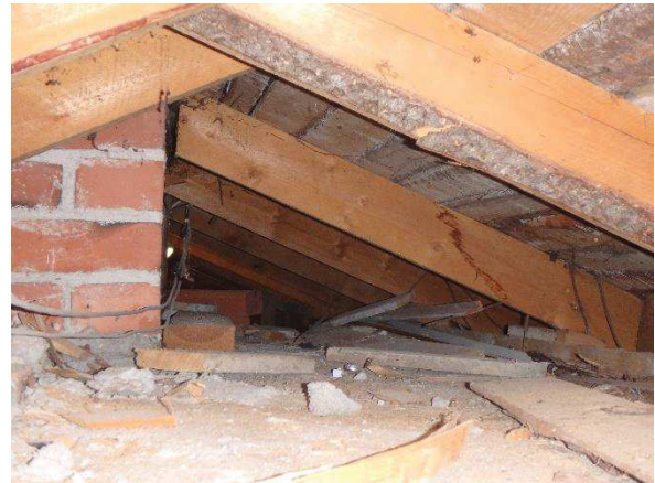
Kuva 174. Kosteusjälkiä vesikaton puurakenteissa.
