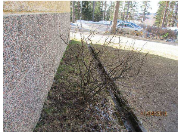
Kuva 198. Loiskekourujen kallistukset ovat vähäisiä ja kouruissa on runsaasti sammal- ja likakertymää.
