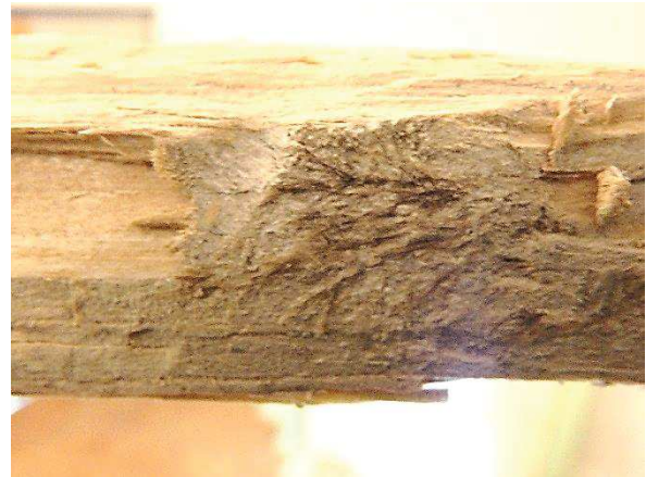
Kuva 142. Muottilaudoituksessa havaittiin lahovauri-oita ja näkyvää mikrobikasvustoa.
