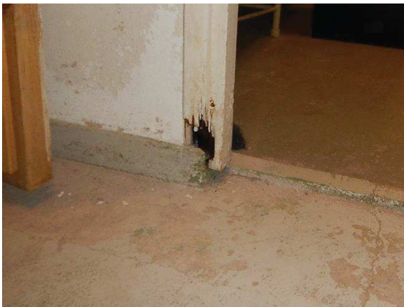
Kuva 6. Maanvaraisiin alapohjiin liittyvissä puurakenteissa jalkalistoissa ja ovenkarmeissa on kosteusrasituksen viittaavia jälkiä. Pesuhuoneen A005 oven puukarmien alaosassa havaittiin lahovaurioita.
