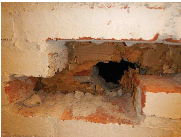
Kuva 161. Ryömintätilaan rajoittuva seinä on rakenneavauskohdalla sisä- ja ulkokuoriltaan tiilirakenteinen ja lämmöneristeenä on rakennuspahvi sekä puukuitulevy. Rakenneavauskohdalla oleva rakenne eroaa ympäröivästä seinärakenteesta, koska kohdalla on todennäköisesti ollut ryömintätilan kulkuaukko.
