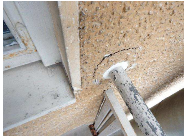
Kuva 74. Julkisivurappaus on lohjennut ja parvekekai- teen kiinnityskohdalta. Kaikeen kiinnitys ulkoseinään on heikentynyt.
