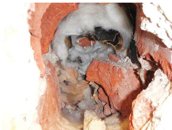
Kuva 97. Ulkoseinä on patterisyyvennyksen kohdalla sisä- ja ulkokuoriltaan tiilirakenteinen ja lasivillaeristeinen. Paperipäällysteisestä lasivillasta otetussa näytteessä havaittiin suoramikroskopoinnissa mahdollisia kuolleeseen mikrobikasvustoon viittaavia rakenteita.
