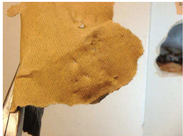
Kuva 101. Lasivillaeristeen päällyspaperissa havaittiin kosteuden aiheuttamia värimuutoksia.
