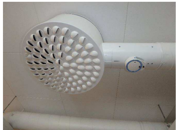
Kuva 217. Tuloilman päätelaitteet olivat puhtaita.
