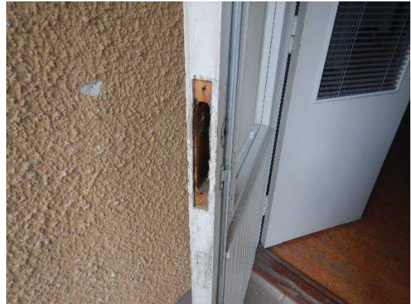
Kuva 86. Parvekeovet ovat tyydyttävässä kunnossa. Häätäpoistumistienä toimivan parvekeoven ulomman ovilehden alkuperäinen lukitusmekanismi on korvattu salpalukituksella.
