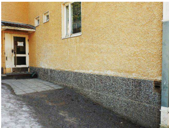
Kuva 71. Julkisivurappauksen vaurio- ja kosteusjälkiä ulkoseinän ja sokkelin liittymässä, ikkunoiden alapuolella ja märkätilan kohdalla.
