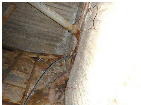
Kuva 13. Ryömintätallassa kulkeva alkuperäinen viemäriputki on haljennut. Viemäriputken lähistöllä on vuotojälkiä perusmuurissa ja maataytössä.
