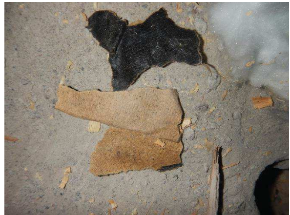
Kuva 194. Lasivillaaersteen päällyspaperissa on kosteuden aiheuttamia värimuutoksia. Paperipäällysteisestä lasivillasta otetussa näytteessä havaittiin mikrobialyysissä heikkoja viitteitä mikrobivaurioista.
