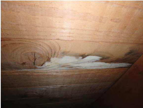
Kuva 175. Näkyvää mikrobikasvustoa vesikaton puurakenteissa.
