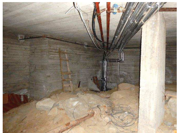
Kuva 11. Ryömintätalran betonirakenteissa on kosteusrasituksen viittaavia kalkkihärmejä.
