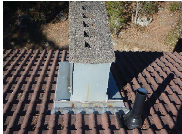
Kuva 184. Ruostevaurioita ja vettä kerääviä painaumia hormin vesipellitöyksessä. Hormissa ei ole sääsuojaa.
