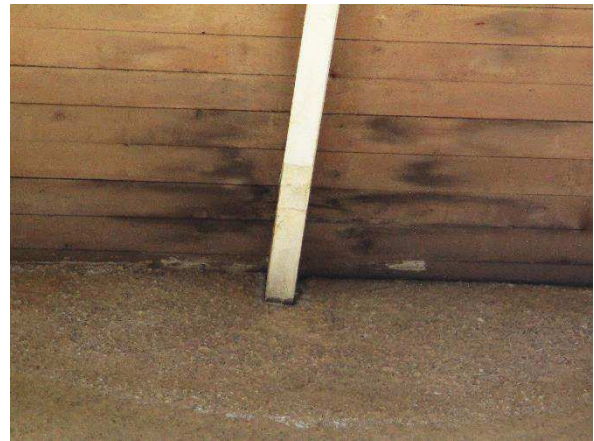
Kuva 188. Vesikattovuodosta aiheutuneita kosteusjälkiä vesikaton puurakenteissa räystään alapinnalla.
