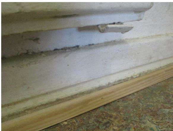
Kuva 121. Merkkiainekoe MAK7, ulkoseinä, vaatehuone A117. Ulkoseinän ja ryömintätilallisen alapohjan liittymässä havaittiin merkittävää ilmapuottoa.
