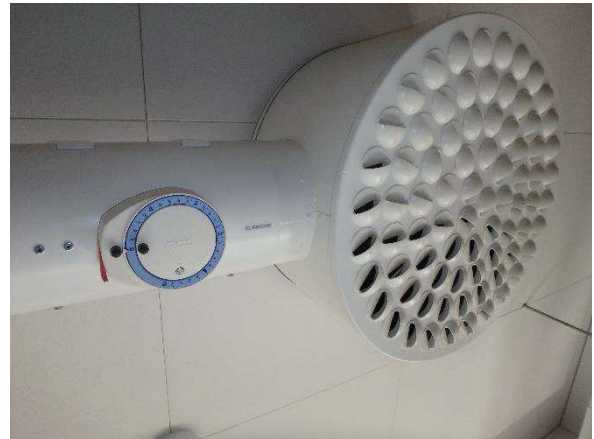
Kuva 211. Kattohajottajien säädöt olivat maksimiasennossa, jolloin ilmanjako ei ole huoneissa tasapainossa.
