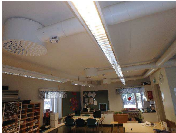
Kuva 210. Luokkatilojen ilmanjako on toteutettu NOP-kattohajottajilla
