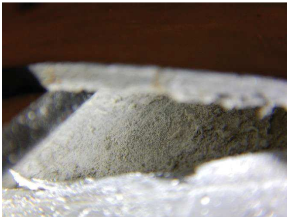
Kuva 35. Viiltomittaus VM3. Muovimaton kiinnitysliimassa ja lattiatasoiteessa on kosteuden aiheuttamaa pehmentymistä.
