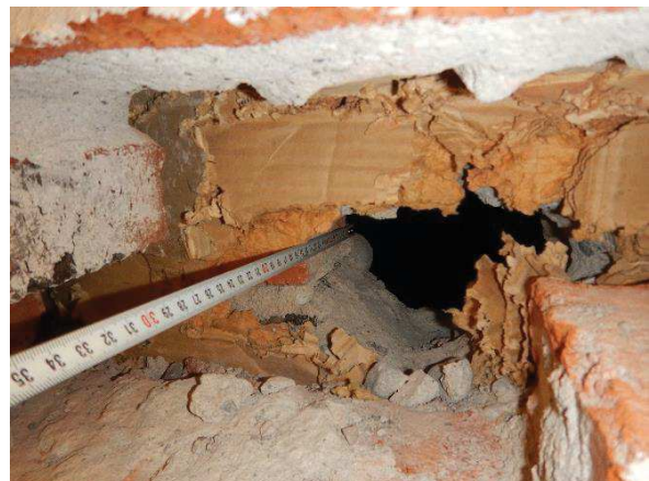
Kuva 162. Rakennuspahvista otetussa näytteessä havaittiin suoramikroskopoinnissa mahdollisia kuolleeseen mikrobikasvustoon viittaavia rakenteita.
