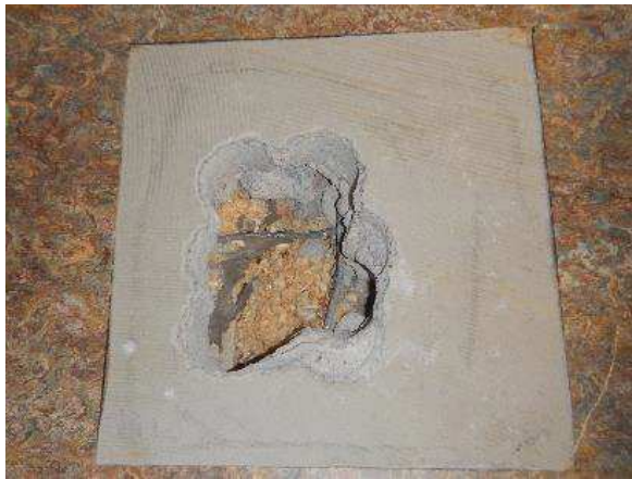
Kuva 135. Välipohja on kotelolaattarakenteinen. Tervapaperista otetussa näytteessä havaittiin mikrobi-analyysissä heikkoja viitteitä mikrobivauriosta.
