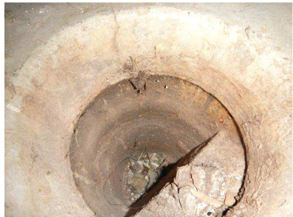
Kuva 7. Alapohjien lattiakaivot ovat alkuperäisiä valurautakaivoja, jotka ovat ylittäneet teknisen käyttöikänsä. Valurautakaivojen liittymät alapohjalaattoihin eivät ole vesitiiviitä.
