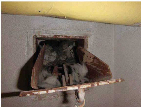
Kuva 216. Kellarikerroksen painovoimaisen ilmanvaihdon päätelaitteet ja rakenneaineiset ilmanakanavat ovat likaisia.
