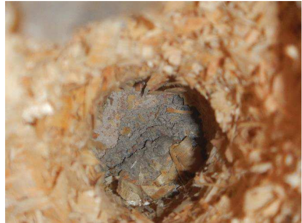
Kuva 139. Alalaatan yläpinnassa havaittiin laastin- ja tiilenpalasia.
