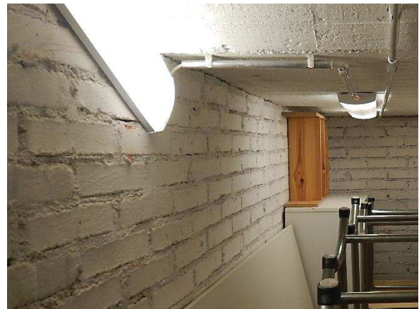
Kuva 159. Ryömintätilan vastaisen seinän sisäkuoren laastisaumoissa on halkeamia sekä reikiä. Kuva varastotilasta A015.
