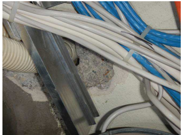
Kuva 178. Puutteellisesti tiivistetty sähköjohtoläpivienti yläpohjalaatassa hormitilassa A210.
