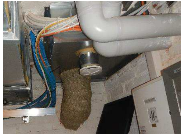
Kuva 17. Kellarin varastotilan (sähköpääkeskuksen) A010 ilmanvaihto on liitetty todennäköisesti samaan painovoimaisen ilmanvaihdon kanavistoon ryömintätilan ilmanvaihdon kanssa. Kuvassa oleva mineraalivillateinen kanava on johdettu seinän läpi ryömintätilaan (ks. edellinen kuva).
