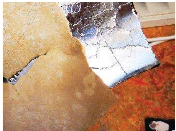
Kuva 104. Alumiinipaperissa havaittiin kosteuden aiheuttamia värimuutoksia ja alumiinipaperista otetussa näytteessä havaittiin mikrobianaalysissä heikkoja viitteitä mikrobivauriosta.
