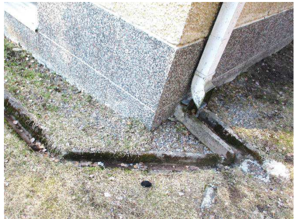
Kuva 49. Perusmuurien ulkopinnoissa ei ole vedeneristystä.
