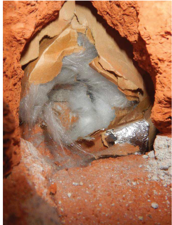
Kuva 111. Paperipäällysteisestä lasivillasta otetussa näytteessä havaittiin mikrobianalyysissä heikkoja viitteitä mikrobivauriosta.
