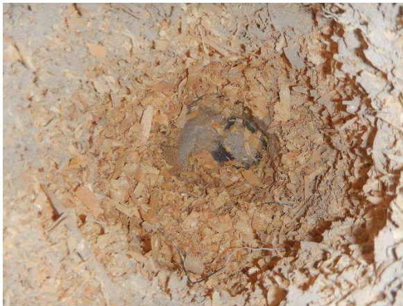
Kuva 193. Purueristeessä on kosteuden aiheuttamia värimuutoksia. Purueristeestä otetussa näytteessä havaittiin mikrobialyysissä heikkoja viitteitä mikrobivaurioista.
