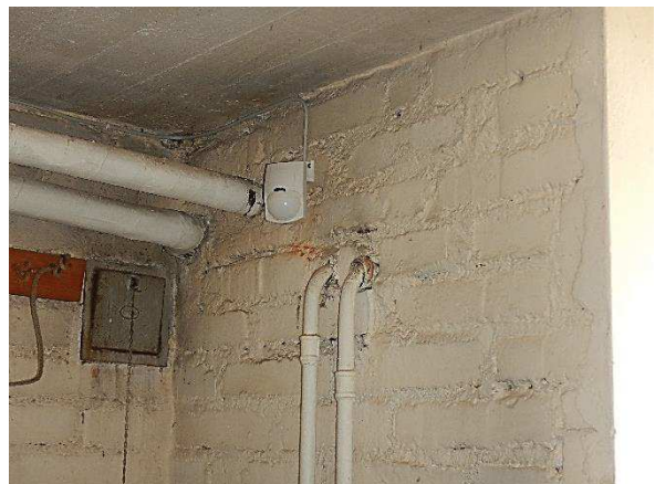
Kuva 53. Seinien sisäkuorissa on epätiivitä putkiläpivientejä.
