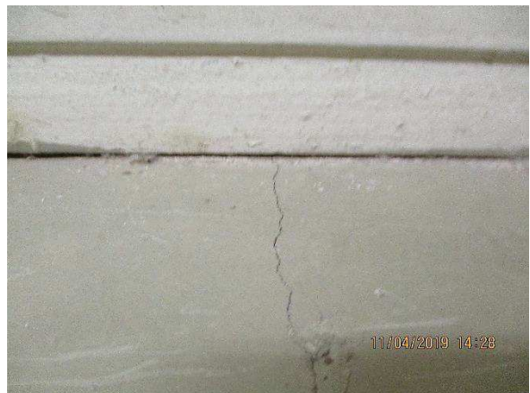
Kuva 42. Merkkiainekoe MAK2. Alapohjarakenteen pintabetoni on paikoin halkeillut, minkä takia rakenne on epätiivis. Maanvastaisen ulkoseinän ja alapohjan liittymässä on rako.
