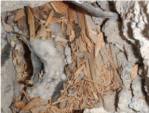
Kuva 141. Välipohja on kotelolaattarakenteinen. Lasi-villassa havaittiin kosteusvauriojälkiä.
