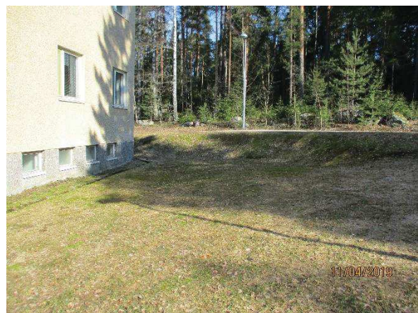
Kuva 196. Etenkin ylärinteen puolella rakennusta ympäröivät maanpinnat viettävät rakennukseen päin.
