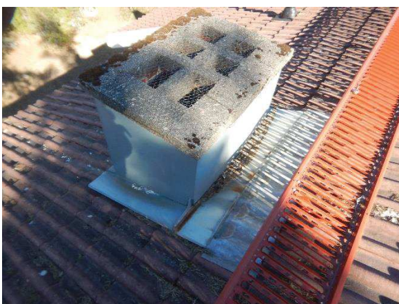
Kuva 185. Ruostevaurioita ja painanteita hormin vesipellitöyksessä. Hormissa ei ole sääsuojaa.
