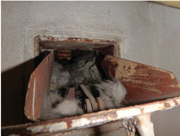
Kuva 54. Seinien sisäkuorissa on epätiiviyyskohtia ilmanvaihdon luukkuventtiilien kohdilla.
