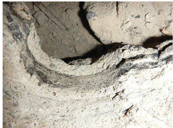
Kuva 150. Pintalaatan bitumikermi ja -sively sisältää asbestia. Eristetäyttömateriaalista otetussa näytteessä havaittiin mikrobialyysissä vahvoja viitteitä mikrobivauriosta.
