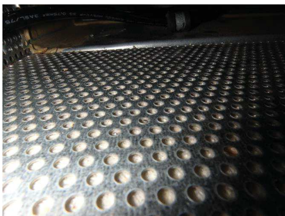
Kuva 208. Tuloilmakammiossa havaittiin reikälevyn takana suojaamatonta mineraalivillaa äänenvaimenninmateriaalina.
