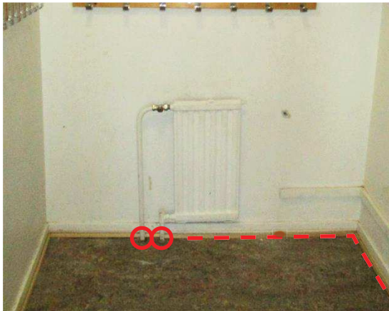
Kuva 43. Merkkiainekoe MAK3, ryömintätilallinen kotelolaatta-alapohja, vaatehuone A117. Alapohjan eristetilasta havaittiin merkittävää ilmavuotoa alapohjan ulko- ja väliseinäliittymien sekä putkiläpiviennin kohdilla.
