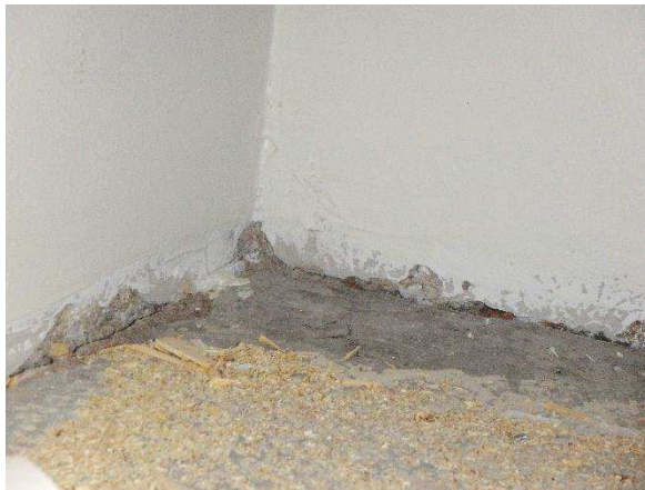
Kuva 129. Välipohjien ulkoseinäliittymissä on rakoja. Kuva luokkatilasta A212.
