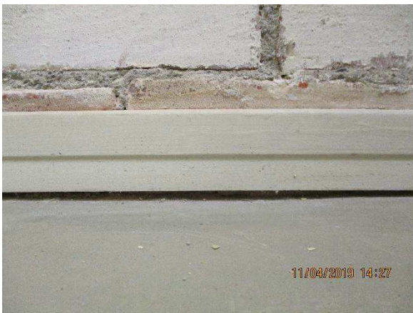
Kuva 41. Merkkiainekoe MAK2. Alapohjan ja väliseinän rakenneliittymässä on rako, jonka kautta havaittiin merkittävää ilmavuotoa sisäilmaan.
