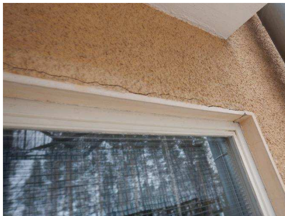
Kuva 75. Julkisivurappauksessa on halkeamalinja ik- kunan yläpuolella.
