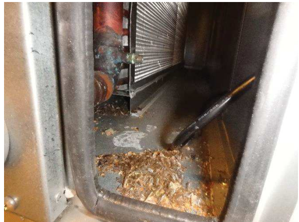
Kuva 205. Ilmanvaihtokoneen sisälle oli kertynyt hyönteisiä, jotka tulisi puhdistaa seuraavan suodatinvaihdon yhteydessä.
