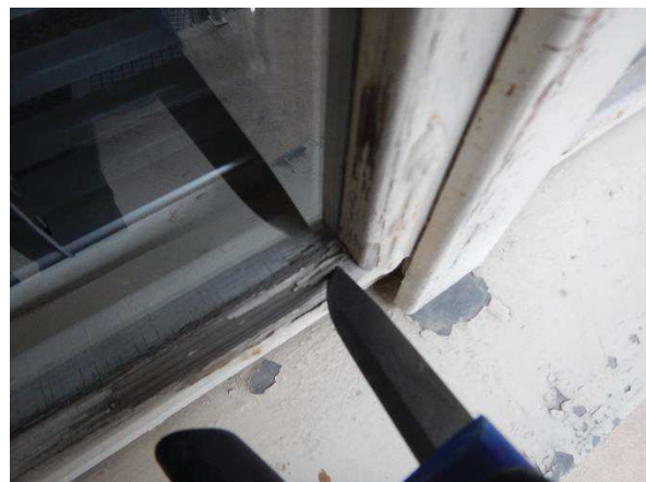
Kuva 82. Maalipinnoite- ja lahovaurioita ikkunan ulkopuitteen puuosissa.
