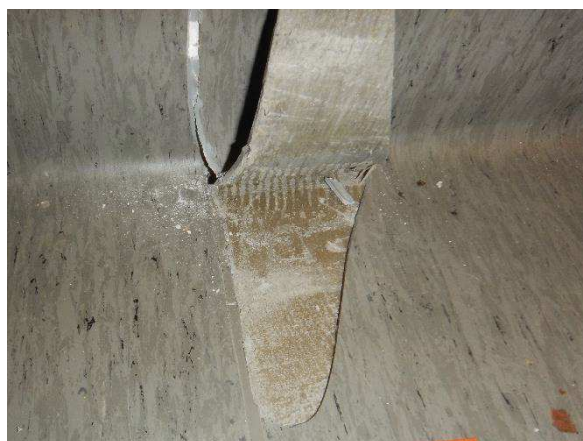
Kuva 38. Viiltomittaus VM6. Muovimaton kiinnitysliimassa ja lattiatasoiteessa on lievää kosteuden aiheuttamaa pehmentymistä.
