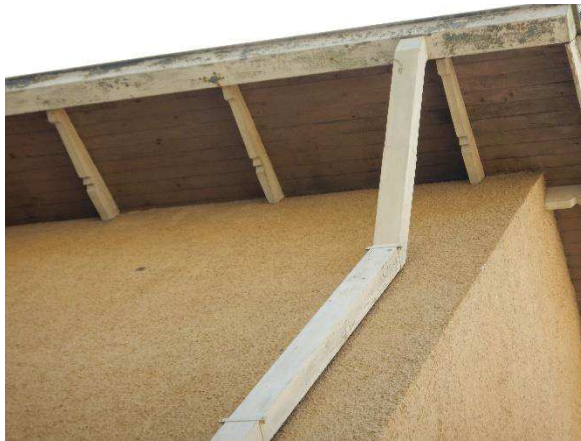
Kuva 187. Sadevesikouruissa ja syöksytorvissa on maalipinnoite- ja korroosiovaurioita.
