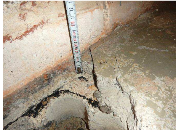
Kuva 20. Väliseinä tukeutuu pohjalaataan. Väliseinän ja pohjalaatan välissä on bitumisively. Alapohjan tervapaperit ja bitumisivelyt ovat PAH-yhdisteiden suhteen vaarallista jätettä. Tervapaperista otetussa näytteessä havaittiin mikrobialalyysissä viitteitä mikrobivauriosta.
