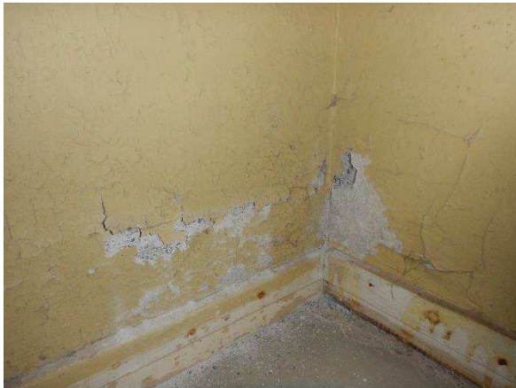
Kuva 50. Maanvastaisten seinien kuorimuurausten maalipinnoitteet lehteilevät irti.
