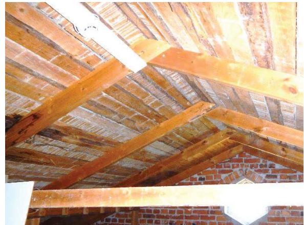
Kuva 172. Kosteusjälkiä vesikaton puurakenteissa. Vesikattorakenteina on osittain käytetty muottipuutava- ra.
