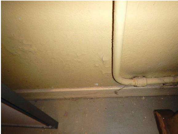
Kuva 4. Maanvaraisen alapohjan ulko- ja väliseinäliittymissä on betonin kuivumiskutistumisesta aiheutuneita rakoja.
