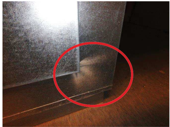
Kuva 203. Ilmanvaihtokoneen tarkastusluukuissa havaittiin merkkejä ohivuodoista.
