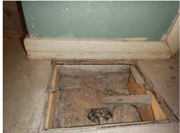
Kuva 5. Kellarin käytävällä A001 sijaitsevan maanvaraisen alapohjan sulkuventtiilikaivon rakenteiden kautta alapohjan maataytöstä on ilmayhteyksiä sisäilmaan. Lisäksi kaivossa on puurakenteita, jotka ovat alttiita kosteusvaurioille.
