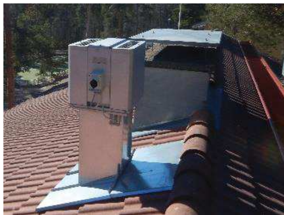
Kuva 200. Huippuimuri TK1-PF02 vesikatolla.
