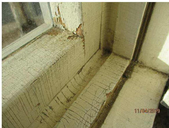
Kuva 81. Ikkunat ovat epätiivitä. Ikkunatiivisteet ovat paikoin irtoilleet. Ikkunatiivisteet ovat monin paikoin irronneet ja ikkunat ovat käynneiltään puutteellisia.
