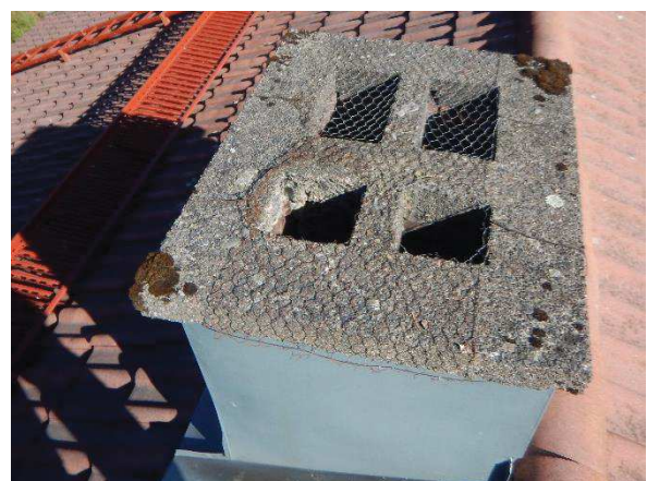
Kuva 186. Rikkoutunut hormin lintuverkko sekä teräskorroosio- ja rapautumavaurioita hormin betonirakenteissa. Hormissa ei ole sääsuojaa.
