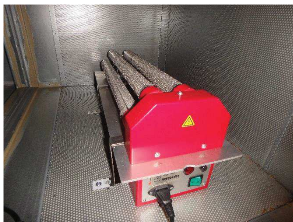
Kuva 209. Tuloilmakammioon asennettu Varionix-ioni-ionisaattori.
