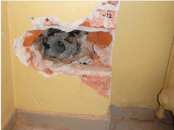
Kuva 59. Maanvastainen seinä on sisäpuolelta kosteus- ja lämmöneristetty betonirakenne. Sisäkuorimuurauksessa on halkeamia.
