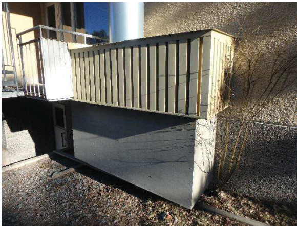
Kuva 202. Ilmanvaihtokoneen ulkoilmasäleikköä ei ole varustettu puhdistusluukulla.
