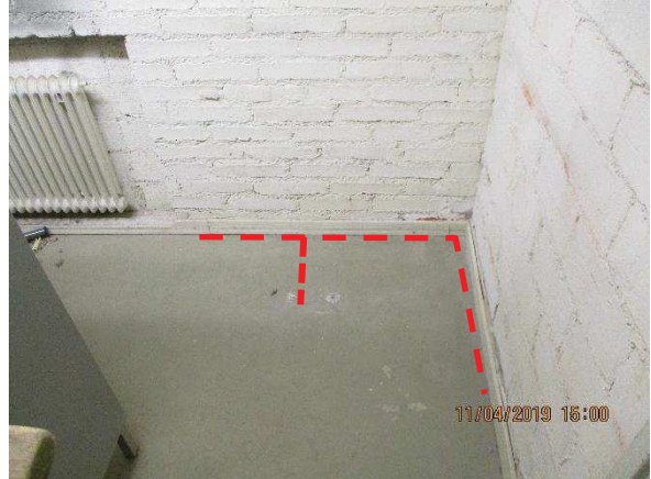
Kuva 40. Merkkiainekoe MAK2, maanvarainen lämmöneristämätön kaksoislaatta-alapohja, mankelihuone A007. Alapohjan maataytöstä havaittiin merkittävää ilmavuotoa maanvastaisten seinien liittymissä sekä alapohjalaatan halkeamakohtassa. Alapohjan seinäliittymässä on rako.
