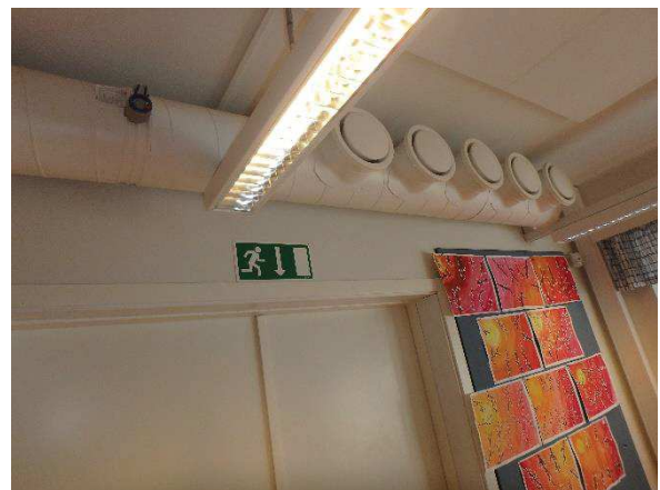
Kuva 213. Poistoilmaventtiilit ovat KSO-mallisia lautasventtiileitä.
