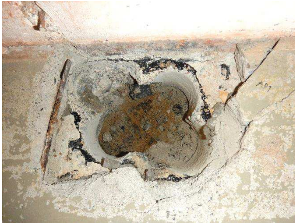
Kuva 19. Alapohjarakenteena on lämmöneristämätön kaksoisbetonilaatta. Alapohjalaatan maalipinnoite on lohkeillut irti. Alapohjan alapuolinen maa-aines on hiekkaista soraa, joka oli rakenneavauskohdalla kosteaa. Betonirauδοitteessa havaittiin korroosiota.
