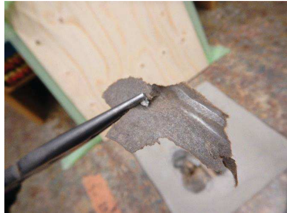
Kuva 133. Tervapaperista otetussa näytteessä havaittiin mikrobianalysissä heikkoja viitteitä mikrobi-vauriosta.
