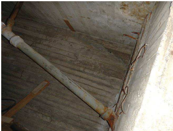
Kuva 14. Alapohjalaatan alapinnalla on mahdollisia vesi- tai viemärivuotoon viittaavia kosteusjälkiä.
