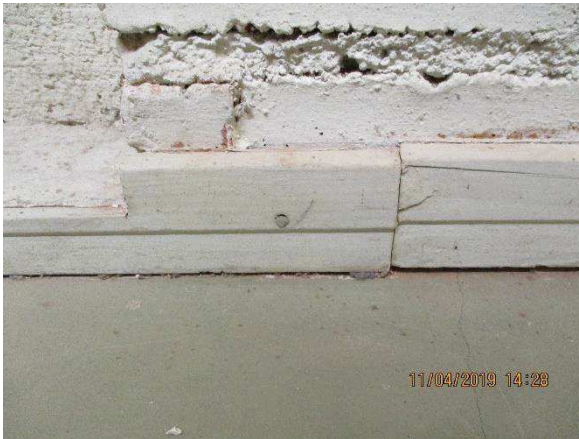
Kuva 66. Merkkiainekoe MAK5. Seinän sisäkuorten muuraussaumoissa on halkeamia ja reikiä ja seinän alapohjaliittymässä on rako. Epätiivelyskohdista havaittiin merkittävää ilmavuotoa sisäilmaan.
