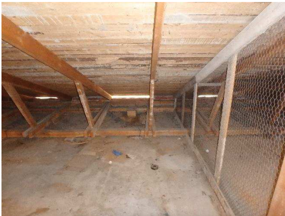
Kuva 171. Yleiskuva, yläpohjatila. Yläpohjatilan tuuletus on toteutettu räystäällä sijaitsevien tuuletusrakojen avulla. Yläpohjalaatan pinnalla on kosteusjälkiä.
