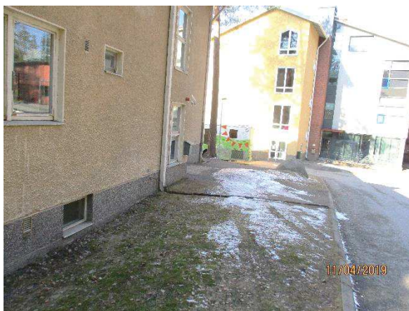
Kuva 195. Maanpintojen kallistukset rakennuksesta poispäin ovat vähäisiä. Paikoin maanpinta on hyvin lähellä ikkunoiden alareunoja.
