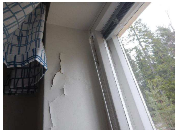
Kuva 76. Seinien sisäpuoliset maalipinnoitteet lehteile- vät paikoin irti todennäköisesti kosteusrasituksen vai- kutuksesta. Kuva luokan A107 ikkunasmyygistä raken- nuksen ulkonurkan lähistöltä.
