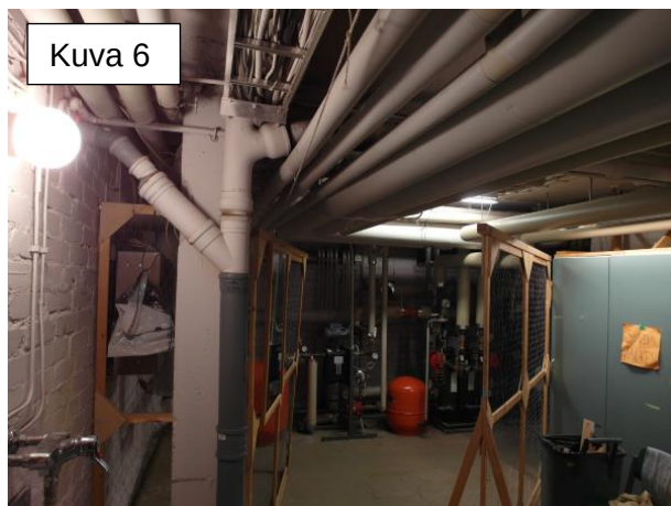
Kuva 6. Lämmönjakohuoneen seinien ja mahdollisesti myös katon maali/tasoite sisältää asbestia. Saattaa olla myös viereisessä kerhohuoneessa, joka on aiemmin ollut polttoainevarastotilana.
