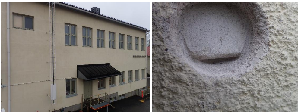
Kuva 16. Pohjoisjulkisivu. Tarkastuspisteessä RA05 havaittiin kahitiiltä rappauksen taustalla.
