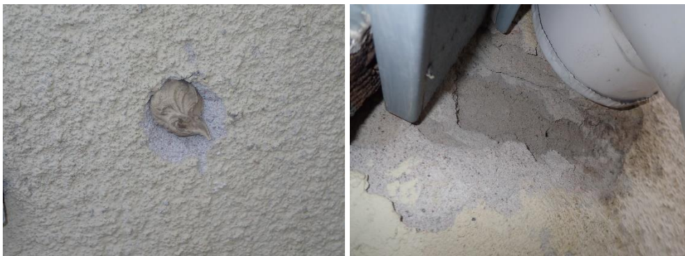
Kuva 15. Itäjulkisivu. Massalla paikattu teline/töyrymanostimen kiinnityskohta. Sadevesikouru vuotaa julkisivulle, josta on rappaus irronnut.
