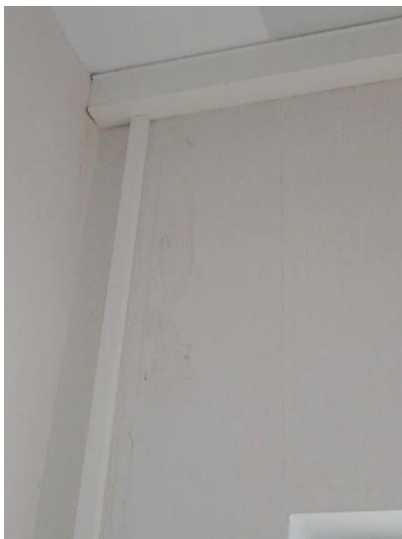
Kuva 11. Vanha kosteusjälki monistutilassa 110.
