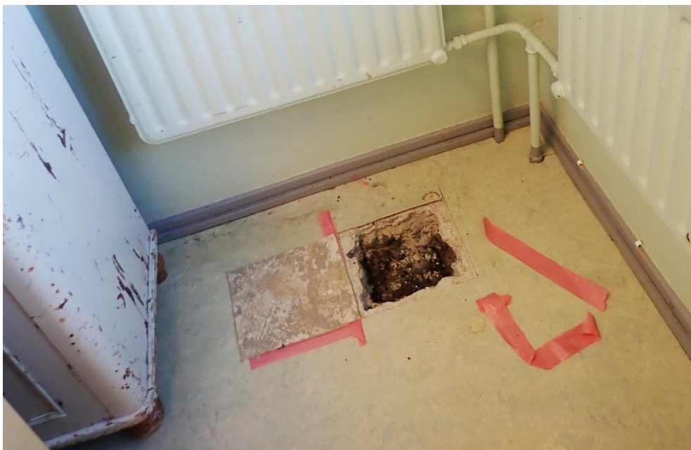
Kuva 8. Luokka 004, kaksoislaattarakenteisen alapohjan pintalaatan lävistää mm. lämpöpatteriputket. Pintalaatan liittymiä ulkoseiniin ei ole toteutettu ilmatiiviisti.
