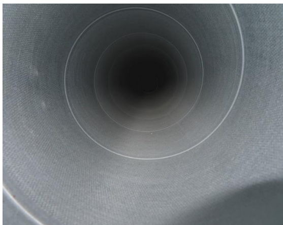
Kuva 34. Luokan 004 tuloilmakanava, jonka sisäpinnan pölykertymäarvio oli alle 1 \text{ g/m}^2 (arviointipiste KP1).
