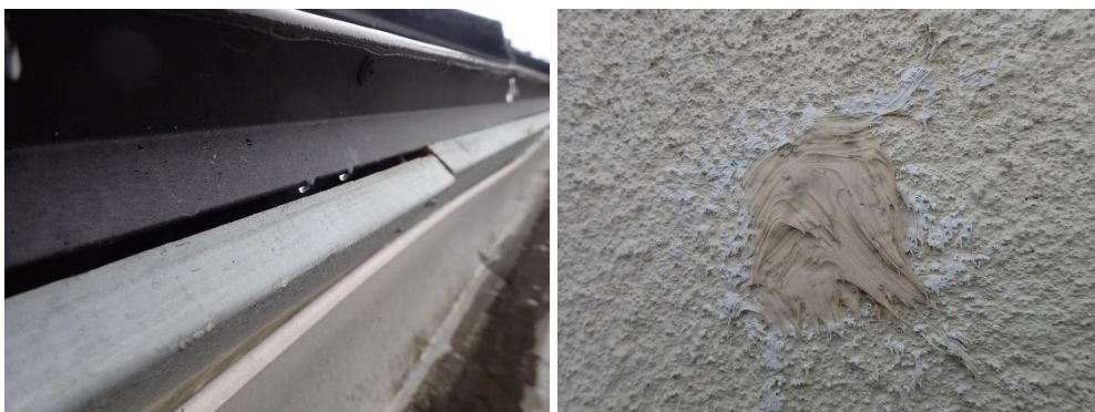
Kuva 17. Pohjoisjulkisivu. Räystäslauta irstää ja samalla sadevesikouru roikkuu. Telineiden/työmaanostimen kiinnityskohtia on paikattu massalla.
