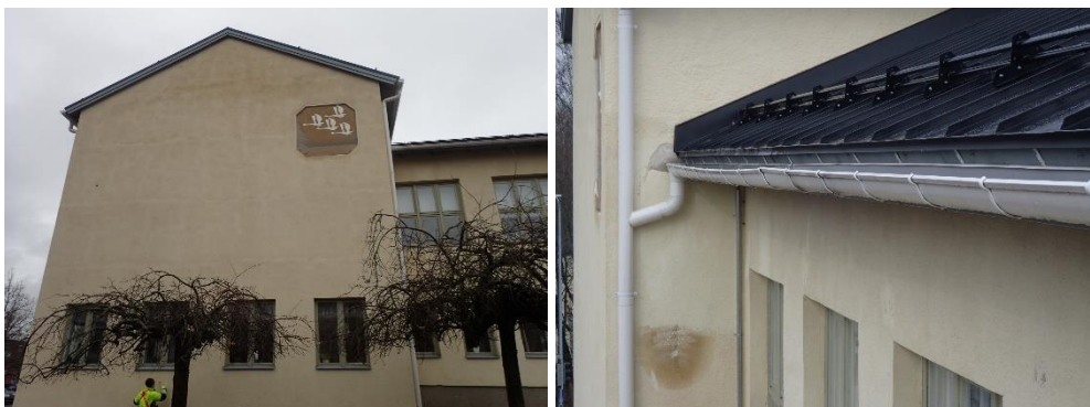
Kuva 18. Länsijulkisivu. Seinän yläosassa on lievää värieroaa rappauksen maalissa. Sadevesikouru vuotaa seinälle ja rappaus on osittain tältä kohdin irronnut.
