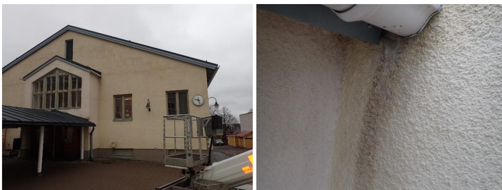
Kuva 14. Eteläjulkisivu. Sadevesikouru vuotaa julkisivulle.
