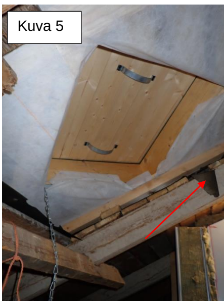
Kuva 5. Vesikaton vanha kermi sisältää asbestia ja yli 200 mg/kg PAH-yhdisteitä.
