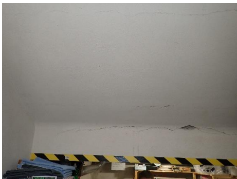
Kuva 23. Halkeamia tilan 028 väliseinän ja katon iittyessä
