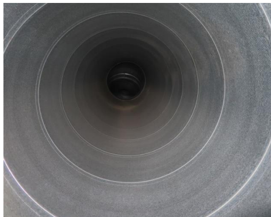
Kuva 35. Luokan 108 tuloilmakanava, jonka sisäpinnan pölykertymäarvio oli alle 1 \text{ g/m}^2 (arviointipiste KP2).
