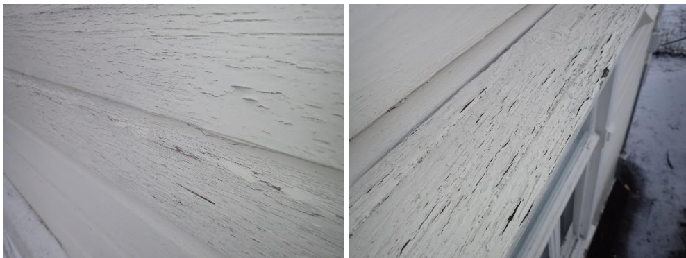
Kuva 18. Julkisivun maalipinta hilseilee monin paikoin.
