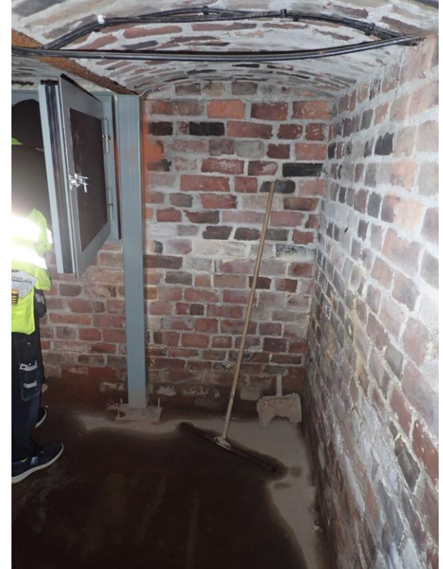
Kellaritilan lattialle kertyy vettä.
