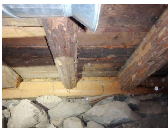
Kuva 6. Tuulettuvan alapohjan alapinnan laudoituksessa on tummentumia, mutta aluslaudoitus on nykyään kuiva. Luonnonkiviperustuksissa ei todettu sortumia.
