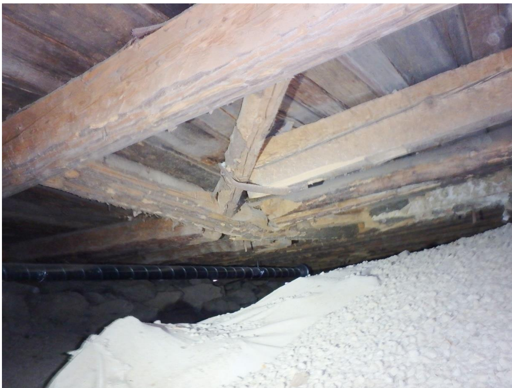
Kuva 10. Monitoimitilan kohdalla on alapohjan kannatinpuiden poikkipuu romahtanut. Lattiaa on em. alueella aiemmin korjattu. Alue on merkitty liitteeseen 3.0
