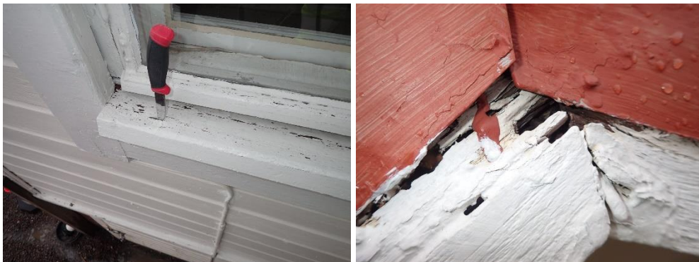
Kuva 17. Ikkunoiden vaakalaudat ja räystäiden otsalaudat ovat pehmenneet kosteuden vaikutuksesta.
