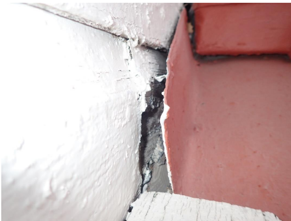
Kuvat 27 ja 28. Pellitysten saumat julkisivupintoihin rakoilevat
