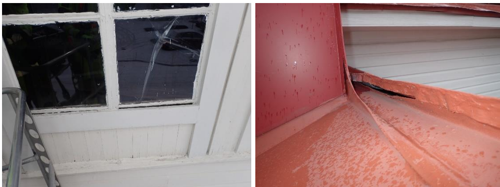
Kuva 19. Yksi ikkunaruuu oli rikki. Sisäänkäynnin peltikaton harjan sauma on auki.
