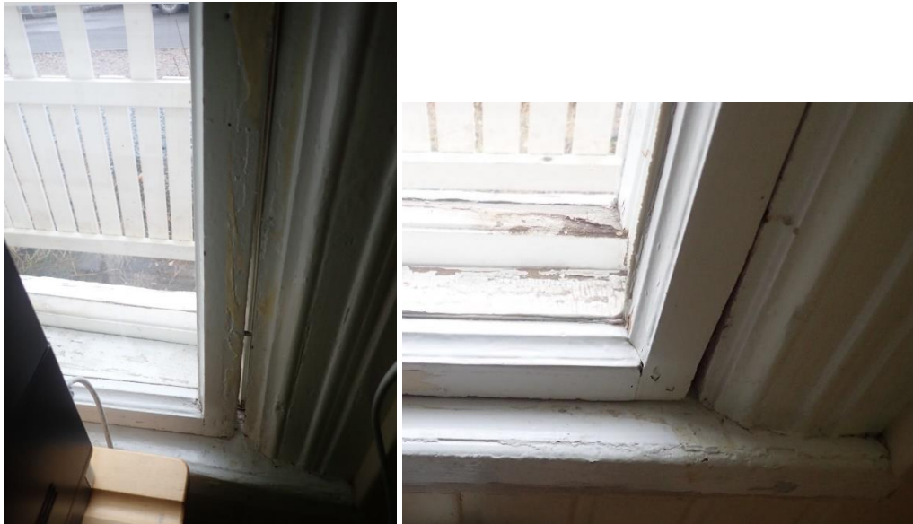
Kuvat 12 ja 13. Sisäpuutteen ja karmin välissä on paikoin isoja rakoja.
