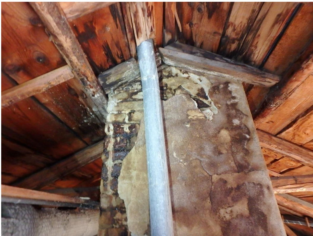
Kuva 29. Yläpohjatilasta katselmoituna piippua pitkin on valunut vettä yläpohjatilaa.
