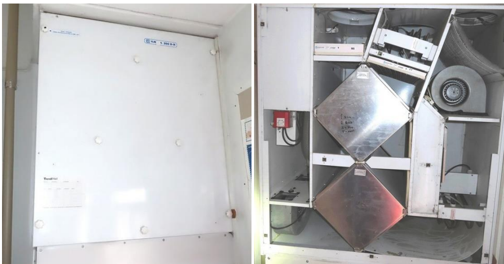
Kuva 30. Ilmanvaihtokone Ilmava 250 D-R. Oikealla näkymä koneen sisään.
