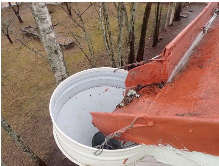
Kuva 26. Sadevesiputkien yläosien suppiloita on kiinnitetty teräslangoilla peltikatteen sadevesiohjaimeen.
