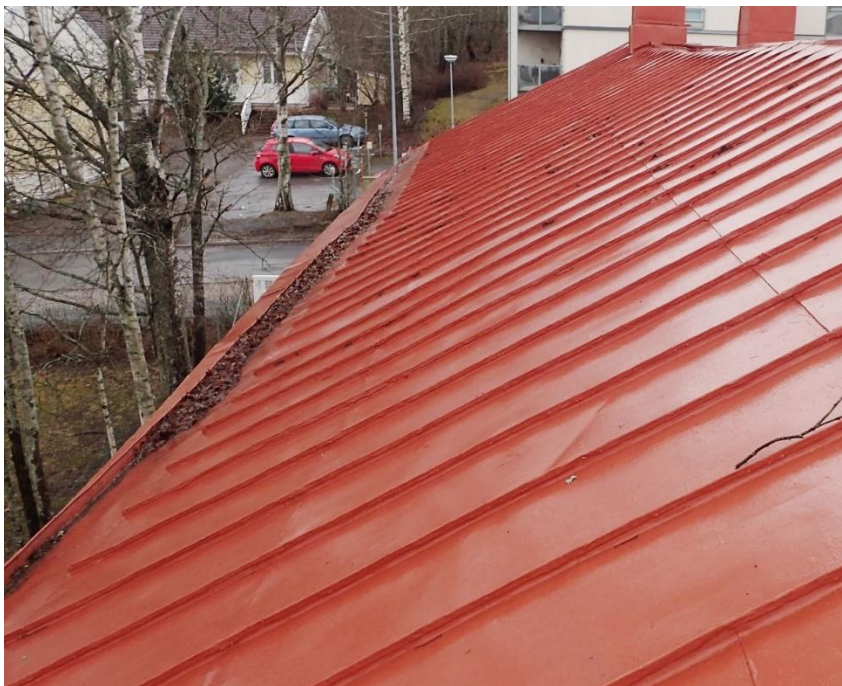
Kuva 25. Monitoimiopetustilan viereisten huoneiden kohdalla on sadevesikouruun kertynyt runsaasti neulasia.
