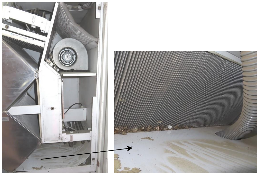
Kuva 31. Tuloilmapuolella oli näkyvää pölyä kotelon pohjalla ennen lämmöntalteenottolaitetta. Tuloilmapuolella lämmöntalteenottolaitteessa oli hyönteisjäämiä. Konekotelossa ei ole mineraalivillaa.
