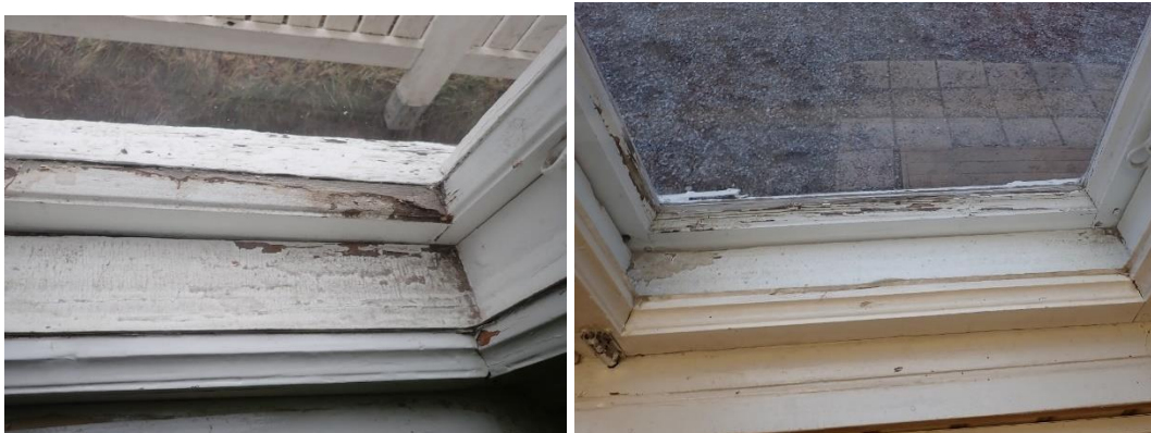
Kuvat 14 ja 15. Ulkopuitteessa ja välikarmissa on kosteusjälkiä ja maalipinta on lohkeillut.
