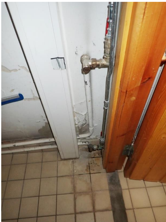
Kuva 5. Tyttöjen wc-tilojen vieressä siivouskomerossa vesiputken liitos vuotaa.
