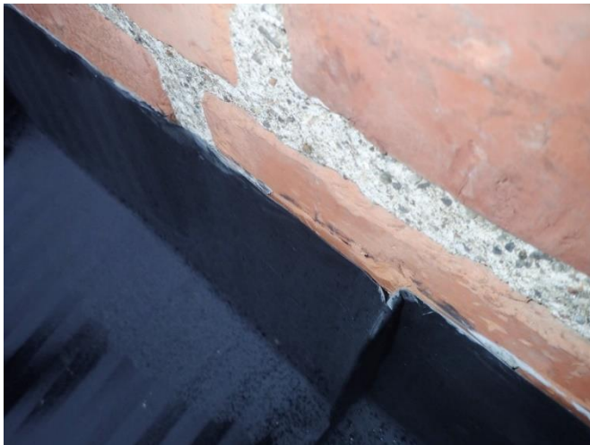
Kuvat 10 ja 11. Vesikatteen ylösnostot tiiliseinää vasten rakoilevat.
