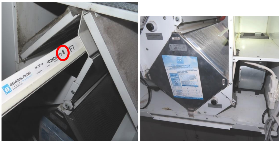
Kuva 16. Vasemmalla tuloilmasuodatin, joka oli asennettu väärin päin kehyksessä olevan virtausnuolen perusteella. Yleisesti kotelon sisäpintojen pölyn määrä oli vähäinen, sisäpinnoilla ei ollut mineraalivillaa.
