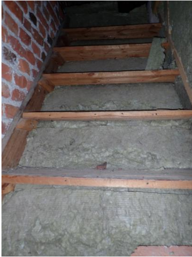
Portaissa näkyvillä mineraalivillaa
