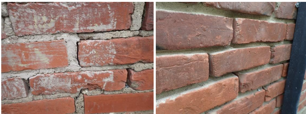
Kuva 7. Tiilissä on havaittavissa lievää rapautumista. Saumat ovat paikoin kuluneet ja rapautuneet n. 10-20mm syvyydeltä.
