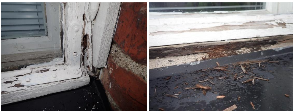
Kuva 8. Ikkunoiden puurakenteet ovat pehmenneet kosteudesta. Alapuolinen apukarmi on kastunut ja lahonnut.
