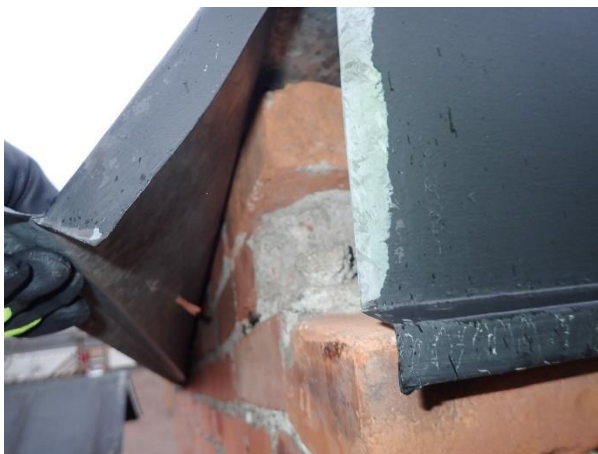
Kuvat 12, 13 ja 14. Rästäspellitysten saumaukset ovat paikoin auki. Vesikatepinta on tiivis.
