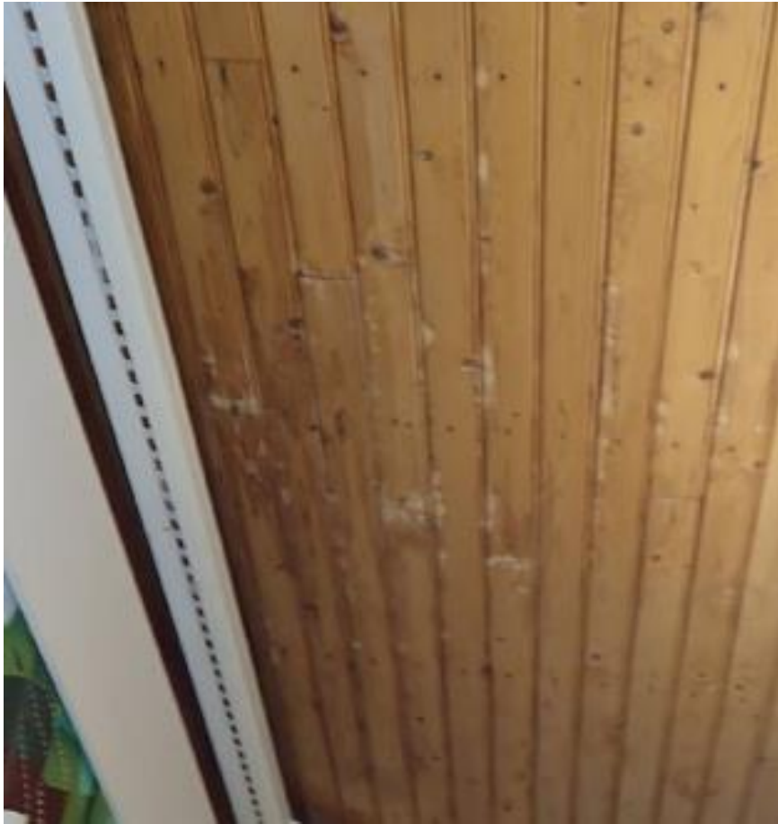
Kuva 24. Paneelikatossa kosteusjälkiä tilassa 110.
