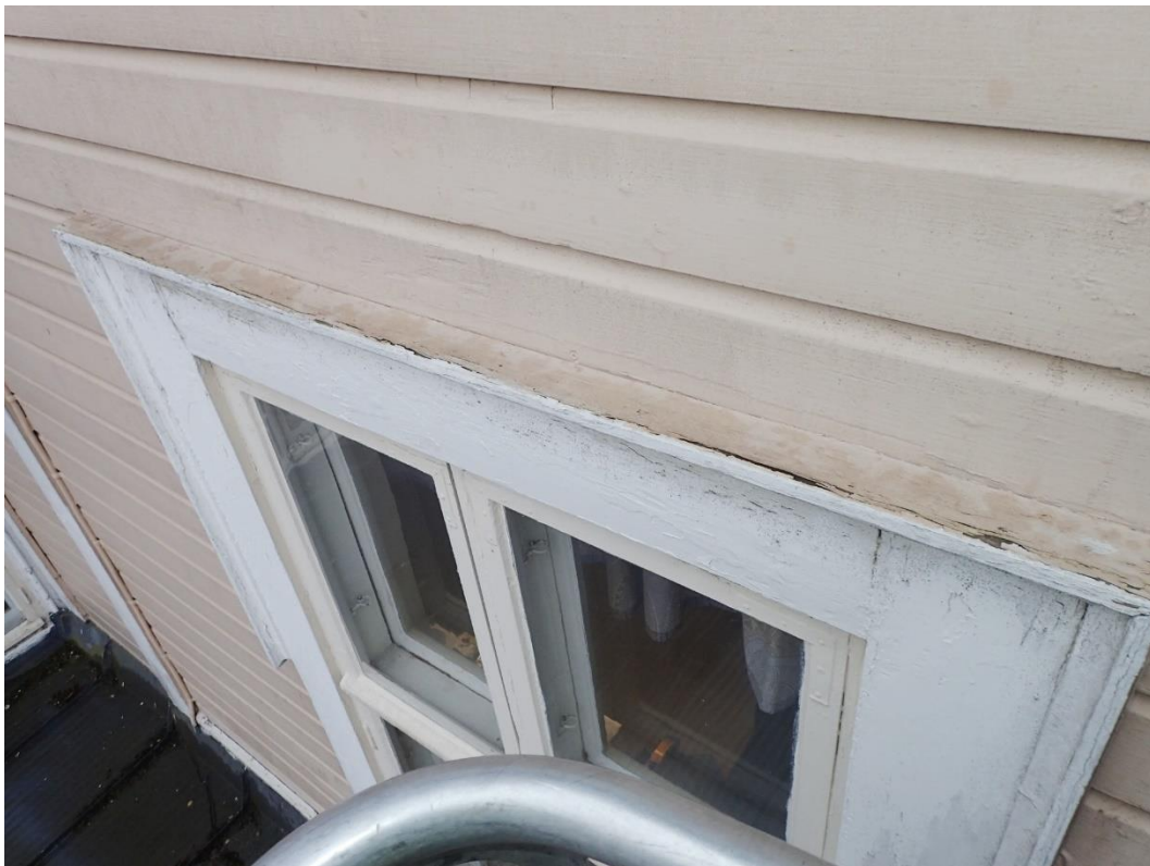
Kuva 21. Ikkunat ovat julkisivupinnassa, eikä ikkunan päällä ole räystääspellityksiä, jotka vähentäisivät ikkunoiden puuosiin kohdistuvaa vesirasitusta.
