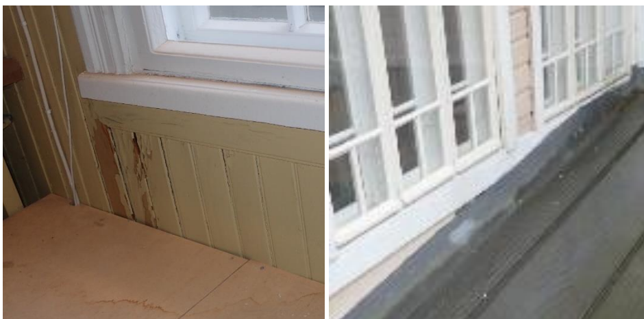
Kuvat 13 ja 14. Käytävällä 102 ulkoseinässä havaittiin pinnoitevaurioita. Samassa kohtaa on ulkopuolella rako pellityksen ja ulkoverhouksen liittymässä.
