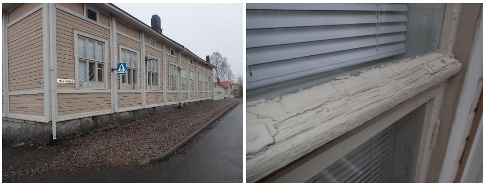
Kuvat 15 ja 16. Puukoulun julkisivu. Ikkunoiden puitteissa lieviä kosteuden aiheuttamia jälkiä.
