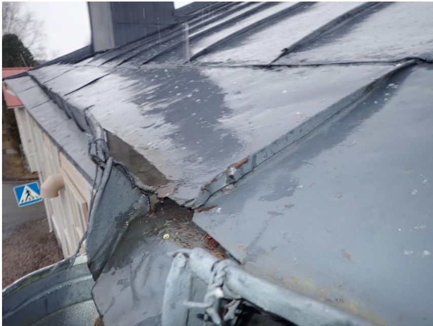
Kuva 27. Sadeveden ohjauksen kouru on matala. Kattopeltien saumoissa on ruostetta.
