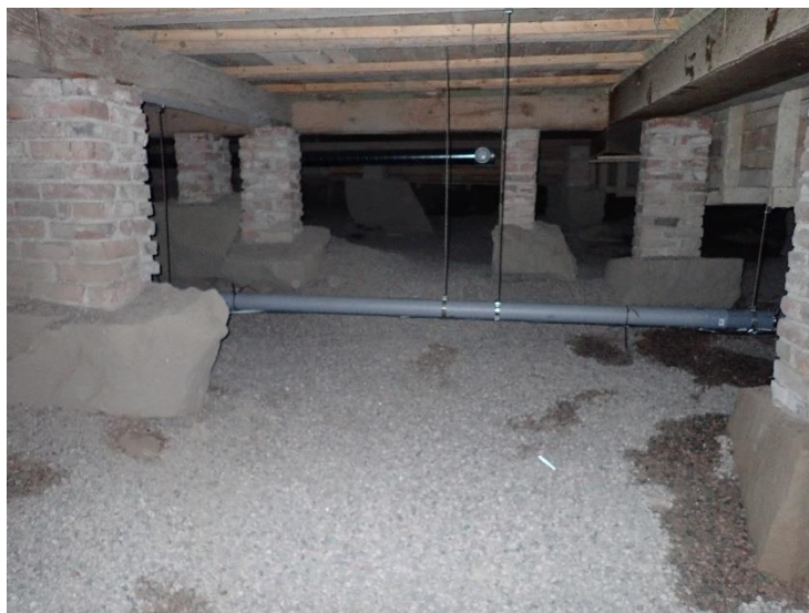
Kuva 6. Alustatilan sorapeitteen päällä on paikoin kosteita alueita
