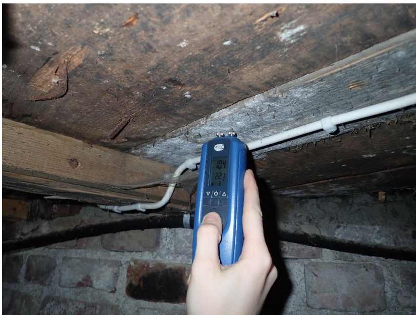
Kuva 7. Tuulettuvan alapohjan alapinnan laudoituksessa on tummentumia, mutta aluslaudoitus on nykyään kuiva.
