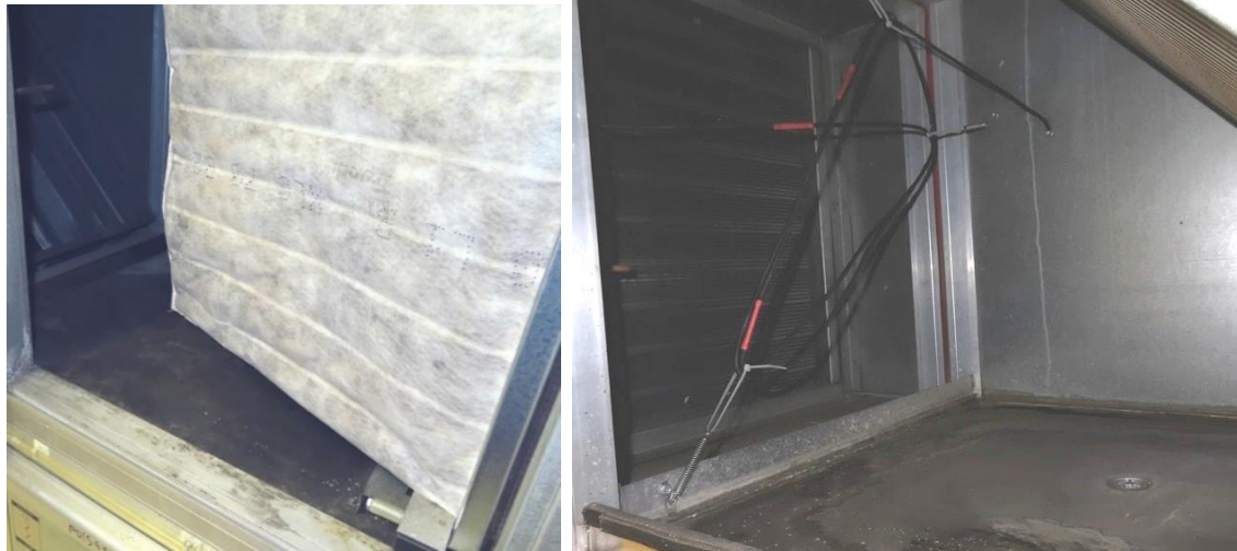
Kuva 30. Näkymiä tuloilmapuolelle. Vasemmalla on M6-tasoinen tuloilmasuodatin, jonka kehys oli tiivis. Oikealla levylämmöntalteenottolaitteen pohja ja lämmityspatteri.
