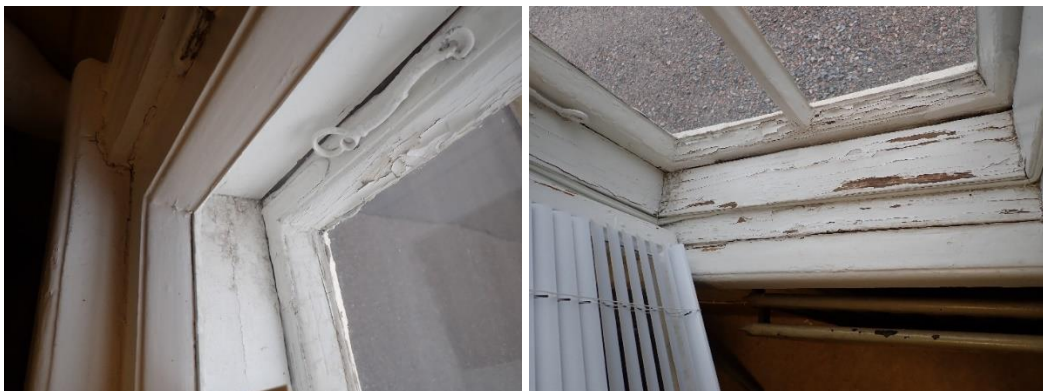
Kuvat 11 ja 12. Tilat 108 ja 110. Sisäpuolen ikkunapenkissä ja karmeissa on paikoin halkeamia. Ikkunapuitteiden ja karmien maalipinta hilseilee.
