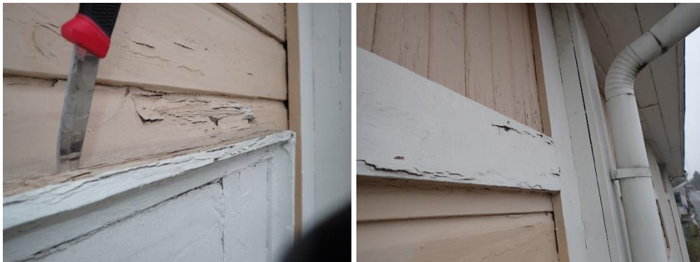
Kuvat 19 ja 20. Julkisivun maalipinta hilseilee paikoin.
