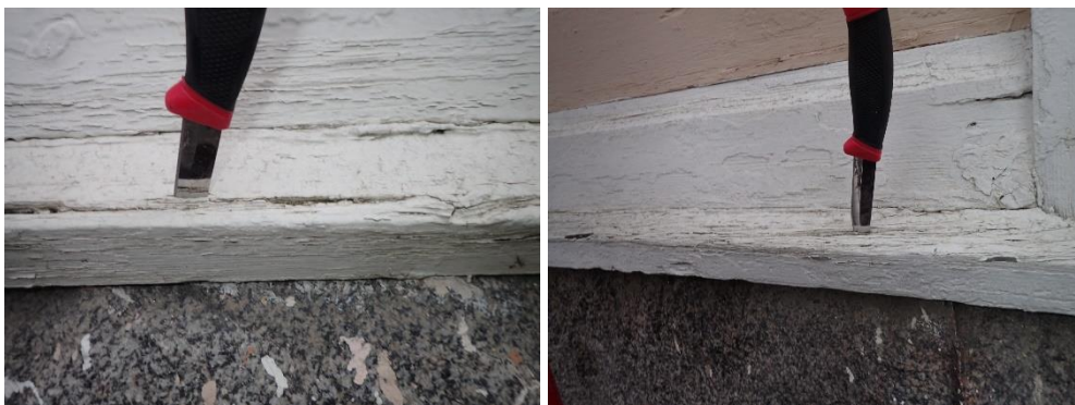
Kuvat 17 ja 18. Sokkelin päällä olevat puulaudat olivat monin paikoin pehmenneet kosteuden vaikutuksesta.
