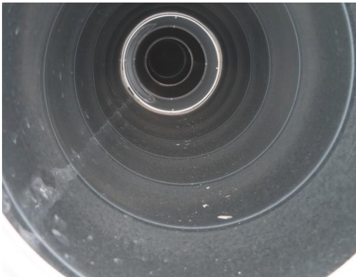
Kuva 31. Luokan 110 tuloilmakanava, jonka sisäpinnan pölykertymäarvio oli 1-2 g/m 2 (arviointipiste KP1).
