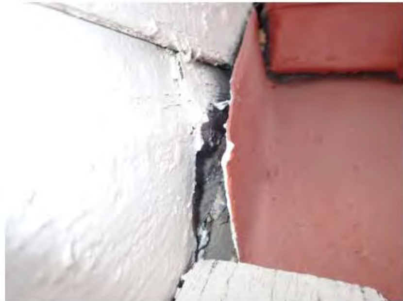
Kuvat 27 ja 28. Pellitysten saumat julkisivupintoihin rakoilevat
