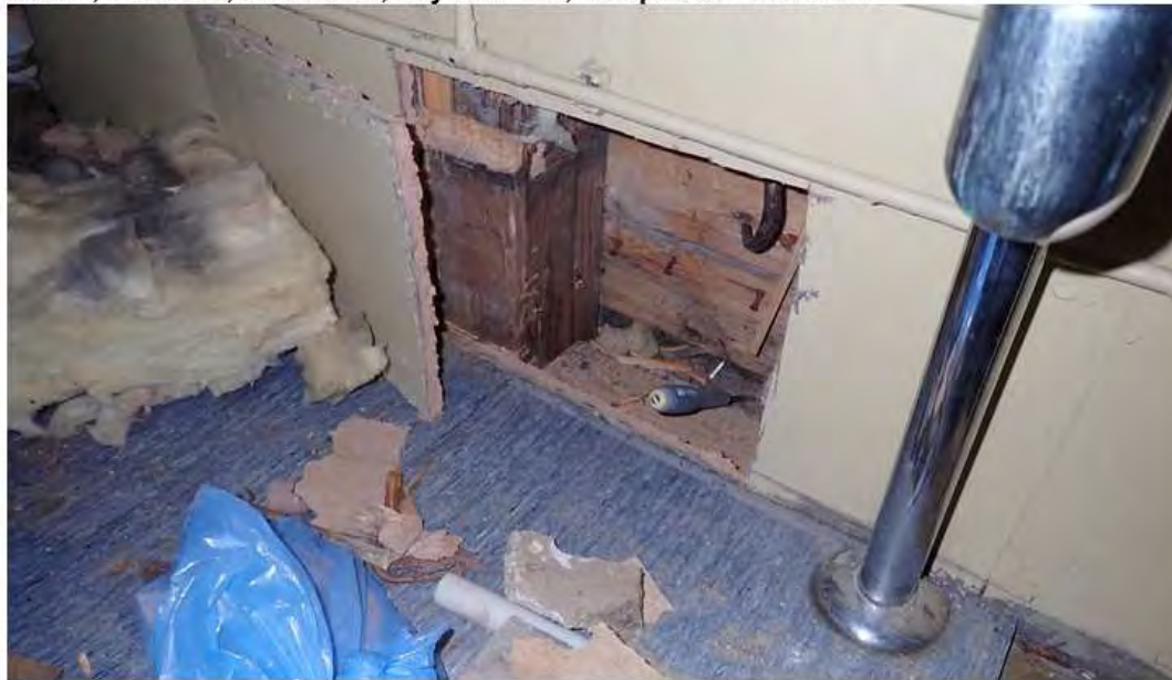
RA37 , 1-kerros, ulkoseinä, käytävä 102, vesipisteen kohdalla
