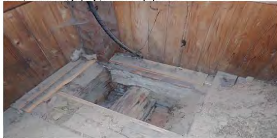
RA39 , ullakko U01, yläpohja, luokan 111 yläpuolella
