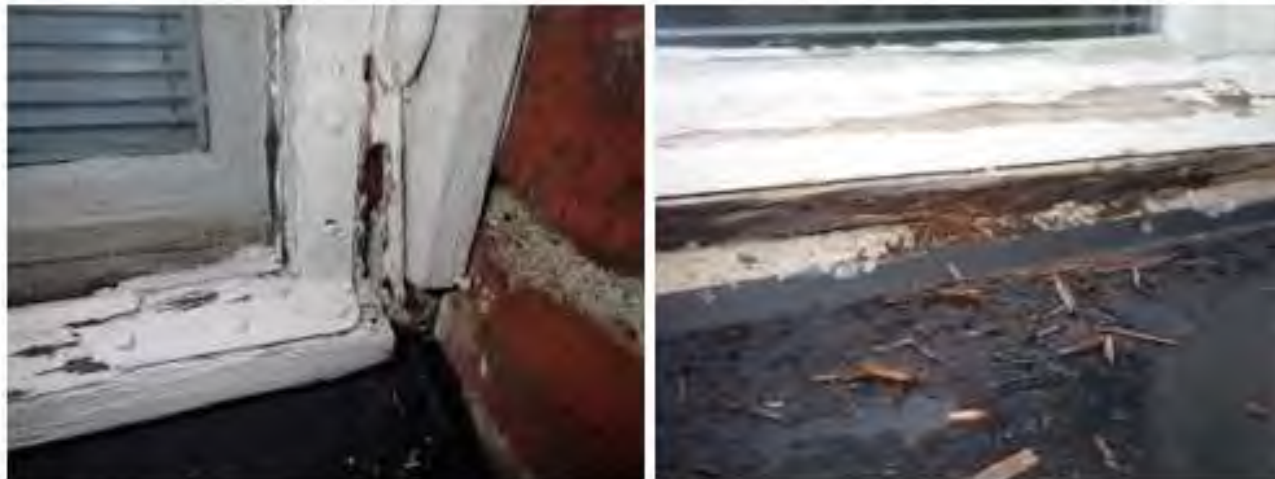
Kuva 8. Ikkunoiden puurakenteet ovat pehmenneet kosteudesta. Alapuolinen apukarmi on kastunut ja lahonnut.
