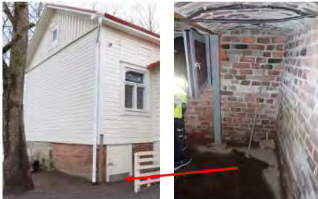
Kuva 5. Kellarin kohdalla on tiilimuuratut perusmuurirakenteet. Ulko-ovesta ohjautuu vettä kellarin sisälle ja vesi lätköityy kellarin lattialle.
