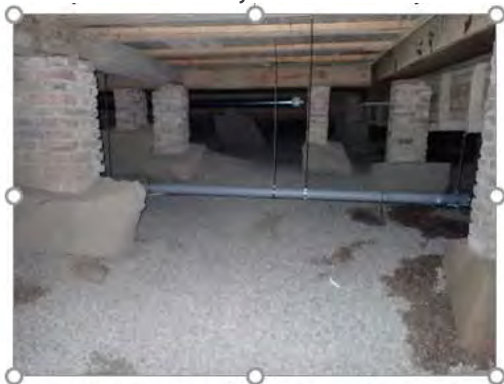
Kuva 6. Alustatilan sorapeitteen päällä on paikoin kosteita alueita
