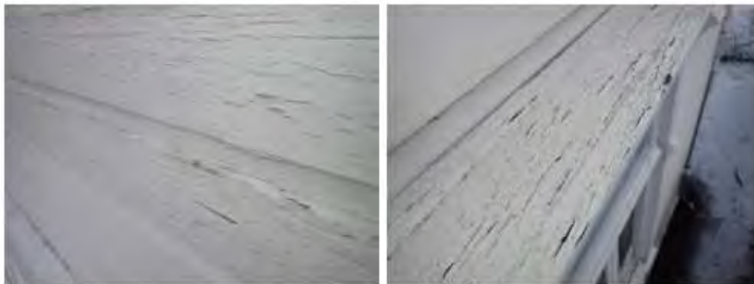
Kuva 18. Julkisivun maalipinta hilseilee monin paikoin.
