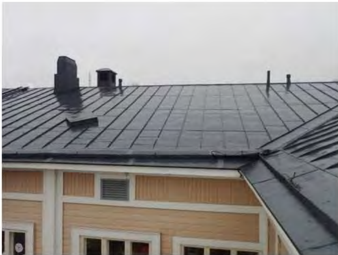
Kuva 28. Sadevesikourussa on lämmityskaapeli. Rakennuksessa ei ole lumiesteitä.
