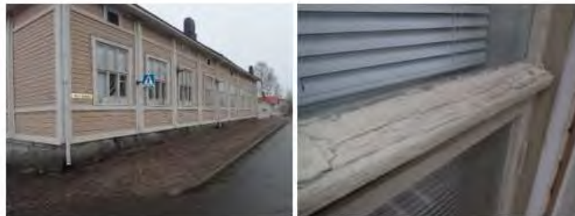
Kuvat 15 ja 16. Puukoulun julkisivu. Ikkunoiden puitteissa lieviä kosteuden aiheuttamia jälkiä.
