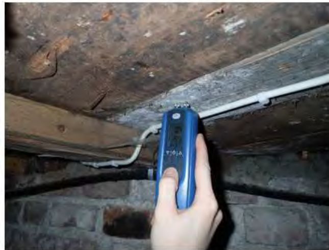
Kuva 7. Tuulettuvan alapohjan alapinnan laudoituksessa on tummentumia, mutta aluslaudoitus on nykyään kuiva.
