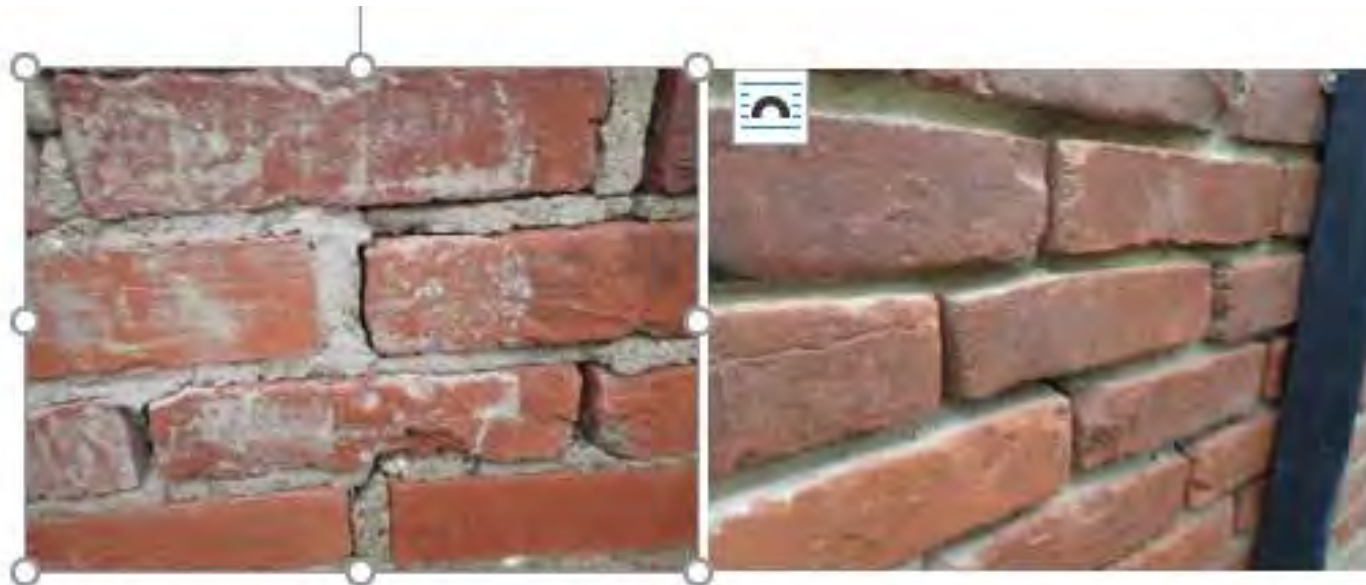
Kuva 7. Tiilissä on havaittavissa lievää rapautumista. Saumat ovat paikoin kuluneet ja rapautuneet n. 10-20mm syvyydeltä.
