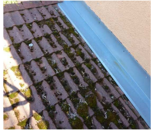
Kuva 33. D- ja E-osan vesikatteet ovat sammal- kasvun lisäksi nokeentuneet.
