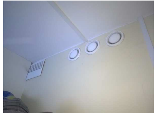
Kuva vv. Huoneen 119 väliseinän toisella puolella on tuloilmaventtiilin puolikas ja kaikki poistoilmaventtiilit..
