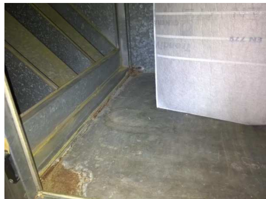
Kuva y. Suodatinkammion lattia on likainen.
