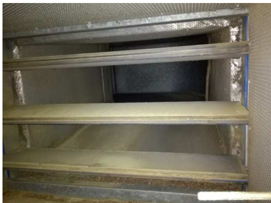
Kuva x. Ulkoilmakammion pinnat ja luukut ovat likaiset.
