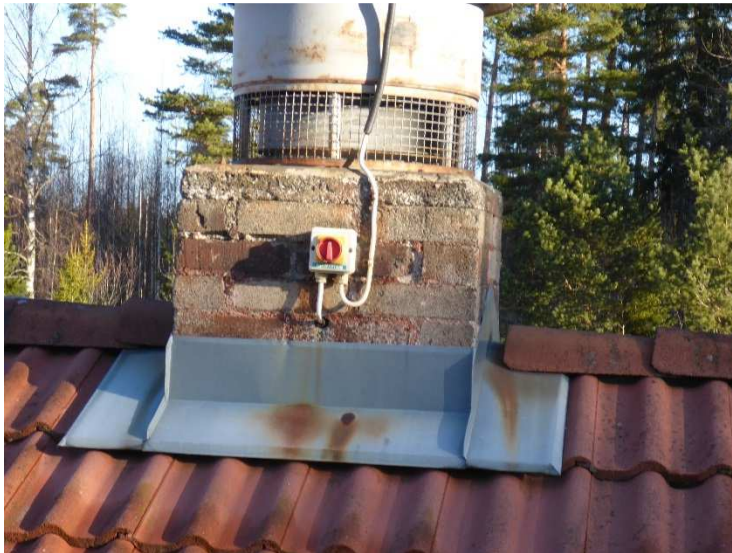
Kuva 34. E-osassa olevan muuratun piipun juuripellitys on epätiivis. Vuotojen estämiseksi se tulisi pellittää ylhäältä saakka
