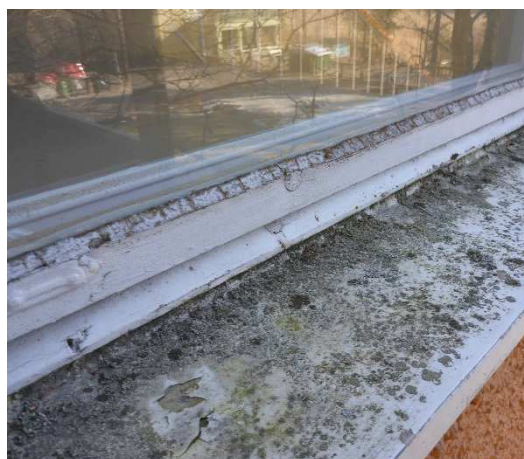
Kuva 21. Ikkunarakenteiden kunto on kaikkialla peruskunnostuksen tarpeessa. Puuosat ovat vielä kovat, mutta kitit ja vedeneristerakenteet pehmentyneitä.
