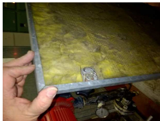
Kuva y. Suodatinkammion luukun sisäpinnassa on rikkoontunutta mineraalivillaa.
