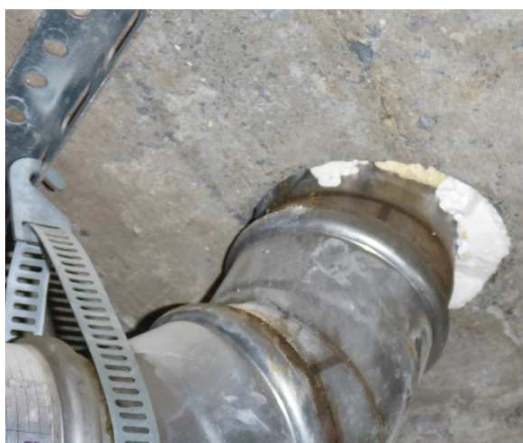
Kuva 6. Läpiviennit ovat epätiivit ja vuotavat ilmaa rakennuksen sisätiloihin
