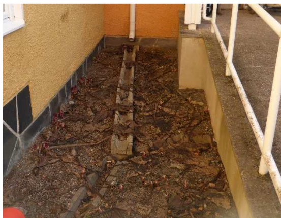
Kuva 2. Betonikourulla hoidettu kattovesien poistoreitti. Lärjestelmä on tukossa ja osan matkaa myös jäässä
