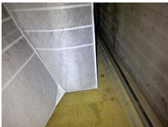
Kuva x. Suodatinkammion pinnat ovat mineraalivillaa ja likaiset.
