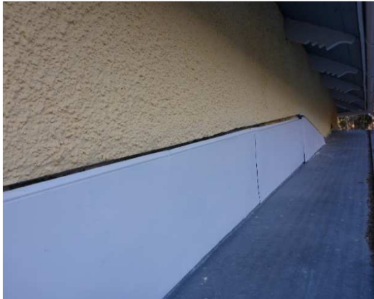
Kuva 12. Seinään liittyvän alemman vesikatteen nostopellityksestä puuttuu rappausten ja pellin liittymäalueelta massa.
