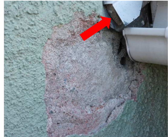
Kuva 15. Vastaavanlainen vesirännin ja pellityksen liitosongelma. Pelti johtaa edelleen veden seinälle (nuoli).
