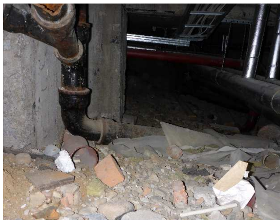
Kuva 5. Tilaan on putkieristeiden vaihdon yhteydessä jäänyt eristekappaleita ja myös vapaata asbestia
