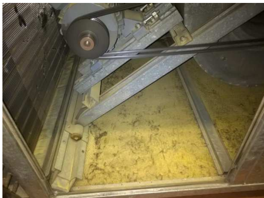
Kuva z. Puhallinkammion lattia on mineraalivillaa.
