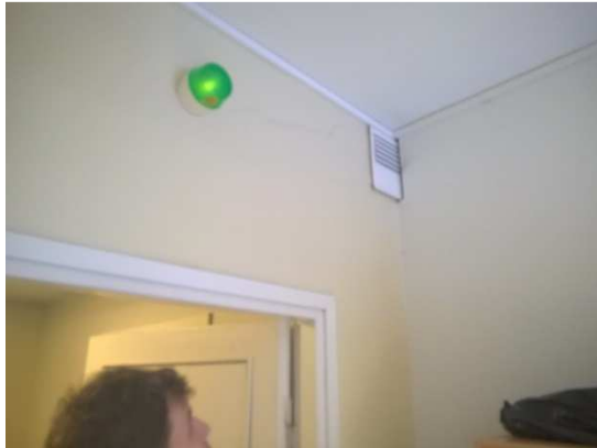
Kuva zz. Huoneessa 119 on tuloilmaventtiilin puolikas.
