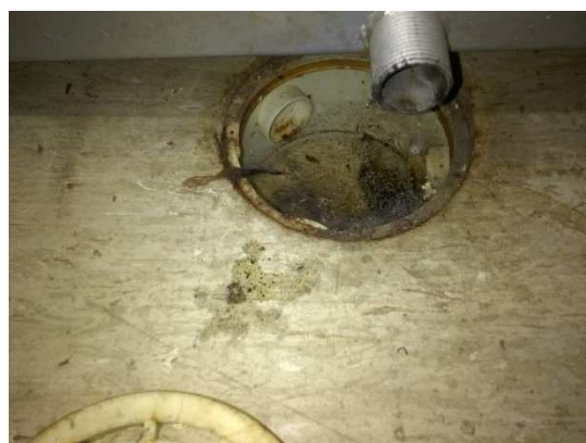
Kuva yyy. Iv-konehuoneessa on likainen kuivakaivo.
