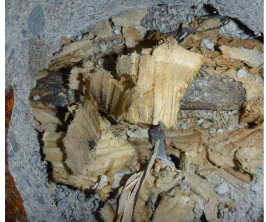
Kuva 25. Rakennetyypin 2 mukainen välipohja. Mineraalivilla ja sen päällä oleva rakennuskartonki tuoksuvoimakkaasti maakellarille.
