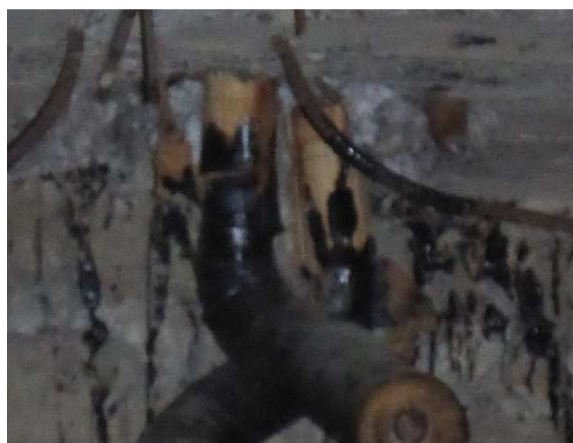
Kuva 7. Alapohjan läpivienneistä osa on käsitelty PAH-pitoisella bitumiliuksella. Silti ilmapuoto sisäänpäin on runsasta.
