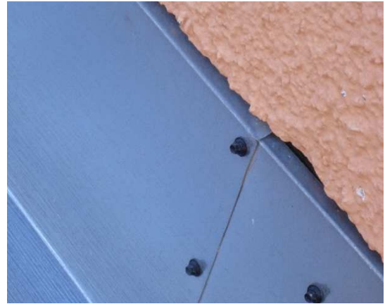
Kuva 13. Vastaavanlainen ongelma on D ja E osan liittymässä
