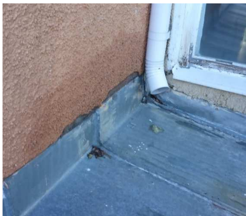
Kuva 16. Yläkaton vesien juoksumus alemmalle katolle on aiheuttanut syöksytorven roiskumisen seurauksena rappauspinnan kastumisen
