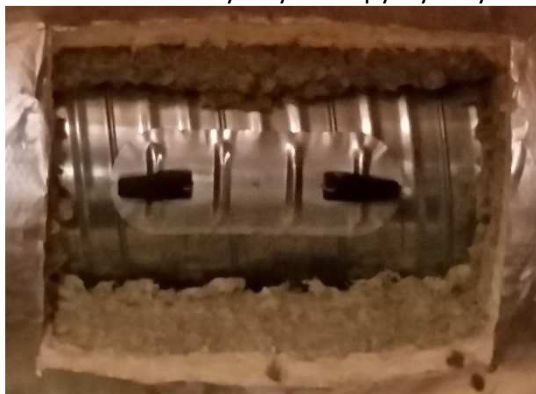
Kuva 30. Huoltoluukun avaamisen yhteydessä mineraalivillaa voi päästä tuloilmakanaviin.
