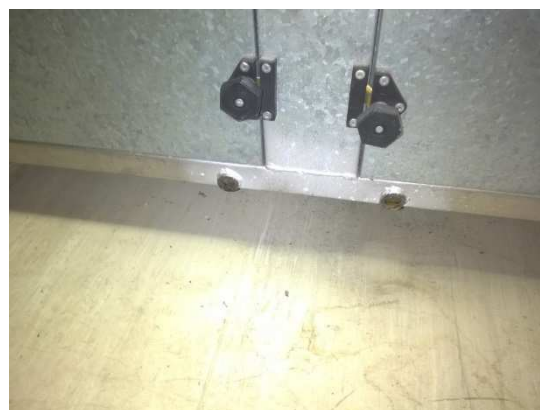
Kuva xx. LTO-kammioiden viemärointi ei toimi. Avoimet putken päät ovat näkyvissä.
