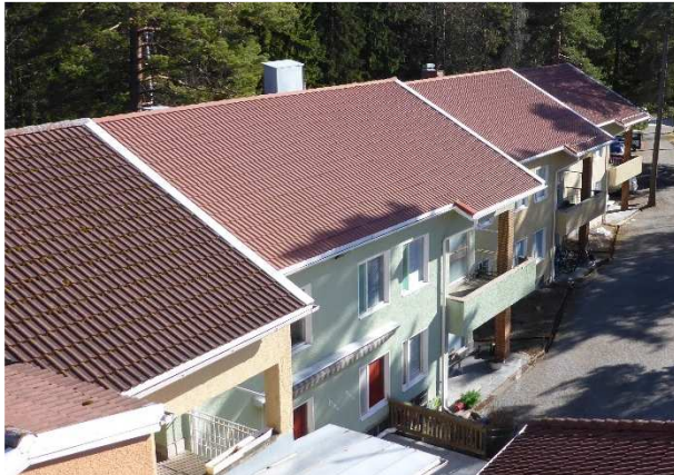
Kuva 32. A-osan kate on puhdas ja ehjä rakennuksen länsipuolelta, mutta itäpuoli on sammaloitunut
