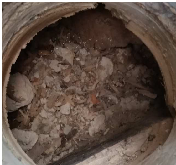
Kuva 26. Rakennearvauksen yhteydessä maakellarimainen haju oli usean reiän osalta voimakasta. Osasyynä hajuun ovat lahovaurioituneet puutavarat.
