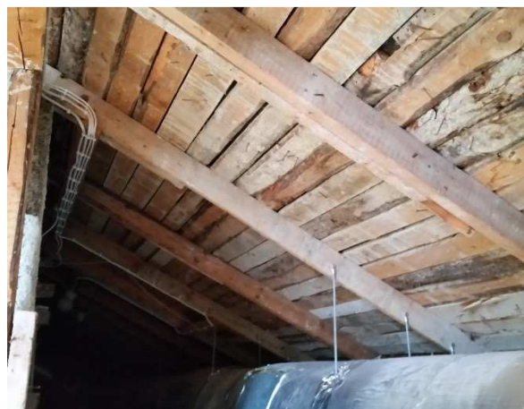
Kuva 29. Vesikate on uusittu kaikkien siipien osalta, mutta aluslaudoitusta ei ole samassa yhteydessä vahdettu. Miksi-köhän?
