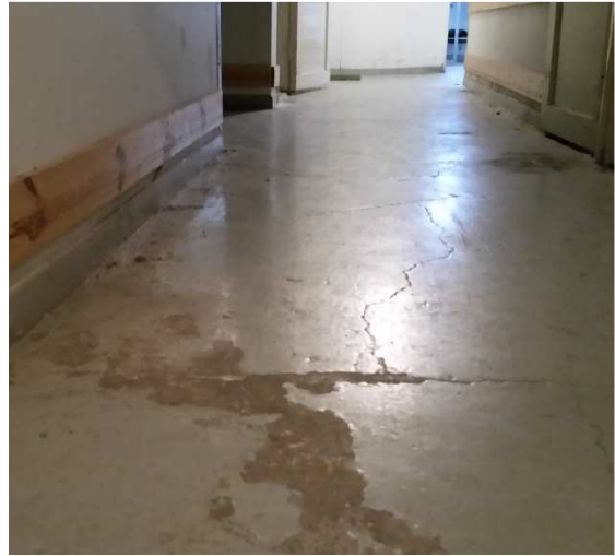
Kuva 9. Maanvaraisissa lattioissa on kuivumiskutistumasta johtuvaa halkeilua. Tutkimuksen perusteella se ei ulotu maaperään saakka
