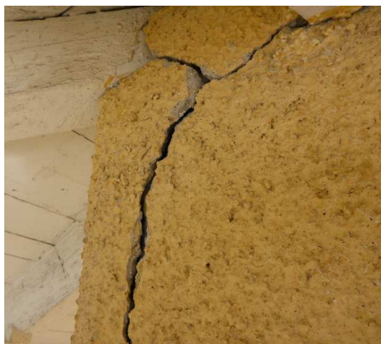
Kuva 19. Yläpohjan vesikatteen liittymän ja seinärungossa räystäään korkeudella on paikoitellen halkeilua
