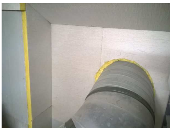
Kuva xxx. Iv-konehuoneen seinät ovat pinnoitettua mineraalivillaa. Paljasta villaa on kuitenkin esillä.
