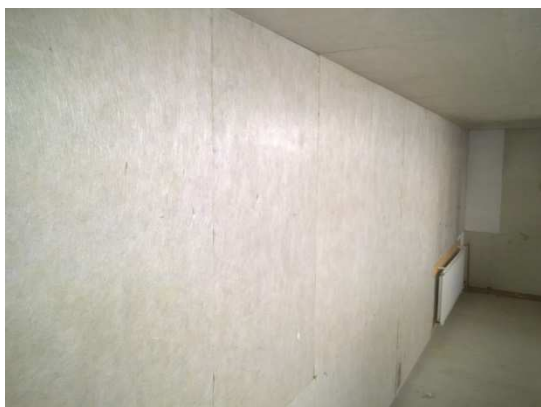
Kuva yy. Iv-konehuoneen seinät ovat pinnoitettua mineraalivillaa.
