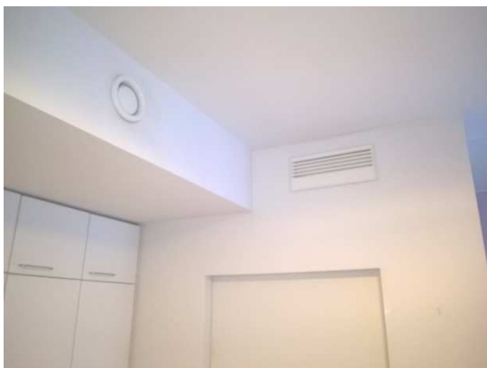
Kuva xx. Huoneessa 209 tuloilmaventtiilistä kulkeutuu tuloilmaa suoraan poistoilmaventtiin.
