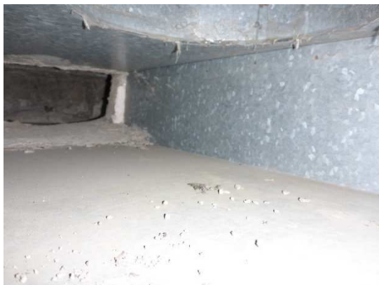
Kuva yy. E-rakennuksen tuloilmakanavissa on runsaasti kiviainespölyä.
