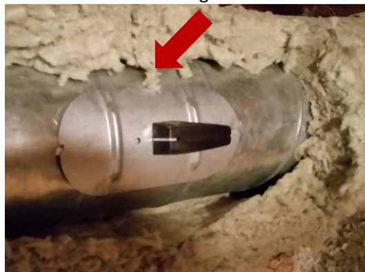
Kuva 31. Vastaavanlainen huoltoluukku, jossa on kuituongelma: Mineraalivilla on jäänyt huollon yhteydessä luukun väliin (nuoli)
