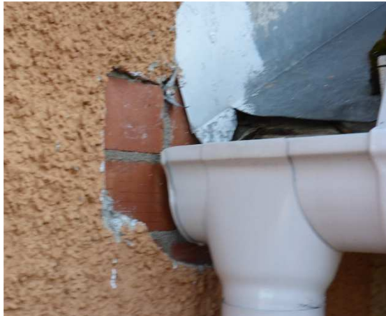
Kuva 14. Vesirännin pääty on vuotanut ennen rännien vaihtamista uusiin. Myös nostopellityksessä on ollut puutteita, koska vesi on ohjautunut pelliltä seinään.
