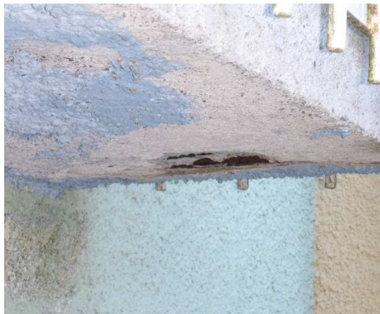
Kuva 23. Rappaus ja maali ovat irronneet parvekkeen alaosaan, mutta läpi työntyvästä kosteudesta ei ole merkkejä. Vedeneriste toimii toistaiseksi vielä hyvin.
