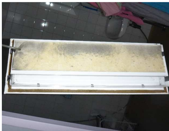
Kuva 35. Pääte-elinten äänenvaimentimissa on runsaasti irtolikaa. Viimeistään nyt puhdistus on ajankohdainen.
