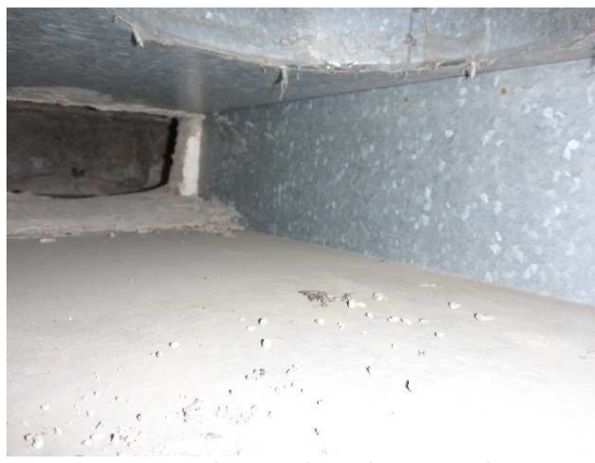
Kuva 36. IV-järjestelmässä olevaa kiviainespölyä on runsaasti E-rakennuksen kanavissa.
