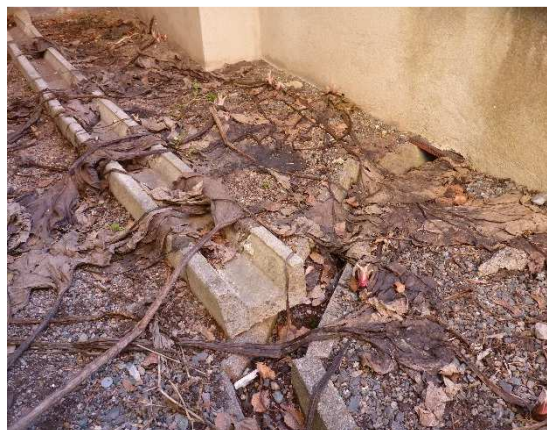
Kuva 3. Betonikouruliittymät eivät toimi tässä kunnossa edes kesällä. Vesi ei pääse terassin alta pois, koska ränni on täynnä kiviä ja hiekkaa
