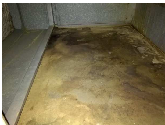
Kuva z. LTO-kammion lattia on kastunut ja likainen.
