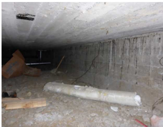
Kuva 4. A-osan ryömintätila ei tuuletu, ja remonttien yhteydessä tilaan on jätetty rakennusjätteitä
