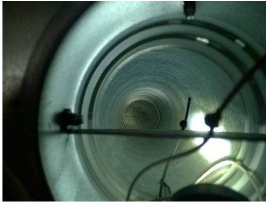
Kuva x. Puhtaalta vaikuttava tuloilmakanava. Pinta on oletettavasti kellastunut siitepölystä.
