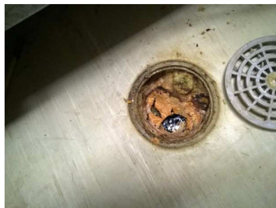
Kuva zz. Lähes kuivunut lattiakaivo iv-konehuoneessa.
