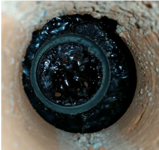
Kuva 8. Maanpaineseinän perusmuurissa on sisäpuolella
