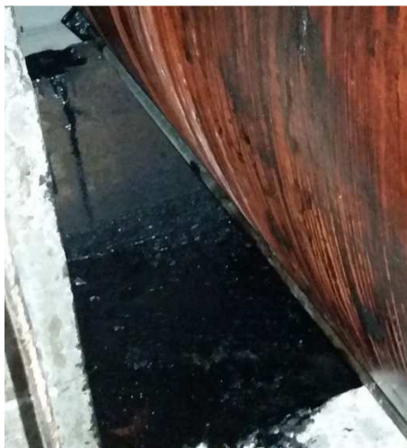
Kuva 10. Raskasta polttoöljyä on valunut tankkien suojaksi rakennettuun patovuotoal- taaseen.
