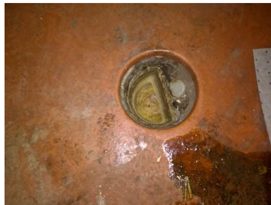
Kuva xx. Iv-konehuoneessa on kuivunut märkäkaivo.
