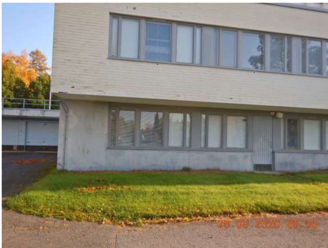
Kuva 3. Kunnantalon vierustalla maanpinta epätasainen ja paikoittain kuoppainen. Kuva alarinteen puolelta.
