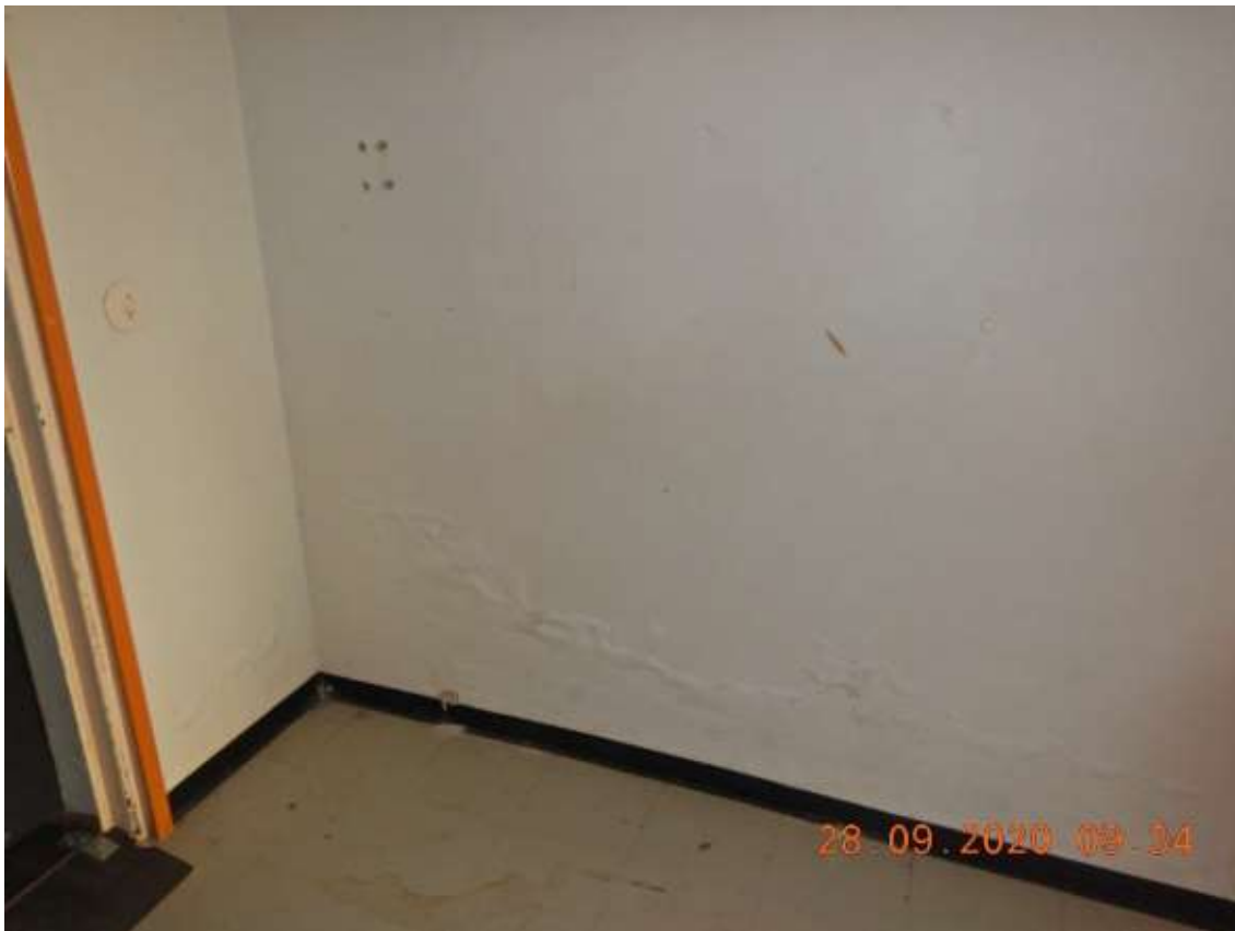
Kuva 5. Kunnantalon maanvastaisen seinän sisäpinnoitteessa on kosteusrasitukseen viittaavia jälkiä.
