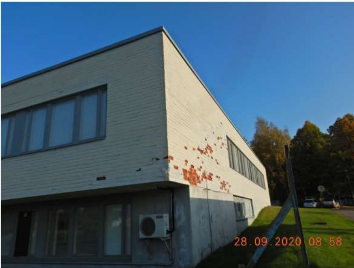
Kuva 9. Ylempänä (1 krs) tiili-villa-tiili-ulkoseinä, jonka julkisivumaali on irronnut useasta kohdasta ja tiilestä on paikoit- tain lohkeillut paloja. Alempana (kellari krs) betoni-villa-tiili-seinää.
