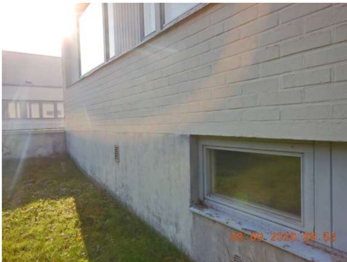
Kuva 2. Asuntolan pihan nurmetus on kiinni maanvastaisessa seinässä, mikä viittaa vierustäytön olevan hienoaineista. Seinässä on kosteusrasitukseen viittaavia jälkiä.
