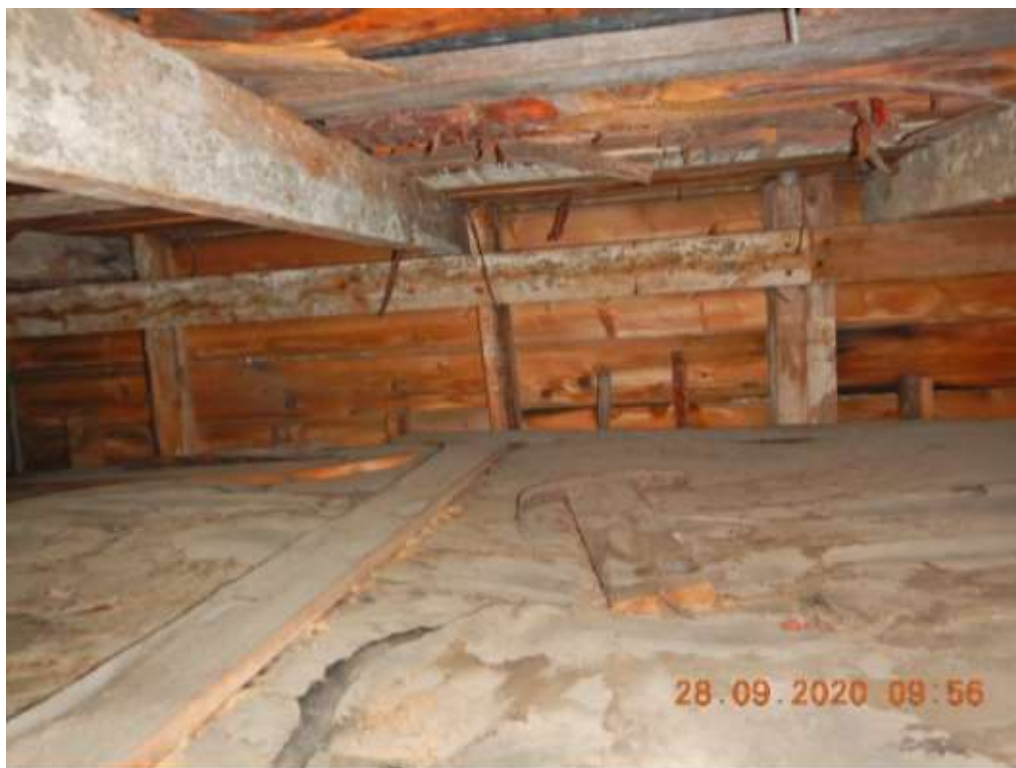
Kuva 22. Valokuva asuntolan yläpohjan tuuletustilasta. Vesikatteen alla ei ole aluskatetta ja valokuvassa näkyvissä materiaaleissa on havaittavissa viitteitä kosteusrasituksesta.
