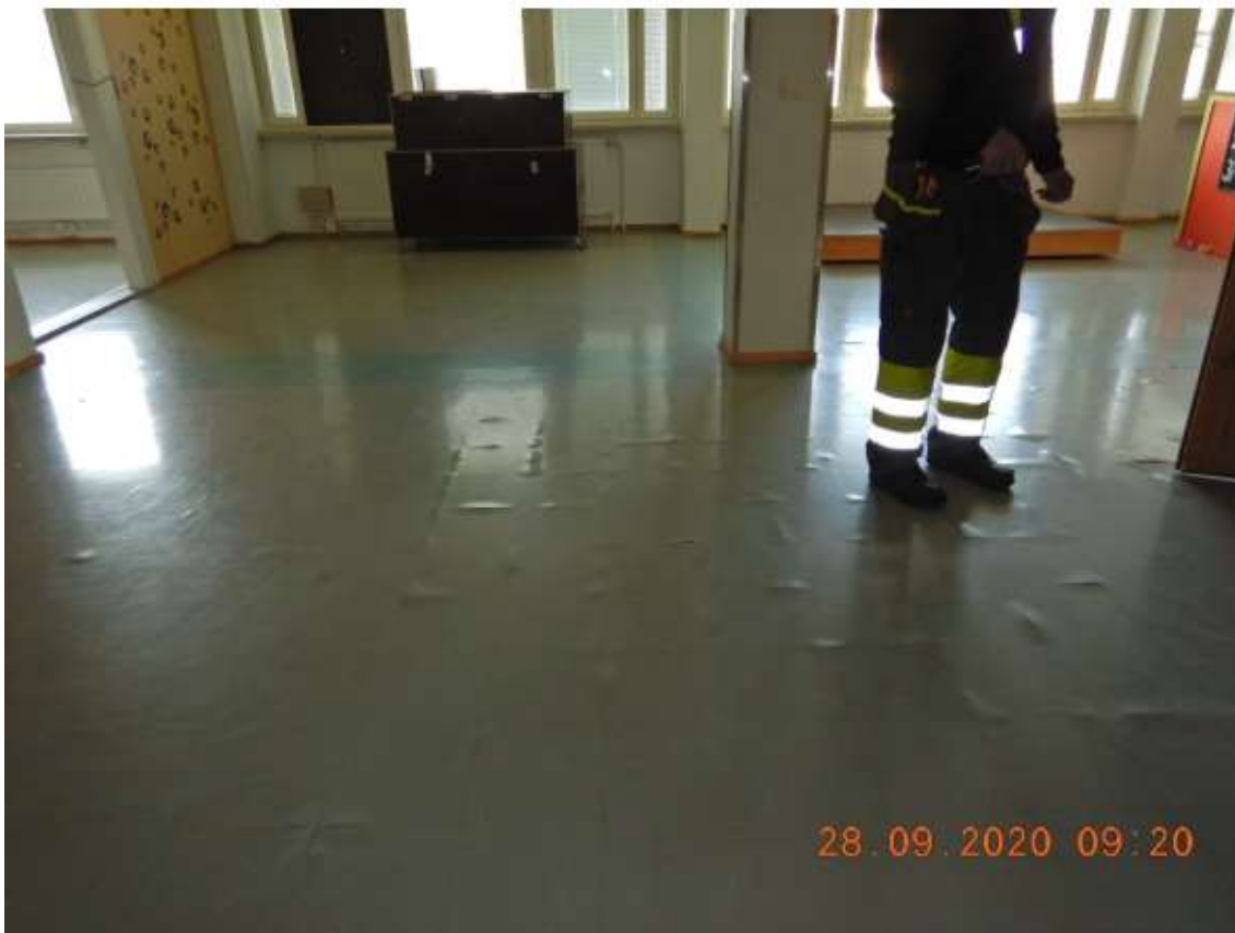
Kuva 25. Kunnantalon lattialaatat kupruilevat.
