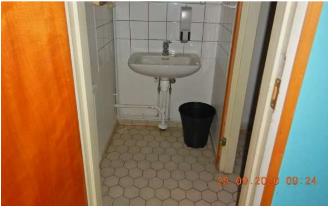
Kuva 24. Kunnantalon WC-tilassa alkuperäinen lattialaatoitus.
