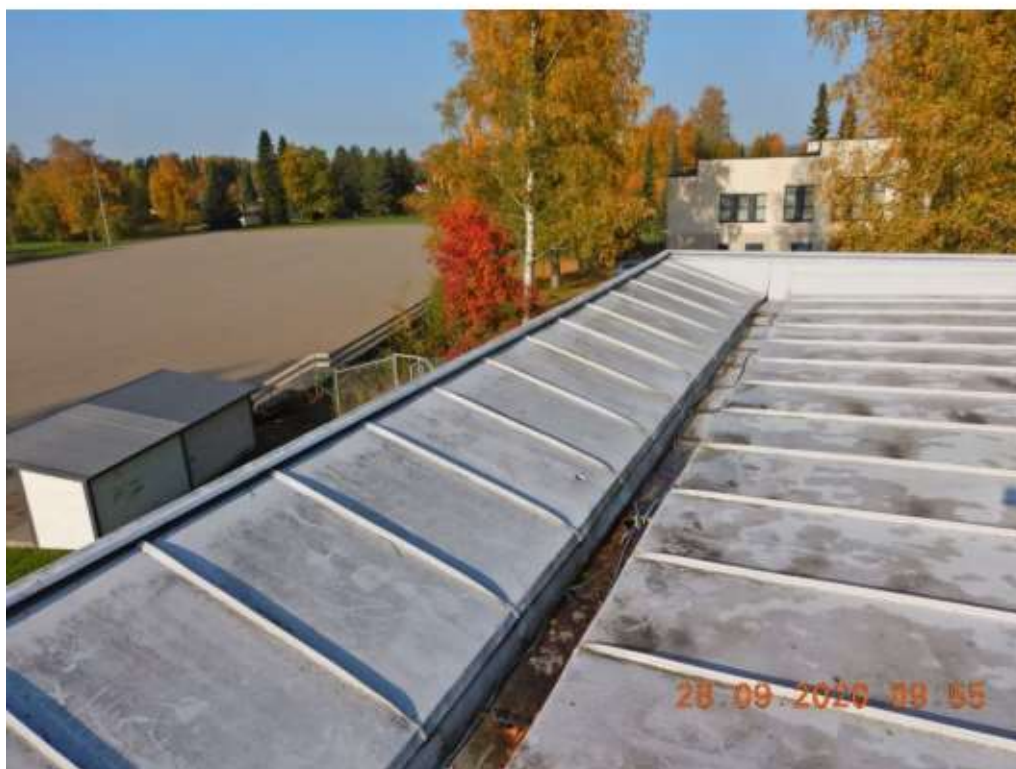
Kuva 23. Asuntolan peltikate ja sadevesikouru. Vesi oli paikoin lammikoitunut kouruun.
