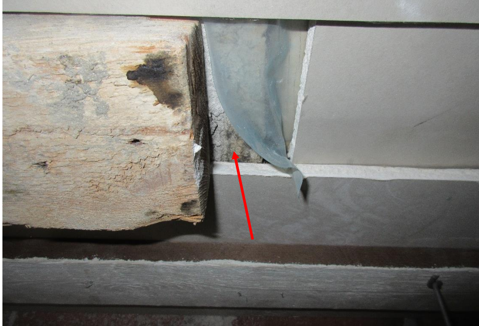
Kuva 26. A-osan luokkatilan 213 ja käytävän 202 alueella yläpohjan alapinnalta pinnoitetussa kipsilevyssä todettiin selvää mikrobiperäistä hajua ja värimuutoksia. Rakenteen vaurioitumista on voinut aiheuttaa mahdolliset aiemmat vesikattovuodot ennen peruskorjauksessa uusittua vesikatetta. Yläpohjatilaa ei ole tarkastusluukkua vesikatolta. Kuva käytävältä 202
