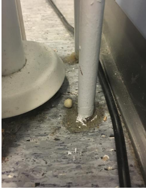
Kuva 40. Vesi- ja viemäriputkiläpiviennit luokassa 211.
