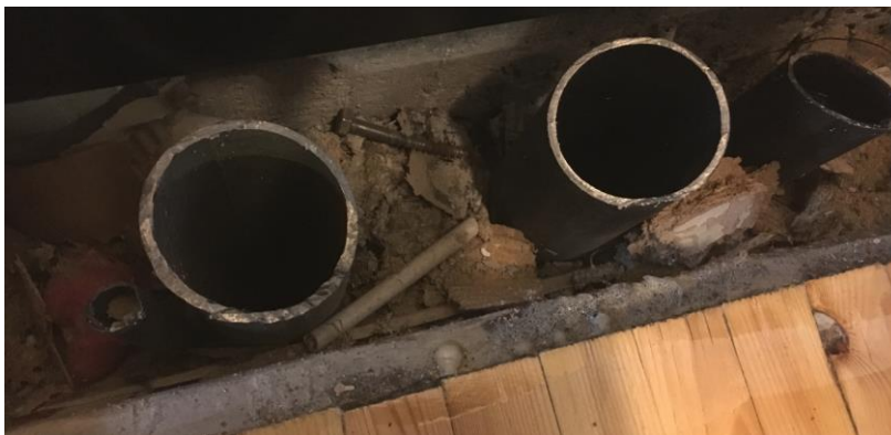
Kuva 14. Välinevarastossa 220 oli vanhat käytöstä poistetut putket tiivistämättä.
