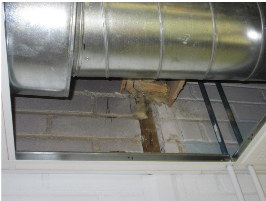
Kuva 22. B-osan eteisen 301a kohdalla tiiliseinien väliä ei ole peitetty laskettujen kattojen takana.
