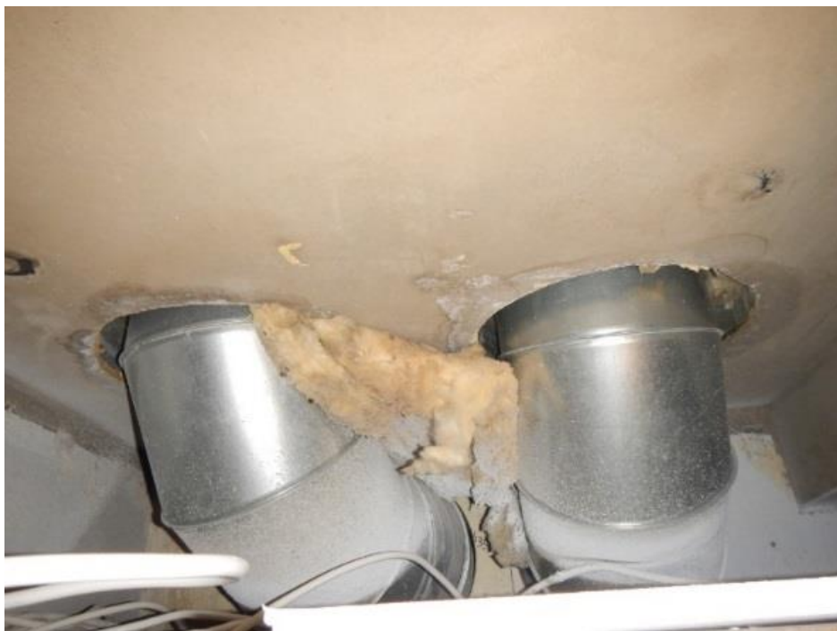
Kuva 30. Ontelobetonilaattojen läpiviennit ovat tiivistämättä. Kuva tilasta 206.
