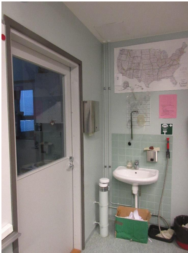
Kuva 46. B-osan tilassa 316 on putken alipainetuuletusventtiilejä.
