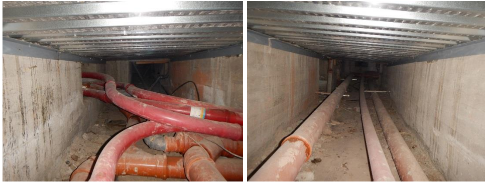
Kuvat 37 ja 38. Putkikanaali kuvattuna käytävältä 103.
