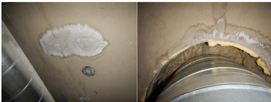
Kuva 25. Aulan 201b katossa ontelobetonilaattapinnoilla ja läpivientien ympärillä on vanhoja kosteusjälkiä, jotka ovat muodostuneet onteloon kertyneen veden tyhjennysreitteinä rakentamisen yhteydessä. Jäljillä ei ole laajempaa merkitystä sisäilman laatuun.
