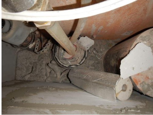
Kuva 35. Putkikuilun 101a pohjalla oli havaittavissa rakennusjätettä.
