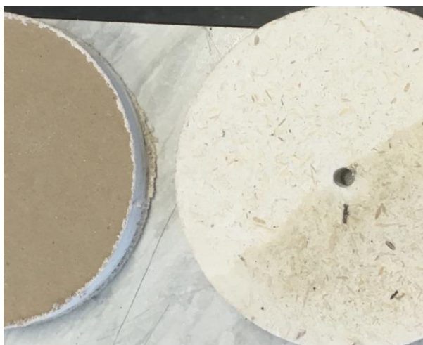
Kuva 23. Sasmox-levyssä vanhoja kosteuden aiheuttamia jälkiä. Kipsilevyn pahvissa ei havaittu tummumaa.
