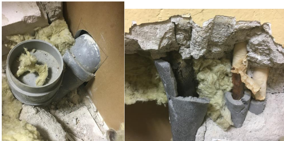
Kuvat 31 ja 32. Aulan 101c nousukuilu. Putken pahvieriste mikrobivaurioitunut.
