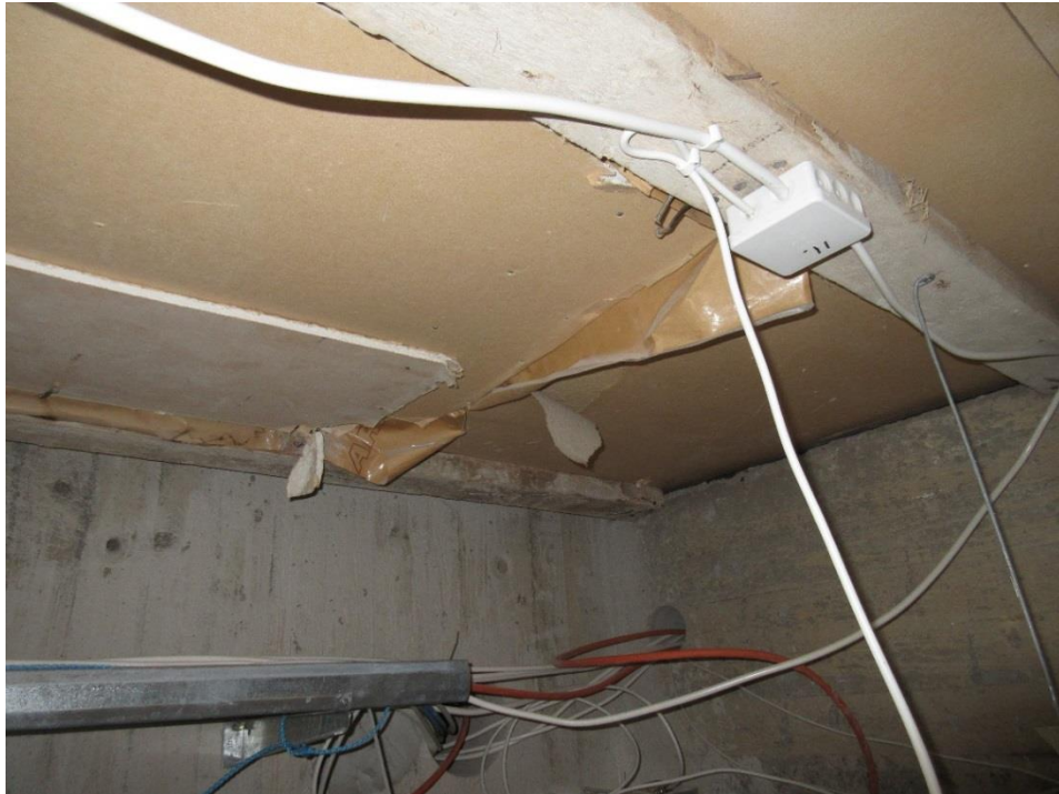
Kuva 29. Rakenneavausten perusteella on todettu, että yläpohjan ilmansulkua ei ole asennettu ilmatiiviisti. Ilmansulkupaperi tai höyrynsulku on pirstaleinen, eikä siinä ole yhtenäistä tiivistä pintaa, jonka voisi limittää tai asentaa ilmatiiviisti.
