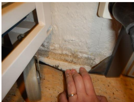
Kuva 19. Fysiikan ja kemian varaston 122a:n pintakosteudenilmaisimella mitattu kostea väliseinä.
