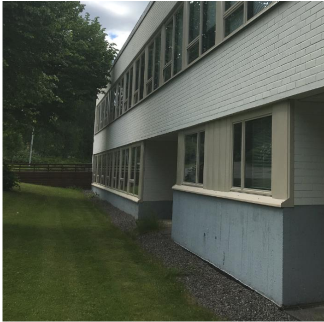
Kuva 45. Maan pinta viettää rakennukseen päin luokkien 118 ja 119 kohdalla. Maan pinta on ko. kohdalla myös ylempänä kuin lattiapinnan ylätaso.
