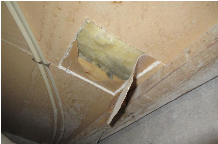
Kuva 27. Käytävän 201c päädyssä, joka on tilan 213 vieressä havaittiin, että laskettujen kattolevyjen takana olevissa levyrakenteissa on epätasaisesti värjäytynyttä levyä. Levyrakenteen takana ilmansulkupaperissa tai lämmöneristeissä ei todettu kosteuden aiheuttamia väri- tai rakennemuutoksia. Levyjen pintaan on mahdollisesti tapahtunut väri- tai rakennemuutoksia jo työmaaolosuhteissa rakentamisen aikana.
