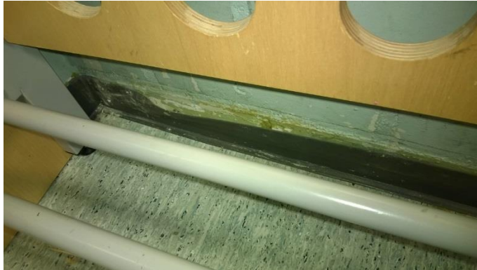
Kuva 20. Vaate-tilan 301b väliseinässä havaittiin tiilessä maalipinnan hilseilyä.
