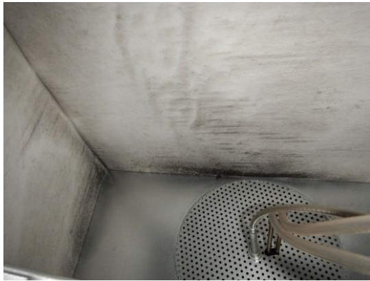
Kuva 49. Tilan 201c tuloilmapäätte, jonka mineraalivillaisessa äänenvaimentimessa on havaittavissa mustaa likaa.
