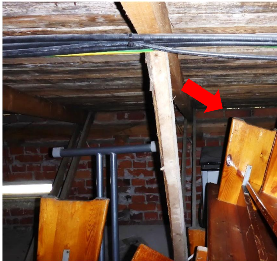
Kuva 28. Poikittaisessa suunnassa yläpohjan tuulettavuus on heikkoa. Rako räystäältä on lähes ummessa (nuoli)
