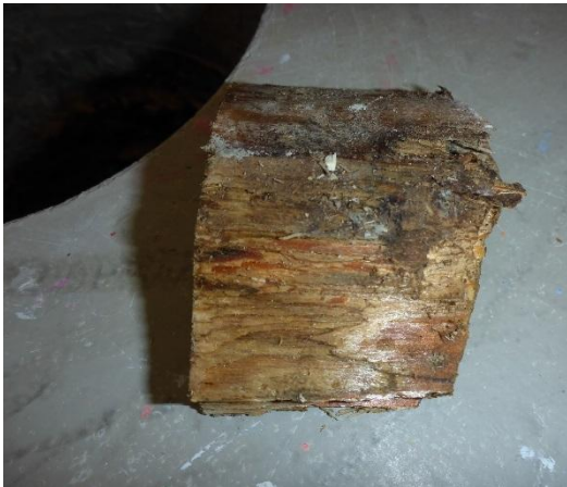
Kuva 11. Teknisen työn tilaan tehdyssä rakenneavauksessa eristetilan puurakenteissa todettiin selkeitä lahovaurioita.
