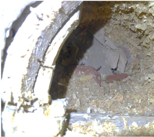
Kuva 22. Purueriste on alalaattapalkistossa kuivaa, mutta mikrobivaurioon viittaava haju osassa avauksia voimakasta.
