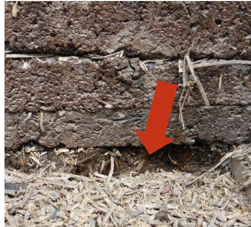
Kuva 20. Pellavarivenauhat ovat osin aistinvaraisesti havaittaen mikrobivaurioituneet ja yhteydessä sisäilmaan
