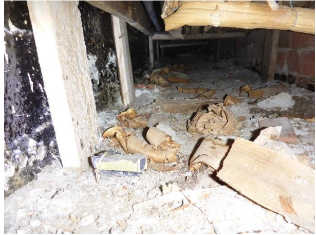
Kuva 7. Alapohjan putkikaanaleissa on eloperäistä materiaali, ja mikrobivaurioituminen on aistinvaraisesti havaittavaa.
