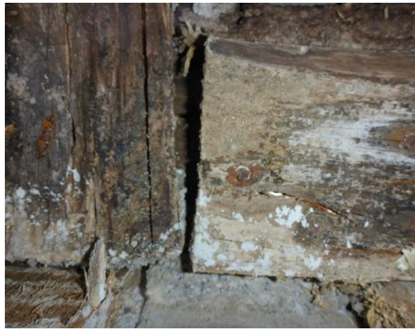
Kuva 23. Alalaattapalkistossa havaittiin muottilaudoituksen osalla näkyviä lahovaurioita
