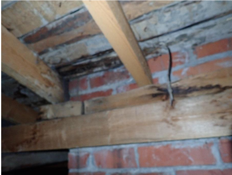
Kuva 36. Reuna-alueen heikon tuulettuvuuden vuoksi puurakenteissa on yksittäisiä lahovaurioita
