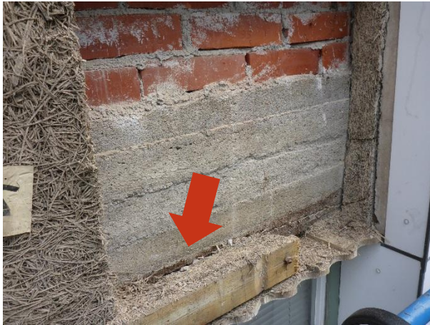
Kuva 19. US-2 seinässä lastusementtilevyn takana on pellavanauhaeristeet, joilla on tukittu sisäilmaan yhteydessä olevat reiät.
