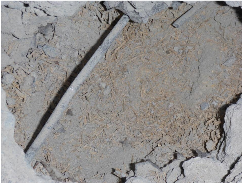
Kuva 37. Lohkossa 2 rakenne ei vastannut suunnitelma-asiakirjoja. Alalaattapalkiston sijaan rakenne on yläpuolelta lämmöneristetty massiivibetonilaatta, jossa on erillinen palopermantovalu.
