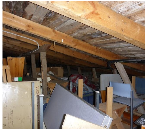
Kuva 29. Sisätilan kautta on pääsy yläpohjan alemmalle tasolle. Taso on täynnä tavaraa ja siten myös paloturvallisuusriski
