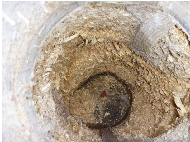
Kuva 12. Tekstiilityön luokassa purueriste on pohjalta kosteaa. Laho on edennyt osin pitkälle.
