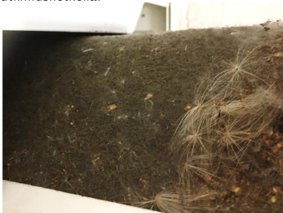
Kuva 40. Tuloilman karkeasuodatin on lähes tukossa
