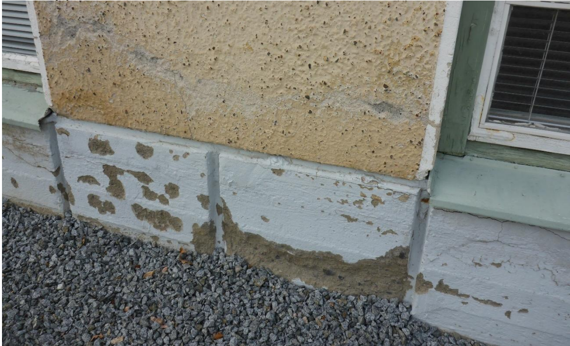
Kuva 14. Sokkelissa havaittiin kapillaarisesta kosteudesta aiheutunutta betonin vaurioitumista
