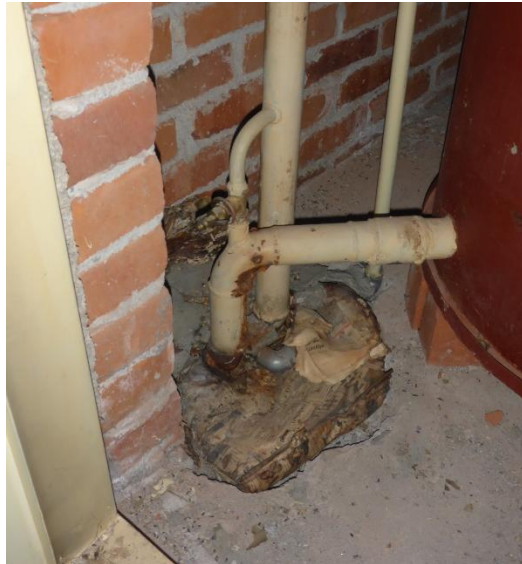
Kuva 31. Vanhan paisuntasäiliön kohdalla on aistinvaraisesti havaittava paikallinen mikrobivaurio putkiläpivientien kohdilla. Vaurioalueelta ei todettu sisäilmayhteysttä.
