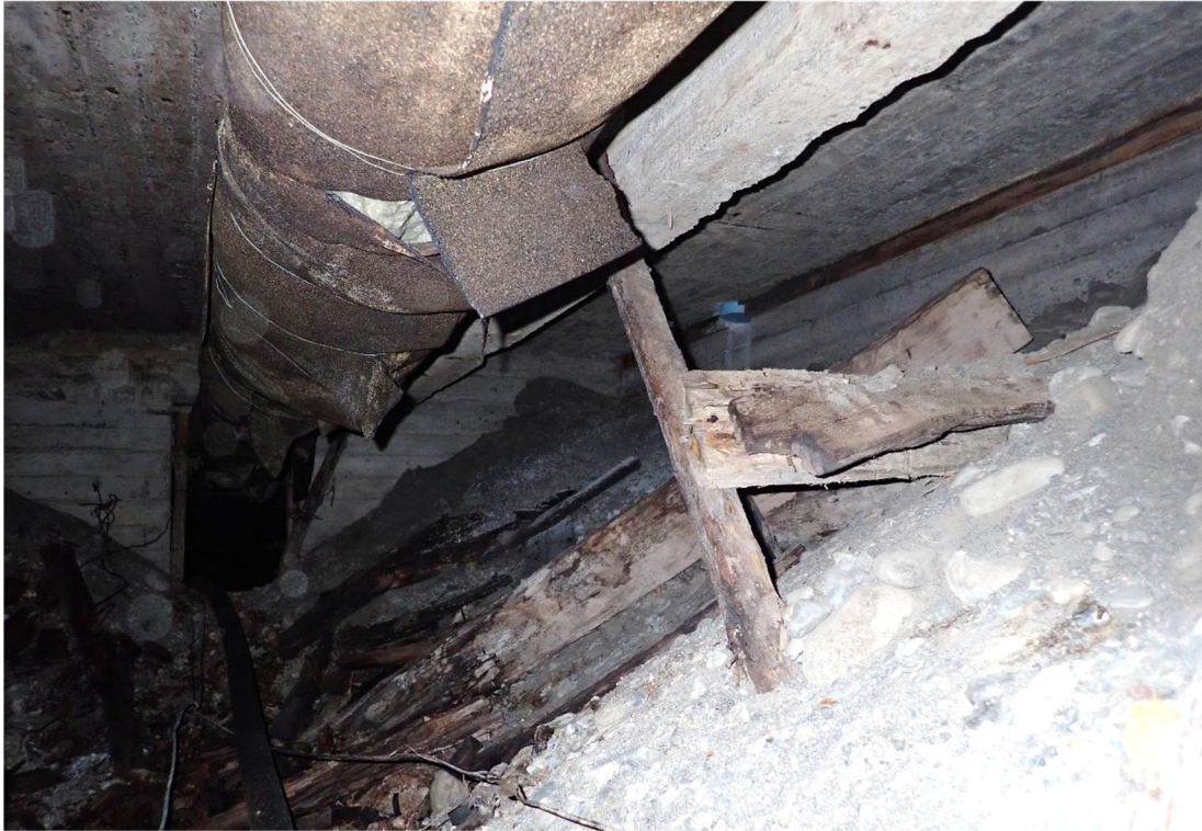
Kuva 10. Teknisen työn alapuolisessa maatayttötilassa on rakennusajasta peräisin olevia vanhoja muottilautoja, jotka ovat pitkälle lahovaurioituneet.
