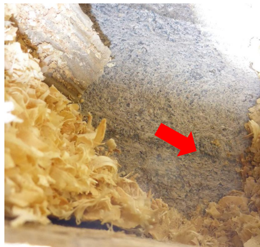
Kuva 24. Kantavat väliseinät kannattelevat alalaattapalkiston tasauspalkkia. Rakenteessa on lievä epäjatkuvuuskohta kannen ja palkin välissä.
