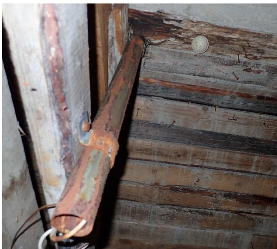
Kuva 34. Vanha antenniputki on läpiviennin kohdalta lahovaurioitunut. Läpivienti vuotaa edelleen.
