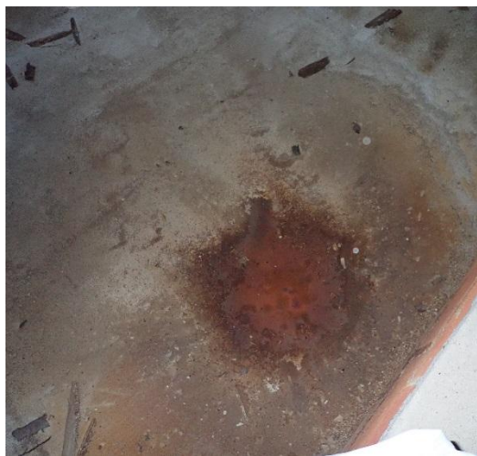
Kuva 35. Antennin putkesta ohjautuu vettä suoraan yläpohjan palopermannon päälle
