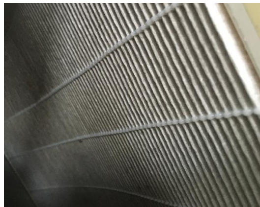
Kuva 41. F7 luokan hienosuodatin on ylittänyt jo vaihtovälin.
