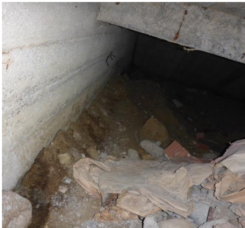
Kuva 8. Ontelotilaan jätetyt rakennusjät-teet ovat mikrobivaurioituneet maakosteuden seurauksena
