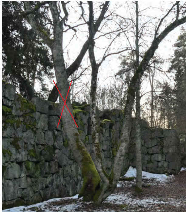
1.1 Haaroittunut ja revennyt puu, jonka toinen haara on kallellaan muurin suuntaan. Ainakin muurin suuntaan oleva haara on poistettava.
