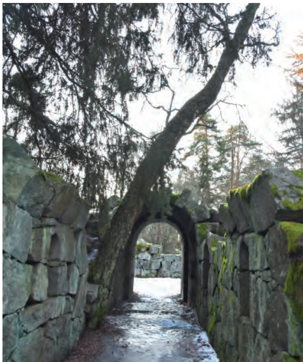
1.2 Muurissa kasvaa vanha ja kallistunut koivu, jonka kunnan on arboristin arvioitava. Puun mahdollisen poiston yhteydessä on myös muuria korjattava.
