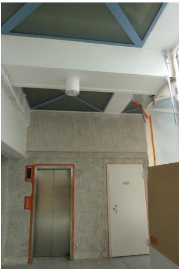
2a Aiemmin 2. kerroksen keskeisiin tiloihin valoa ovat tuoneet valokatteet, joista suuri osa on kuitenkin peitetty uusilla kattorakenteilla. Myös näkymä parvelta alakertaan oli peitetty korjaustöiden vuoksi.
