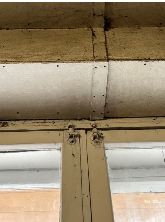
Kuva 82. Yksityiskohta saman ikkunaruuudun keskijaon yläpuitteesta. Kuva 10.1.2024.
