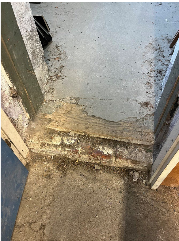
Kuva 85. Lattiatasoitteet ovat kuluneita. Tietoa pintojen tasoitusajankohdista ei ole. Kuva 10.1.2024.
