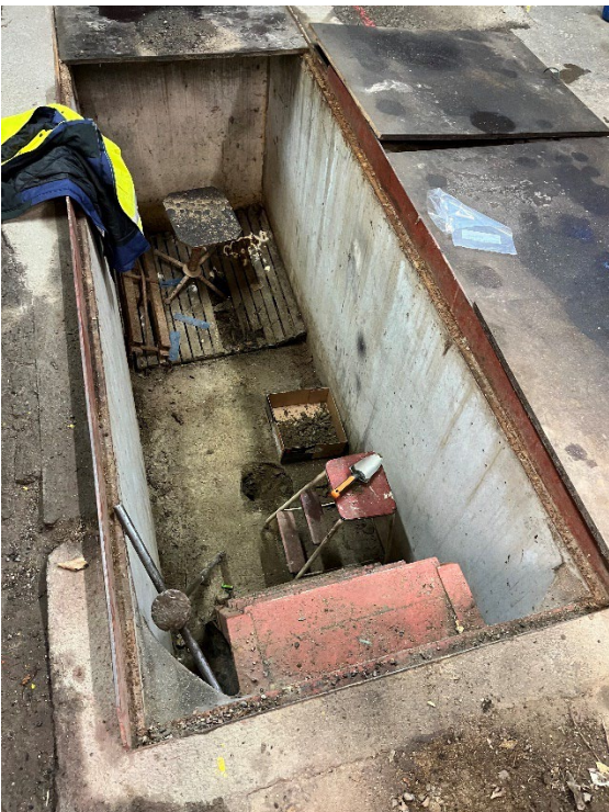
Kuva 81. Lounaisnurkan pönttöuunin vieressä on rasvamonttu. Kuvanottohetkellä montun pohjalta kaivettiin maanäytettä pilaantuneista maa-aineksista. Kuva 10.1.2024.
