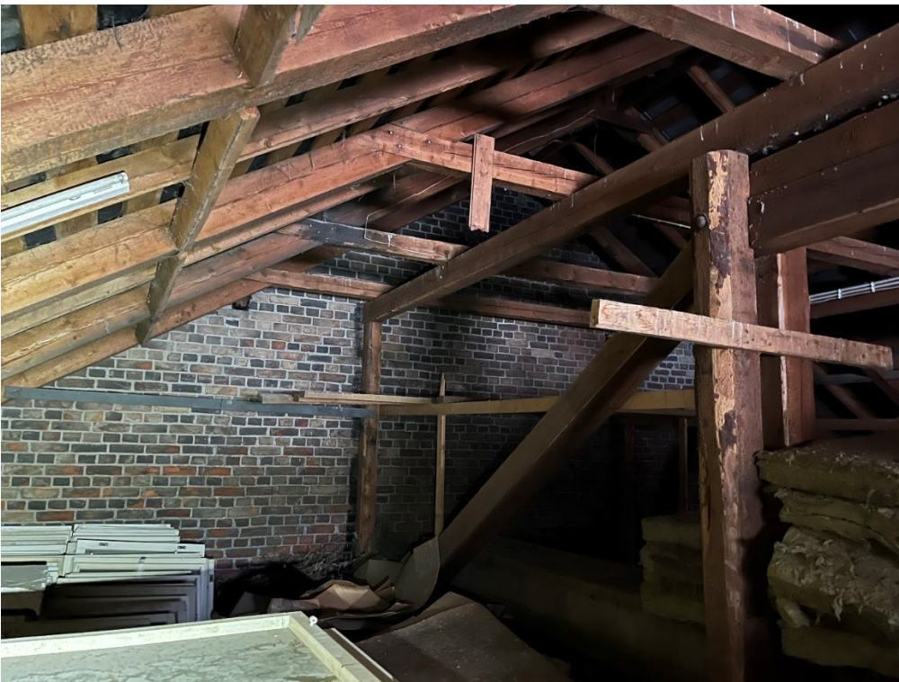
Kuva 75. Rakennuksen eteläpäätä ja keskimmäistä hallitilaa rajaava tiiliseinä jatkuu koko korkeana välikatossa. Kuva 10.1.2024.
