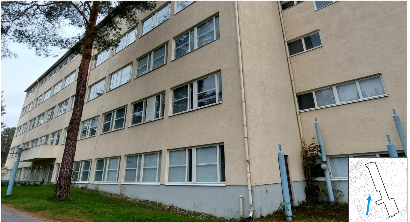
Kuva 32. Kolmannen kerroksen teorialuokasta on ollut käynti vasemmalla näkyvälle parvekkeelle. Kuvassa oikealla näkyvät siniset pilarit ovat jääne pääsisääkäynnin katoksesta.
