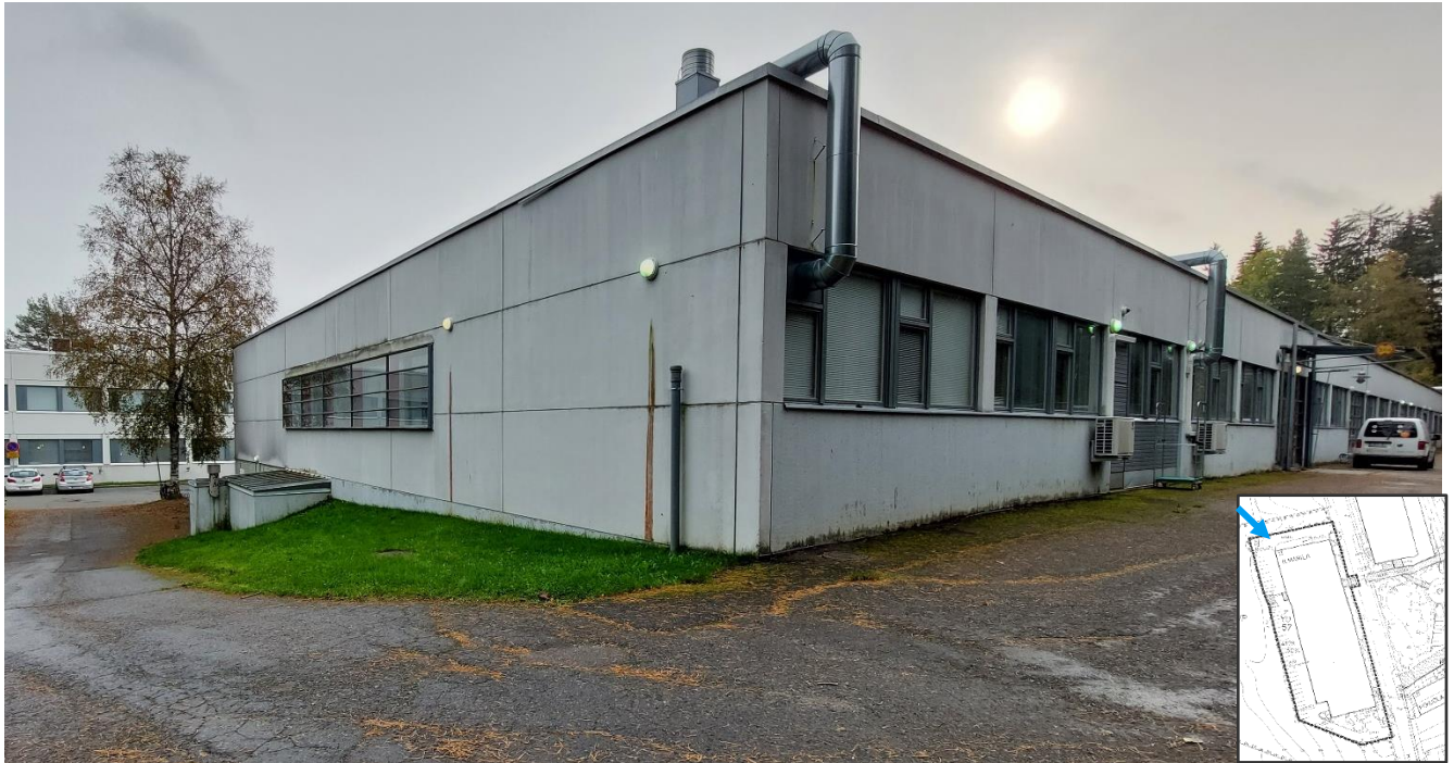
Kuva 139. Luoteiskulmassa on ajoyhteys Rinnetieltä takapihan pysäköintialueelle. Jälkiasennetut il- manvaihtoputket näkyvät suojaamattomina länsijulkisivulla.
