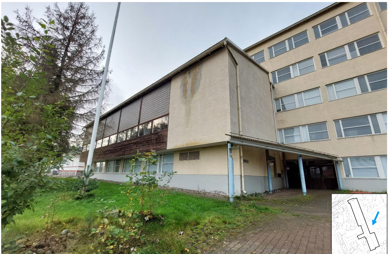
Kuva 35. Ainolan ensimmäisen kerroksen pääsisäänkäynti on kulmauksessa, vinon katoksen suojassa. Juhlasalin rappausjulkisivussa on vaurio.
