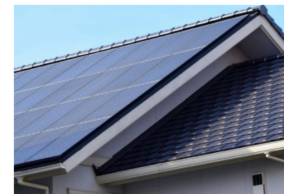
Kuva 16. Esimerkki katon värisistä aurinkopaneeleista.
