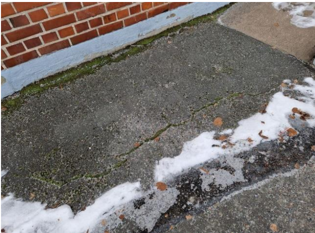
Kuva 2. Asfaltissa pieniä halkeamia.
