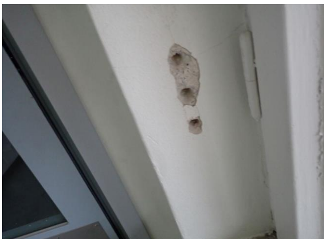
Kuva 37. Tilapinnoissa on käytönjälkiä.
