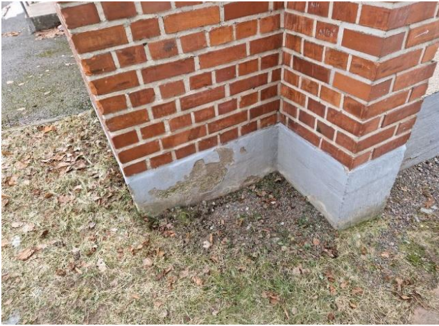
Kuva 15. Sokkeleissa on pinnoitevaurioita.
