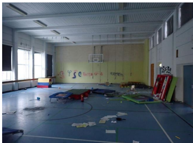
Kuva 38. Tilapinnoissa on ilkeivallan jälkiä.
