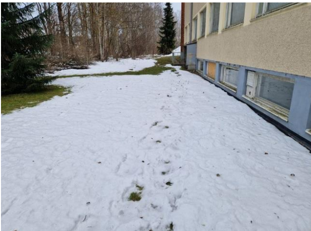
Kuva 10. Maanpintojen kallistukset rakennusten vierustoilla ovat puutteelliset.
