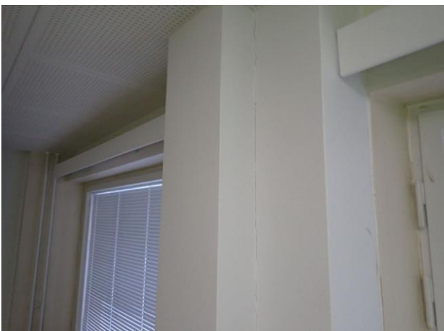
Kuva 22. Kantavissa rakenteissa vähäisiä halkeamia.
