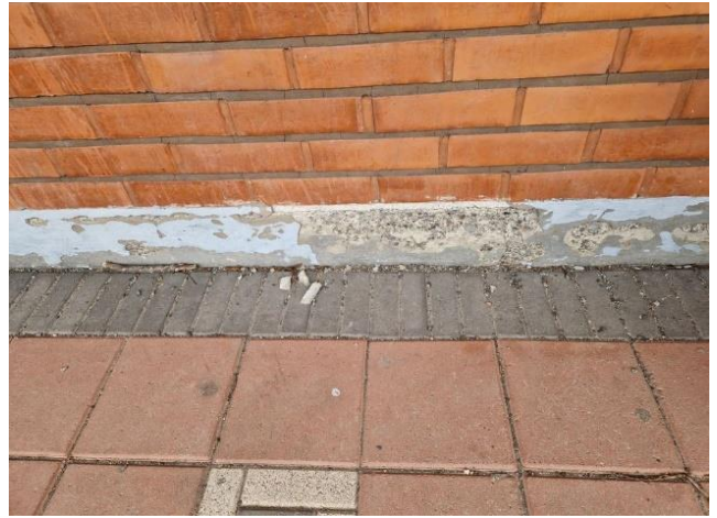
Kuva 16. Sokkeleissa on havaittavissa pakasrapaumaa.
