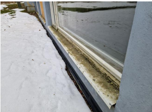
Kuva 31. Ikkunoiden vesipeltien kaadoissa on puutteita.
