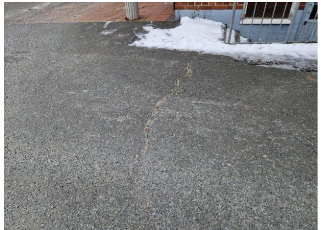
Kuva 3. Asfaltissa pieniä halkeamia.
