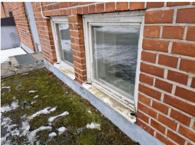
Kuva 12. Maanpintojen kallistukset rakennusten vierustoilla ovat puutteelliset.
