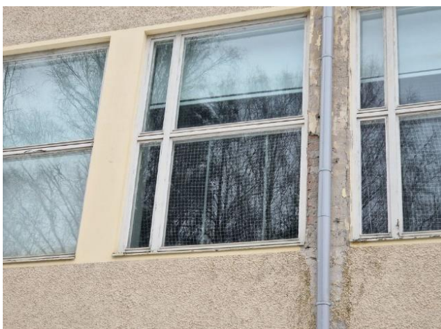
Kuva 25. Rappatuissa pinnoissa pinnoitevaurioita.
