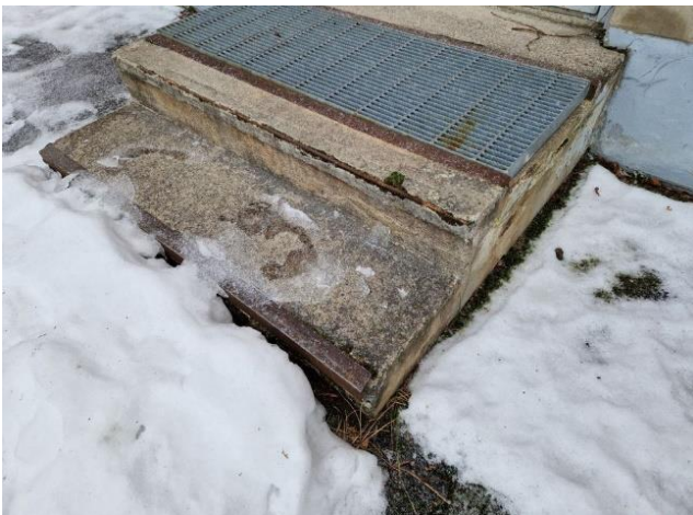
Kuva 9. Betoniportaisiin tulee kohdistaa laajoja korjaustöitä.
