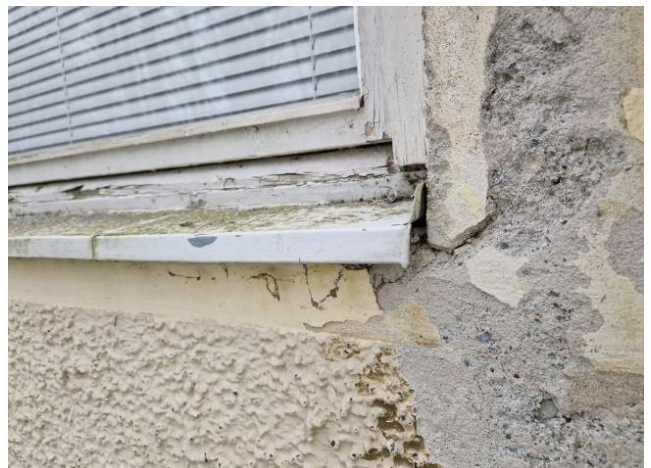
Kuva 32. Ikkunoiden vesipeltien tiiveydessä on puutteita.
