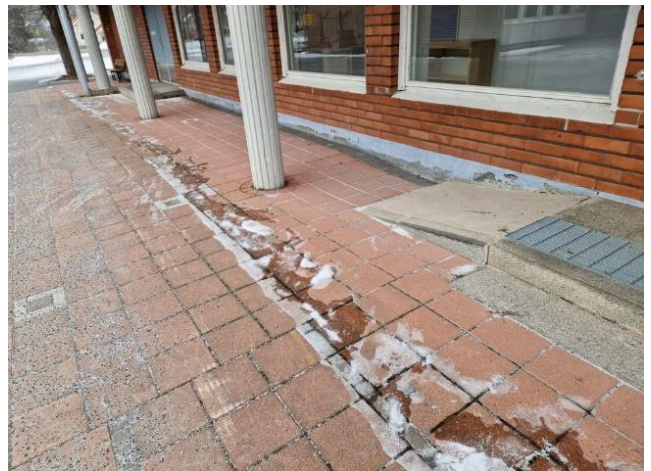
Kuva 11. Maanpintojen kallistukset rakennusten vierustoilla ovat puutteelliset.
