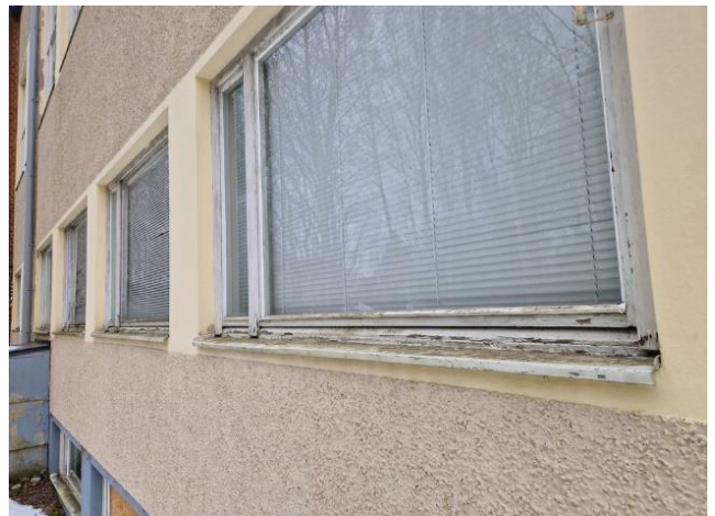
Kuva 30. Ikkunoiden vesipelleissä on puutteita.
