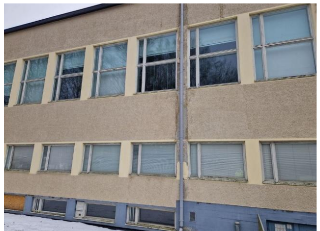
Kuva 24. Rappatuissa pinnoissa pinnoitevaurioita.
