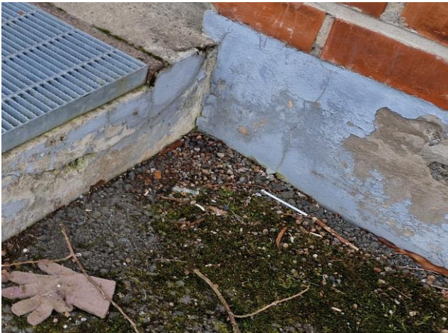
Kuva 17. Sokkeleissa on halkeamia.
