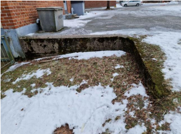
Kuva 7. Betonirakenteeseen tulee kohdistaa laajoja korjaustöitä.
