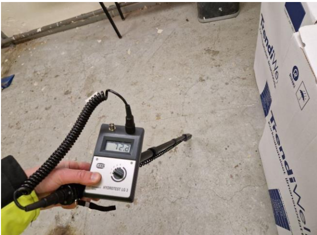
Kuva 18. Alapohjarakenteessa on halkeamia.
