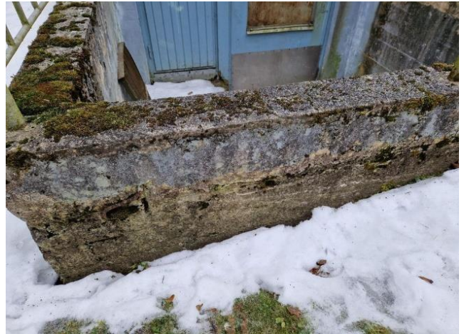
Kuva 8. Betonirakenteeseen tulee kohdistaa laajoja korjaustöitä.
