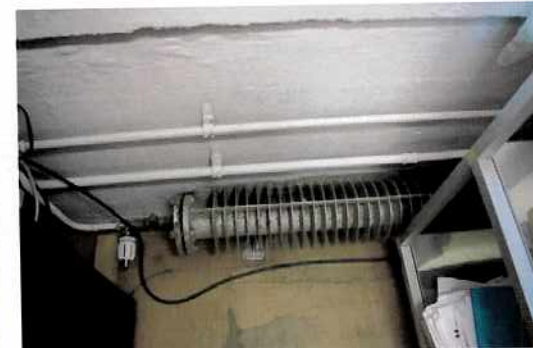
Ritiläpatteri 2. kerroksen ikkunaseinällä
