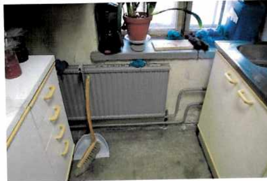
Levypatteri 2. kerroksen ikkunaseinällä
