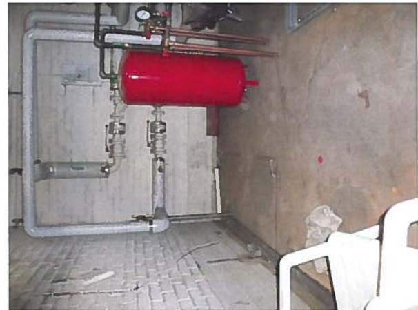
Lämpökeskushuone kellarissa, jossa sijaitsi piste P8
