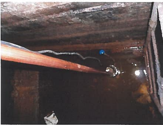
Kaivo K, pumppu ja poistoputki
