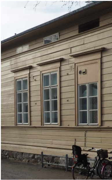
1. kerroksen ikkunat on uusittu vanhan mallin mukaan. Yhden ikkunan ylimmät puitteet on korvattu levyllä ja ilmanvaihtokanavalla.
