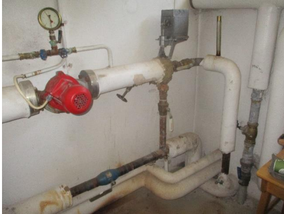
Kuva 5.3 Asuntolarakennuksen 2 lämmitysverkoston shunttausryhmä
