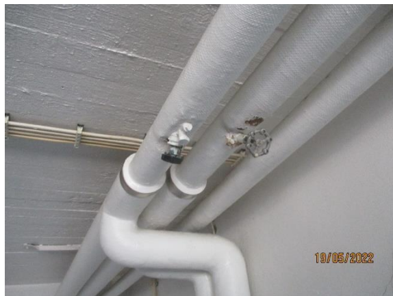
Kuva 5.5 Lämmitysverkoston putkistoa kellarissa. Putkistoeristys on tehty massieristettä. Linjasäätö- ja vinokarasulkuventtiilit ovat ikääntyneitä
