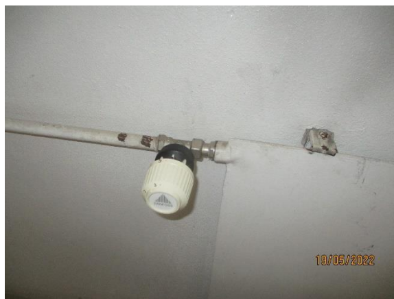
Kuva 5.8 Termostaattinen patteriventtiili Danfoss Oy
