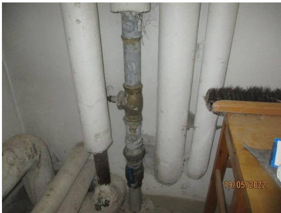
Kuva 6.2 Käyttöveden runkoputket nou-sevat kellarista. Kylmän veden runkoputki on sinkittyä terästä.
