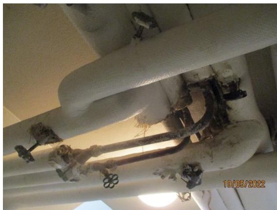
Kuva 6.4 Karamallisia sulkuventtiileitä käyttövesiputkistossa
