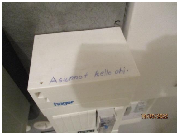
Kuva 7.6 Huippuimurin kello-ohjaukseen tehtyjä merkintöjä, jonka perusteella voi olettaa, että toinen huippuimuri palvelee asuntoja
