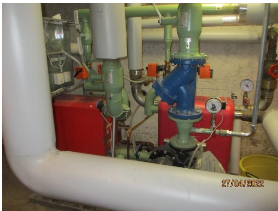
Kuva 5.1 Kaukolämmön alajakokeskuksen yleiskuva
