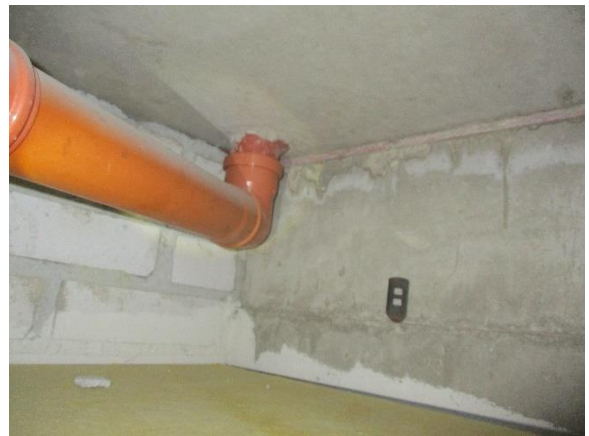
Kuva 6.3 Viemäriputkistoa on pohjakerroksen alakaton sisällä välipohjaan kannakoituna.
