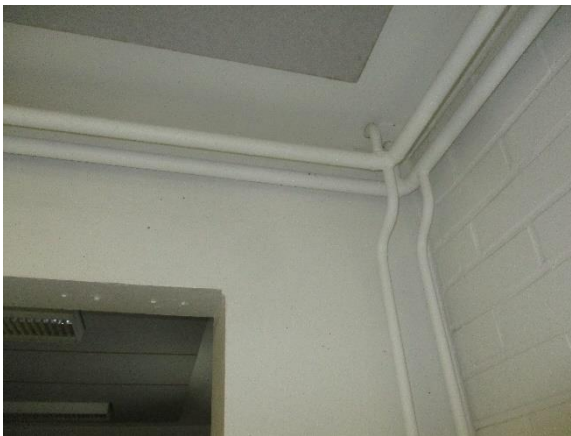
Kuva 5.4 Lämmitysverkoston runkoputkistot kiertävät rakennuksen sisällä ulkoseinälinjaa ja ovat asennettu pohjakerroksen kattoon kannakoituina.
