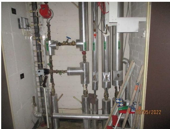
Aluelämpöverkon putkikanaali viereisestä asuntolarakennuksesta 1 tulee rakennuksen pohjakerroksen tekniseen tilaan, jossa on lämmityksen lämmönsäätöryhmä.
