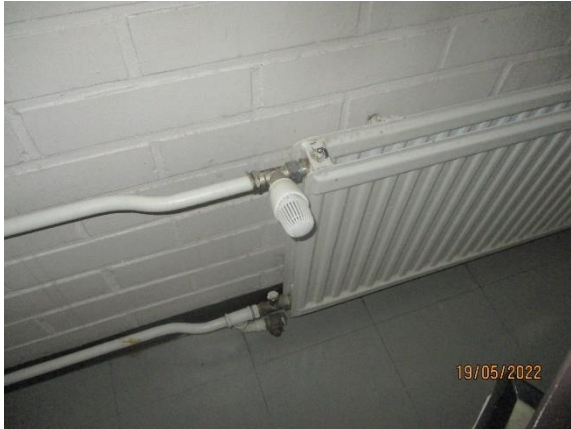
Kuva 5.7 Teräslevypatteri, jossa Oras-patteritermostaatti lienee 2010-luvun asennusta
