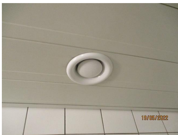
Kuva 7.5 Ilmanvaihdon poistoilmaventtiilit ovat säätöosalla varustettuja ja sijoitettu wc-/pesuhuonetiloihin
