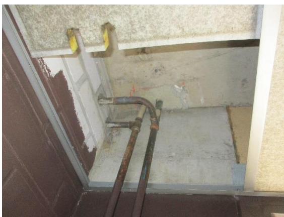
Kuva 5.6 Lämmitysverkoston patterien kytkentäputkistoja eteläpäädyssä.
