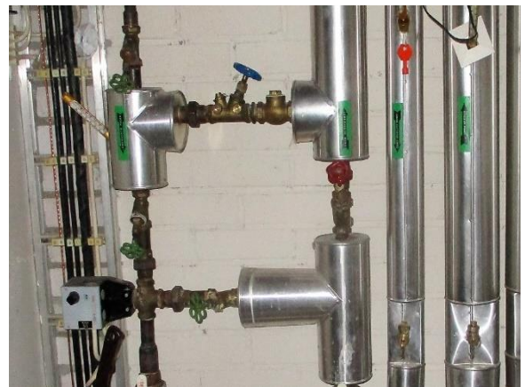
Kuva 5.5 Lämmitysverkoston putkistossa on alkuperäiset karamalliset sulkuventtiilit.
