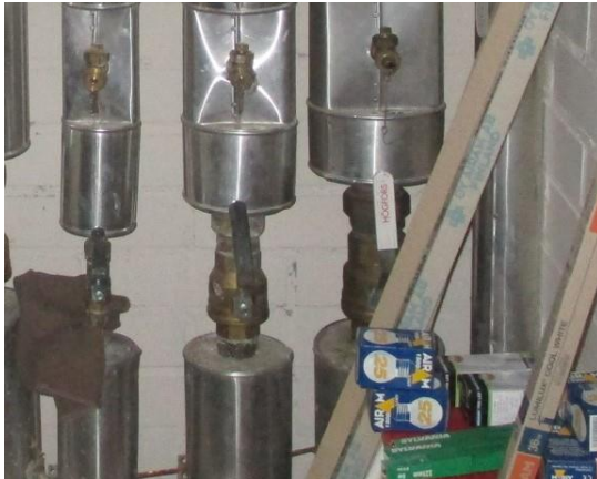
Kuva 6.1 Kylmänveden sekä lämpimän käyttöveden pääsulkuventtiilit pohjakeroksen teknisessä komerossa ovat pallosulkuventtiilejä, joilla voidaan vesivirrat tarvittaessa sulkea luotettavasti.
