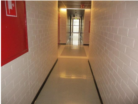
Kuva 8.7 Vesiletkukellalla varustettuja palopostikaappeja on majoituskerrosten käytävällä.
