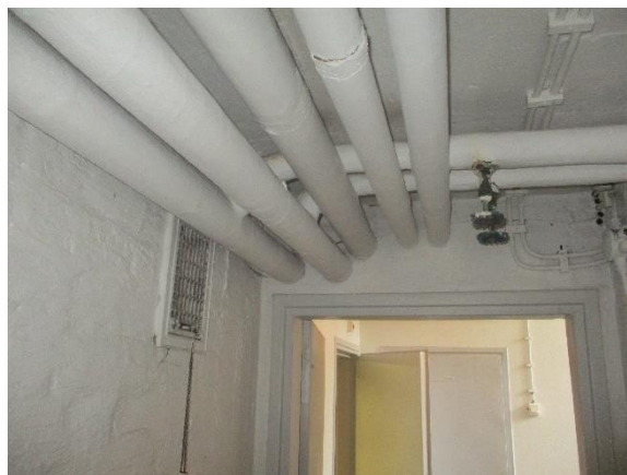
Kuva 7.4 Kellarin käytävän seinässä poistoilmalle valurautainen sälesäätöinen riittä.
