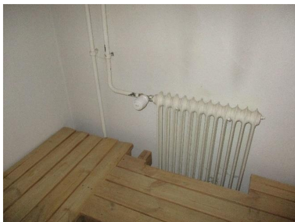
Kuva 5.7 Teräksinen liitepatteri, jossa patteritermostaattii lienee 2010-luvulta
