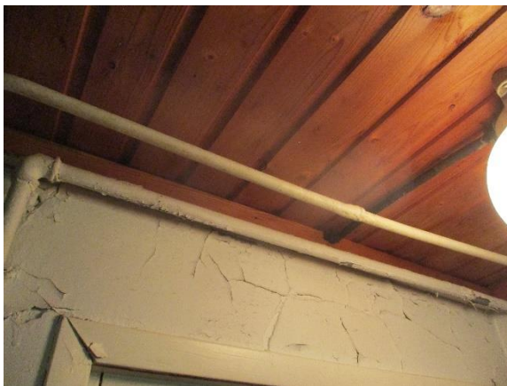
Kuva 6.2 Käyttöveden pintamaalattu kytkenäputkia saunan seinähanalle kellarissa. Havaitaan sinkittyä teräspank kylmänveden kytkenäputkena, lämminvesiputki on kuparia.
