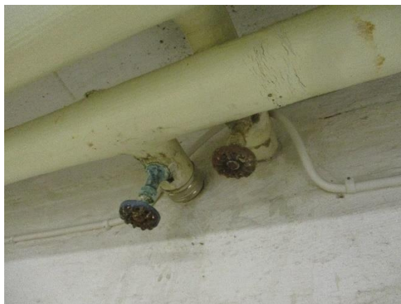
Kuva 5.5 Lämmitysverkoston putkistossa on alkuperäiset karamalliset sulkuventtiilit, jotka ovat erittäin heikkokuntoisia ja niillä ei voida enää sulkea tai säätää verkostoa.
