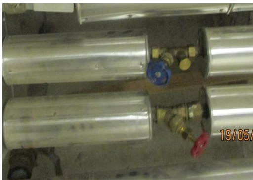
Kuva 6.1 Lämpimän käyttöveden kara-malliset sulkuventtiilit kanaaliputkiston liitoksessa, jotka vaikuttaisivat olevan 1990-luvulla asennettuja.
