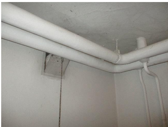
Kuva 7.5 Kellarissa on ulkoseinissä korvausilmalle luukkumallisin säädöin olevia raitisilmakanavia.
