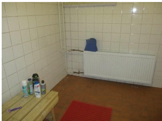
Kuva 5.9 Pesuhuoneeseen on vaihdettu teräslevypatteri, ilmeisesti 1990 luvulla
