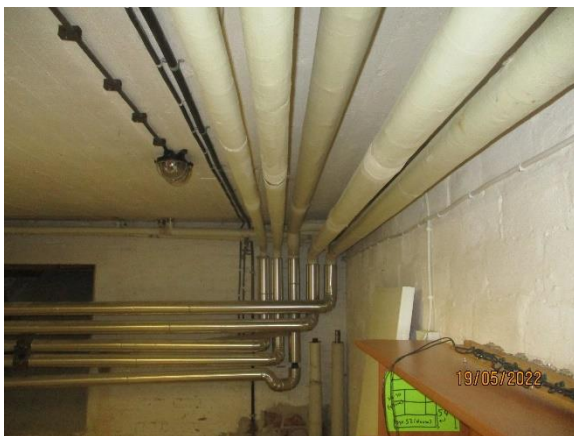
Kuva 5.4 Rakennuksen runkoputkistot ovat asennettu kellarin kattoon kannakointuina.
