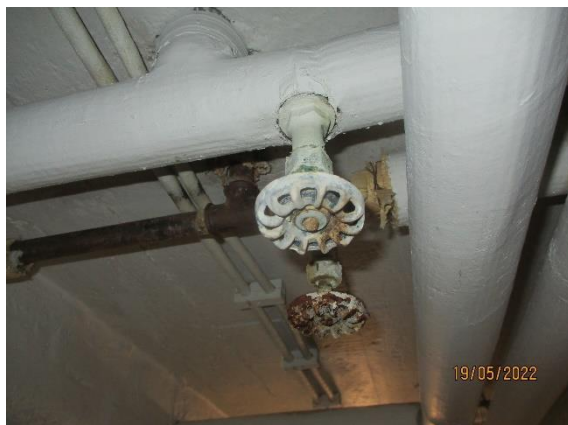
Kuva 5.6 Kuten edellinen kuva. Alkuperäiset karamalliset sulkuventtiilit ovat heikkokuntoisia ja käyttökelvottomia sulkea tai säätää verkostoa.
