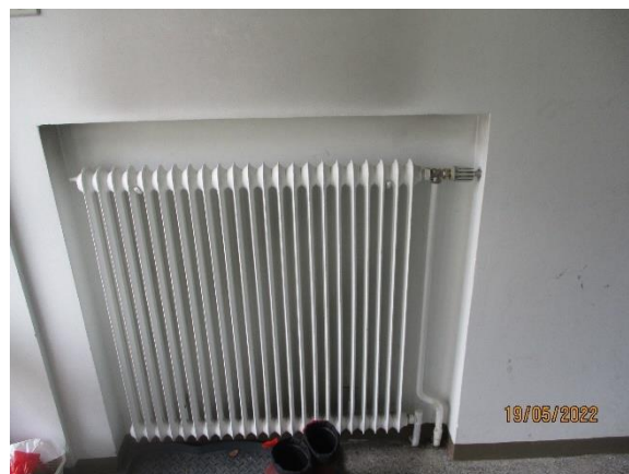
Kuva 5.8 Teräsliitepatteri portaikossa. Patteriventtiili on vanha, ehkä 1970-luvulta.
