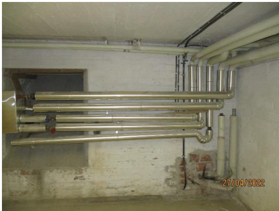
Kuva 5.1 Aluelämpöverkon putkikanaali tulee rakennuksen kellarikerrokseen. Alkuosaan taloputkistoa on vaihdettu eriste, jossa peltipinta.
