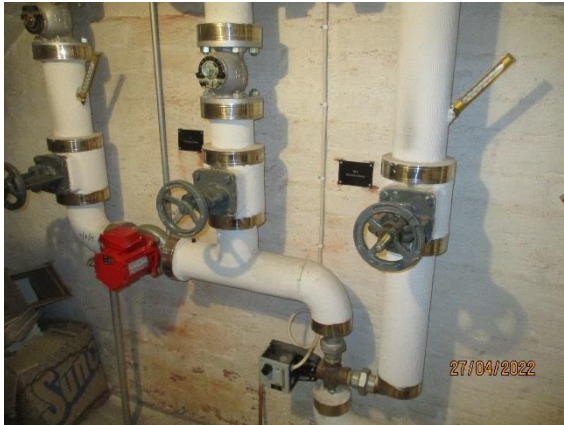
Kuva 5.3 Asuntolarakennuksen 1 lämmitysverkoston lämmönsäädön pumppu-/shunttiryhmä.
