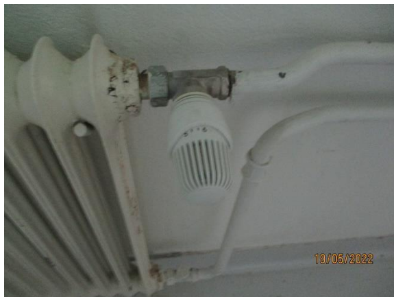
Kuva 5.8 Termostaattinen patteriventtiili TA
