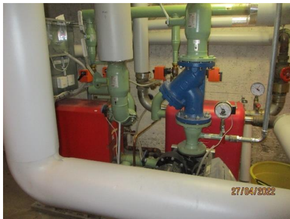
Kuva 5.1 Kaukolämmön alajakokeskuksen yleiskuva
