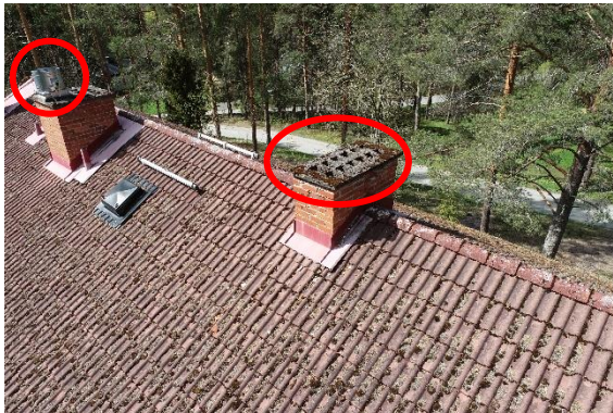
Kuva 7.1 Vesikatolla painovoimaisen ilmanvaihdon hormoneja sekä huippuimuri
