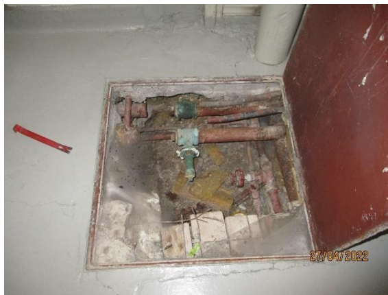
Kuva 5.6 Kellarilattian alla olevia vanhoja teräsputkia, joista osa on tulpattu
