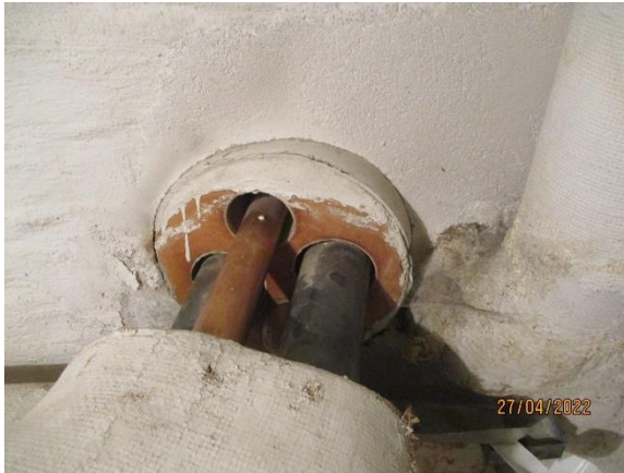
Kuva 5.4 Aluelämpöverkon putkiele- mentti, joka nousee rakennuksen kellari- kerrokseen
