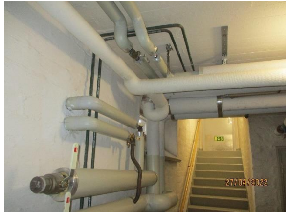
Kuva 5.5 Lämmitysverkoston putkistoja, joissa massakangaspintaista todennäköi- simmin villakourueristettä
