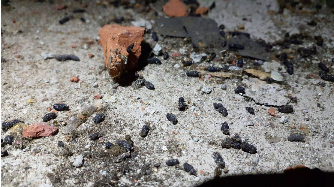
Kuva 8. Lepakon papanoita päärakennuksen keskiosan ullakon päätyseinän tyvellä, länsipäädyssä.
