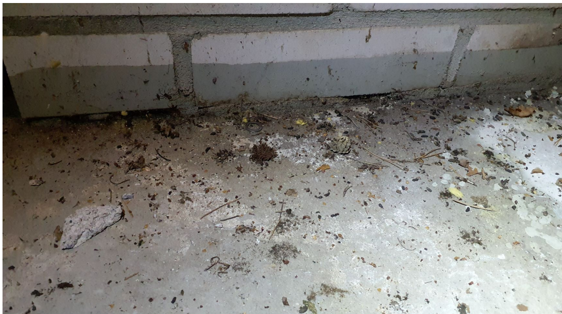
Kuva 13. Eri ikäisiä lepakon papanoita asuntola 3:n ullakon lattian ja seinän rajassa.
