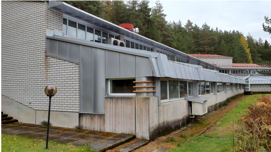
Kuva 1. Opetusmeijerin molempien siipien katto ja räystääiden reunukset on verhottu peltikatteella. Seinissä on tiiliverhous. Ulkoarvio: Heikko
