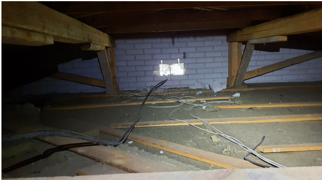
Kuva 10. Asuntola 2 välikaton tila pohjoispäädyssä. Tuuletusritilän lähistöltä löytyi kaksi ulostekeräytymää.
