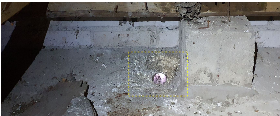
Kuva 7. Koulun päärakennuksen keskiosan ja itäisen puolen ullakon lattian rajassa on talon seinän läpäiseviä tuuletusaukkoja.
