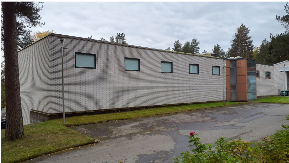
Kuva 2. Meijerikoulun liikuntasalissa on tiivis rakenne ja huopakatolla olevat ilmastointikanavat on suojattu metallisäleiköllä. Ulkoarvio: Heikko
