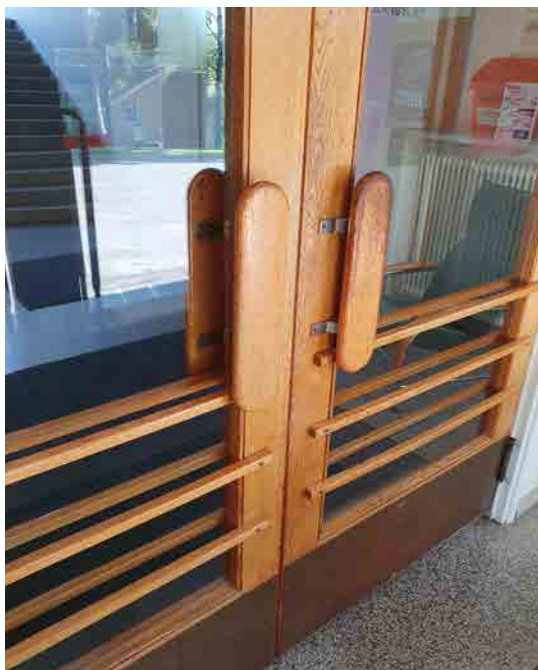
Kuva 150: Aulan tuulikaapin ovina ovat tammipuiset heiluriovet.
