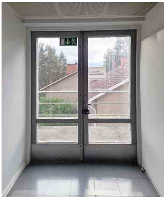
Kuva 234: Käytävän hätäuloskäynnin ovi.
