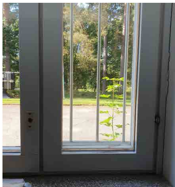
Kuva 155: Osaan luokkahuoneiden ikkunoista on asennettu 2000 -luvulla kaltereita murtautumisten ehkäisemiseksi. 24
