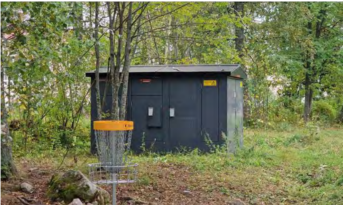
Kuva 18. Puistoalueella sijaitseva muuntamorakennus.
