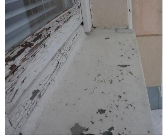
Alkuperäisiä ikkunoita ei ole huollettu ja niiden kunto on huono
