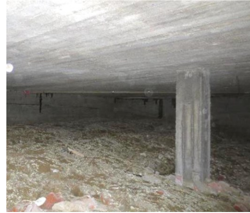
Tuulettuvan alapohjan maa-aines oli silmin havaittavasti mikrobikasvuston peitossa.
