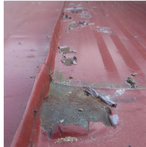
Rakennuksen C-osalla oli havaittu pistekorroosiota ja tilanne vaatisi nopeaa korjaamista.
