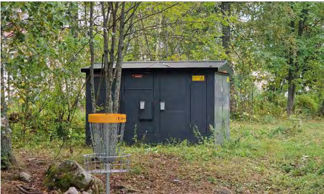
Kuva 18. Puistoalueella sijaitseva muuntamorakennus.
