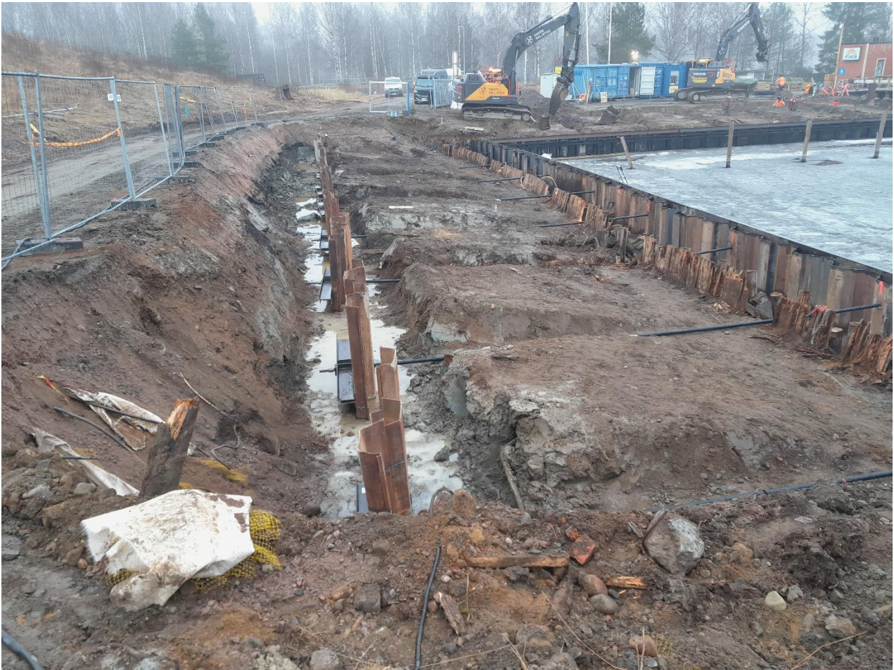
Kuva 6. B-jakso massojen leikkaamisen jälkeen. Kuvassa ponttiseinä, vastapontit sekä niitä yhdistävät GEWI-ankkuritangot ovat jo asennettuina. (Taratest Oy, 2.3.2026)
