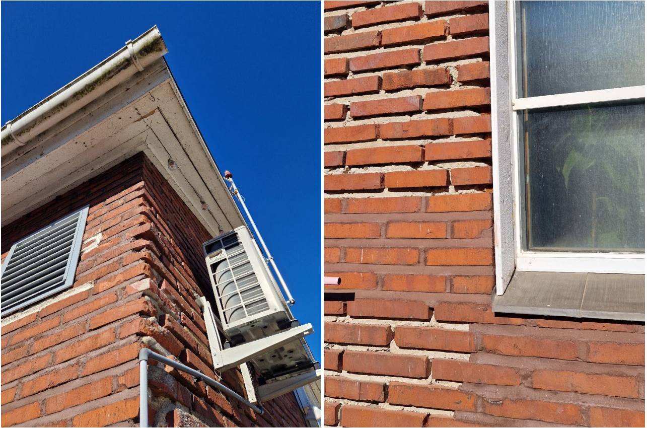
Kuva 80 (vasemmalla). Rakennuksen länsinurkka. Kuvassa näkyy ilmanvaihtoon liittyvä läpivienti ja muuta talotekniikkaa, jota rakennukseen on lisätty käyttötarkoituksen muutoksen yhteydessä.
